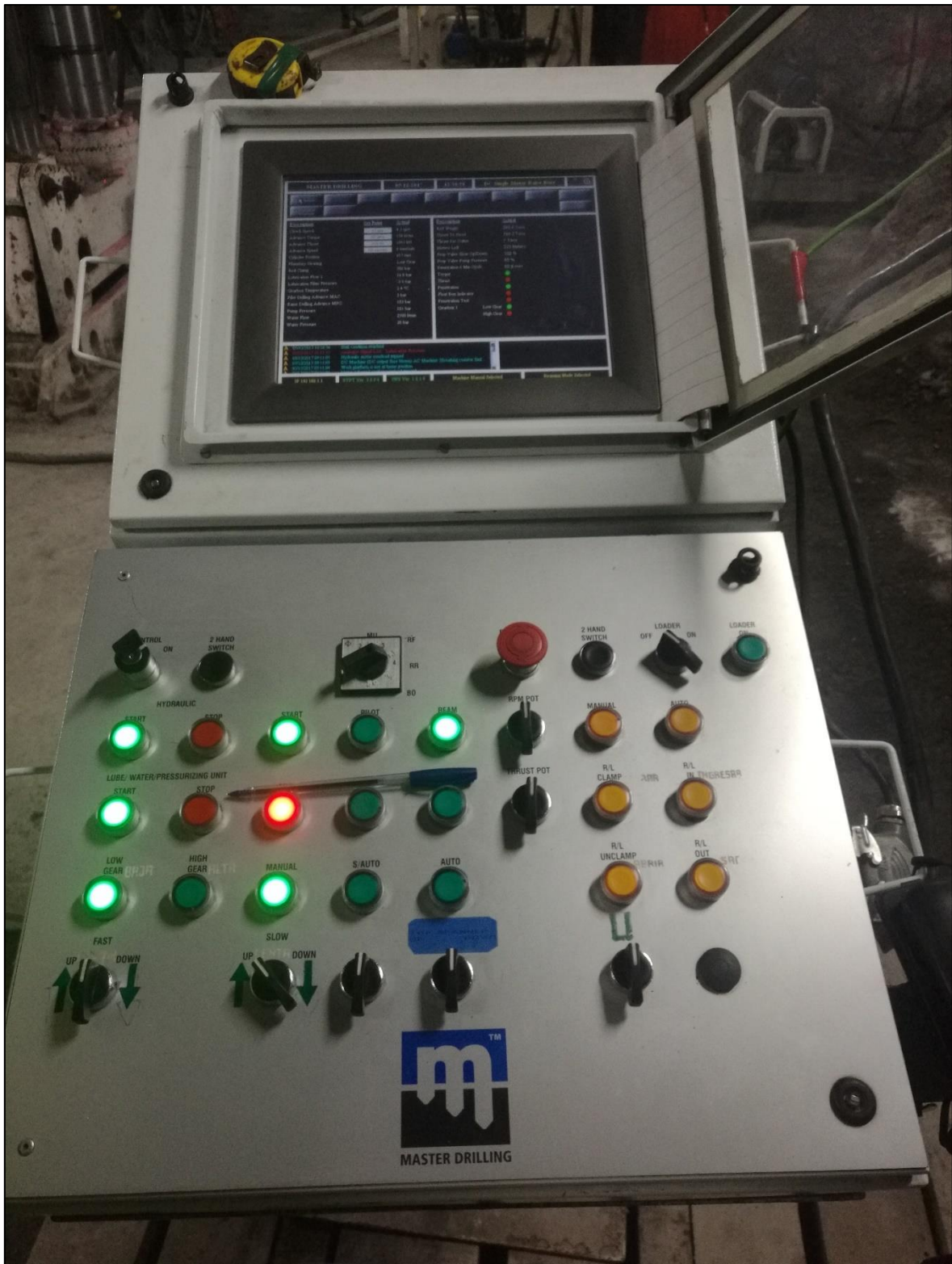
Foto 5.1. Vista del tablero de control panel (pantalla y botoneras).
