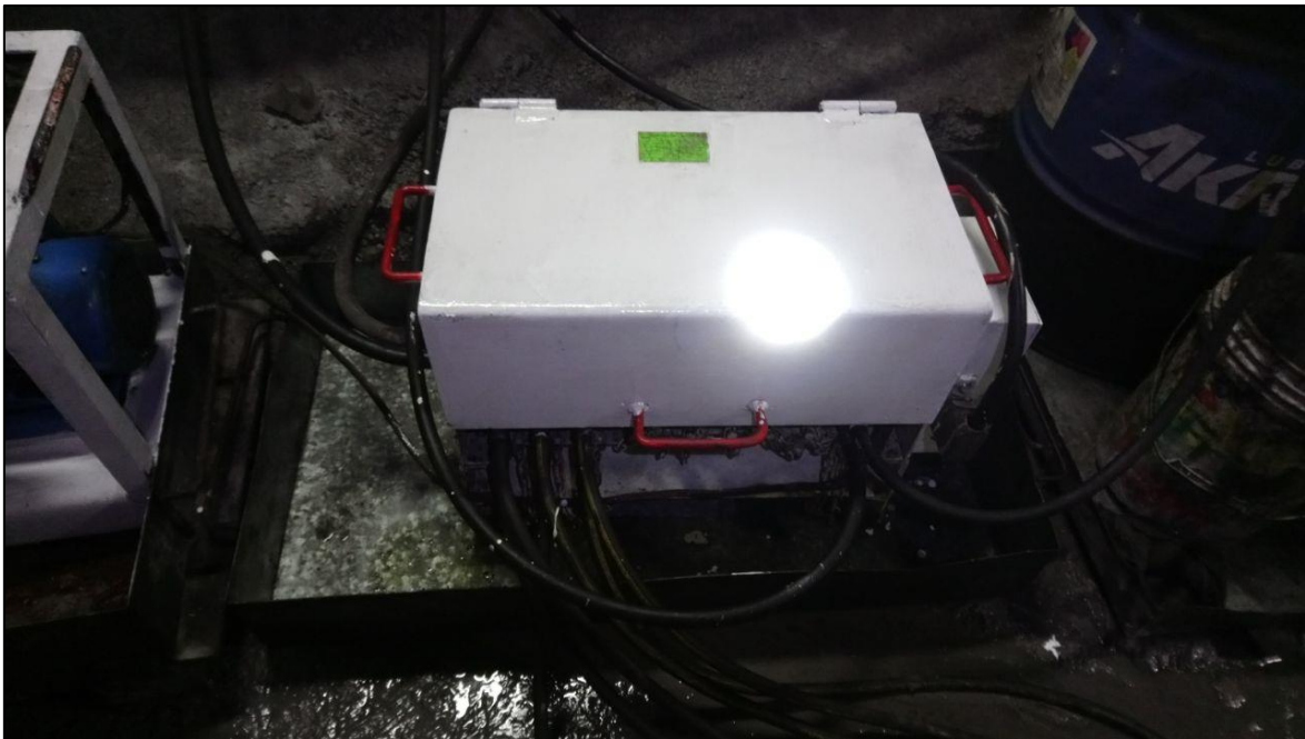
Foto 3.3. Foto del block de valvulas del brazo hidráulico de perforación Raise Borer.
