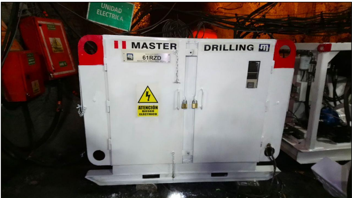
Foto 2.1. Foto de la Unidad Eléctrica de perforación Raise Borer.
