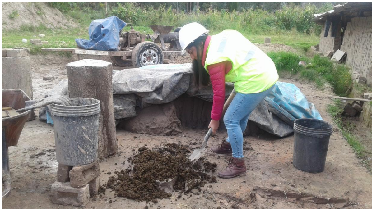
Fotografía N° 7: Mezcla de estiércol de caballo y barro para la fabricación del adobe.
