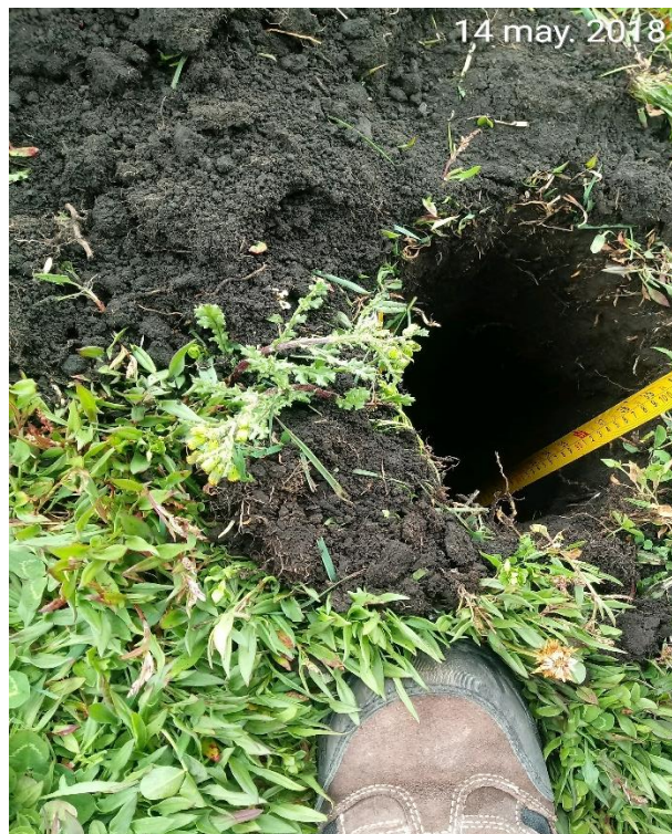
Figura 3. Medición de 1 metro de profundidad del hueco en el cuál se colocará los postes.
