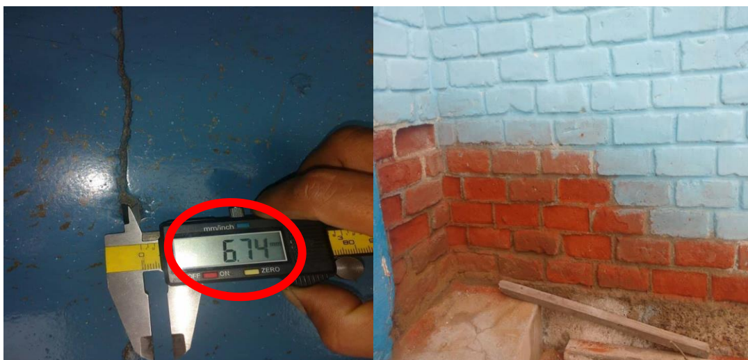
Figura N°34. Estado de conservación de la I.E. Liceo Trujillo
