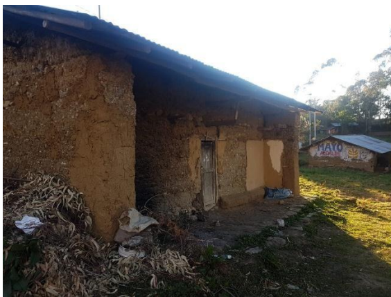
Construcción 01, mala calidad de muros, falta de elementos de arriostre
