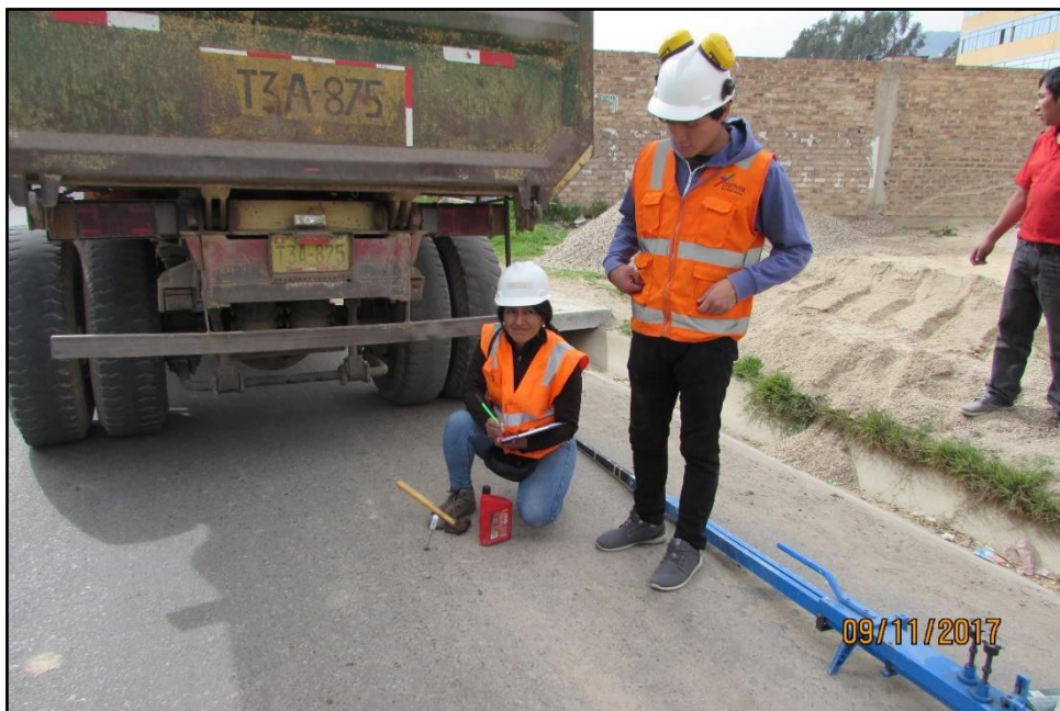
FIGURA N° 43: Se anotó las deflexiones en la progresiva km 000 + 050 m.
