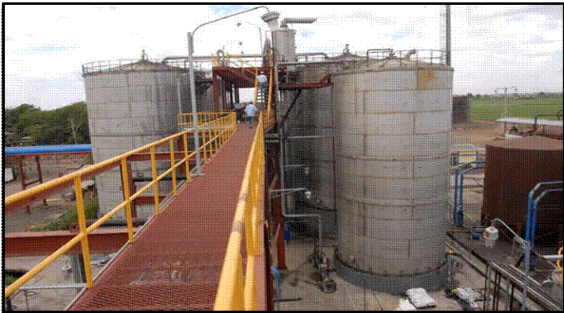
Figura 71 Reactor CSTR para el proceso de fermentación Fuente: Maple (2010)
