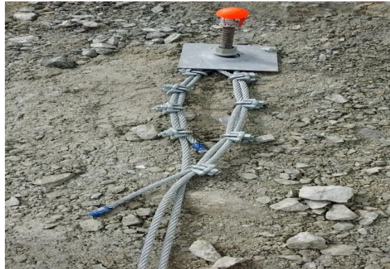
Cable de Línea de vida anclada a perno para Línea de vida
