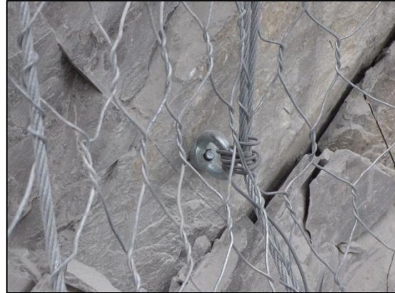
Colocación de pernos expansivos de 4” para pegar la malla al relieve de la roca
