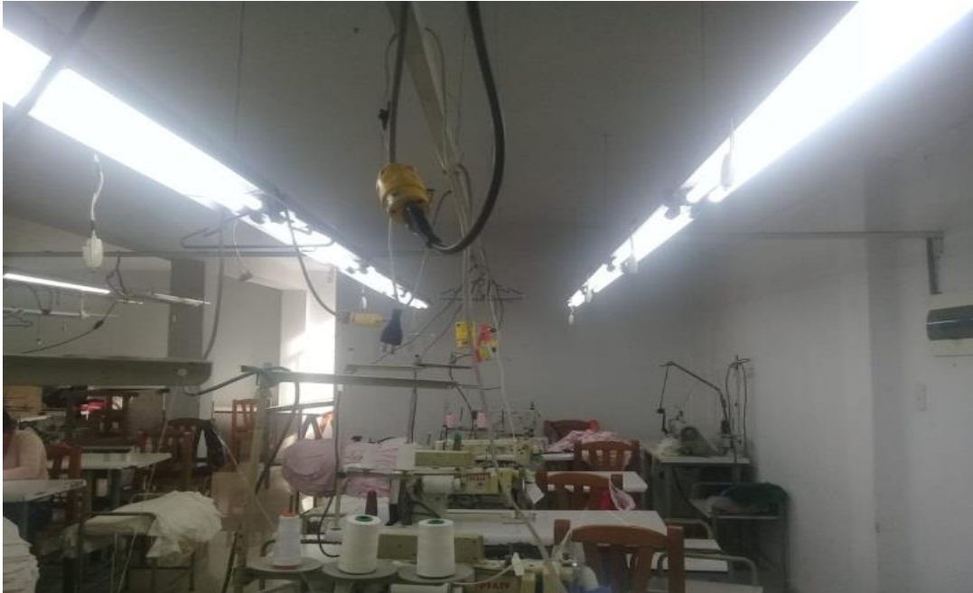
Figura N° 3.10 – Iluminación de Líneas de Producción
