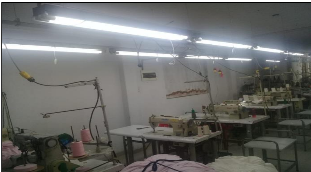
Figura N° 3.9 – Iluminación de Líneas de Producción
