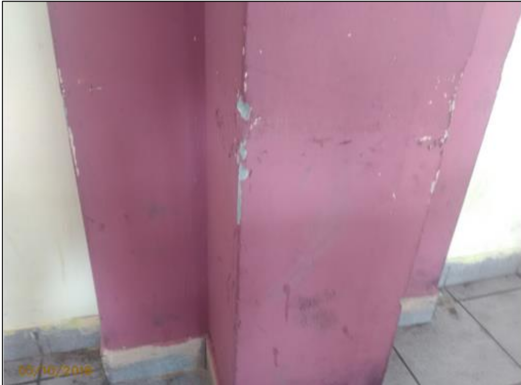
Figura 95. Módulo 01: 3° piso columna "T" con desprendimiento del tarrajeo en el eje 9-9 intersección con el eje "B".
