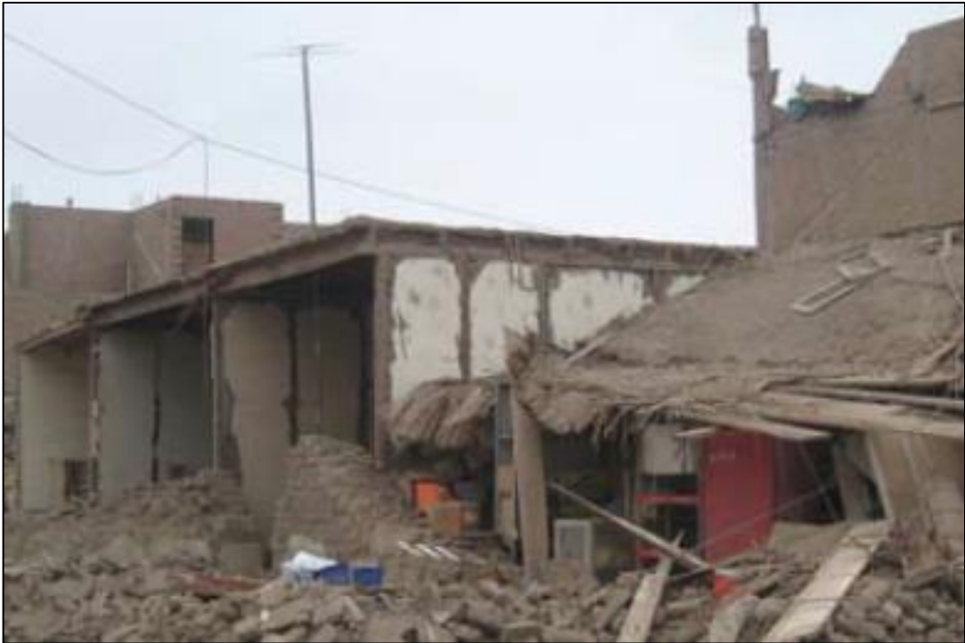
Figura 3. Dos casas de adobe afectadas por el terremoto de pisco. EERI (2007).
