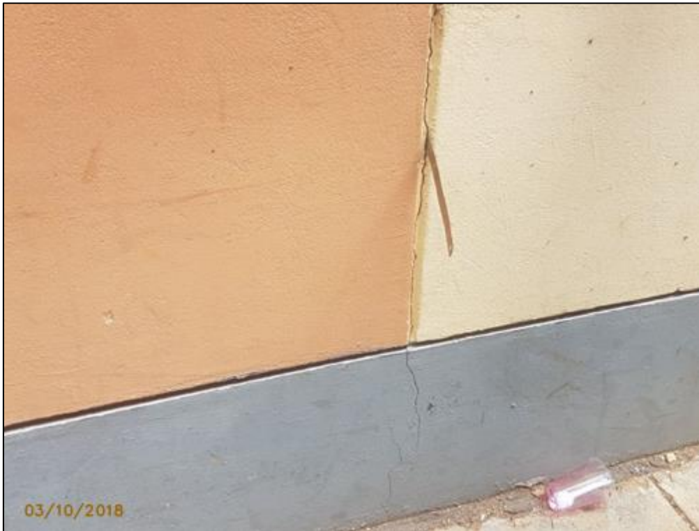
Figura 91. Módulo 01: 1º, 2º y 3º piso, presencia de una fisura en la unión muro-columna en el eje A-A tramo del 4-10.
