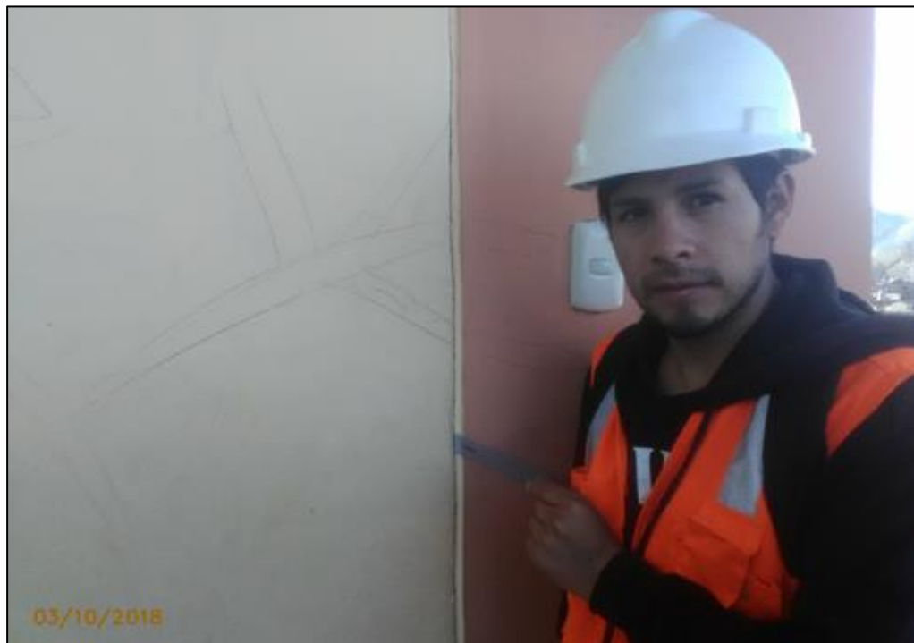
Figura 9. Presencia de una fisura vertical en la unión muro-columna.
