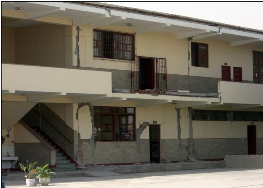
Figura 2. Colegio Humboldt, daños sufridos después del terremoto de pisco (2007). www.colegio-humboldt.edu.pe .
