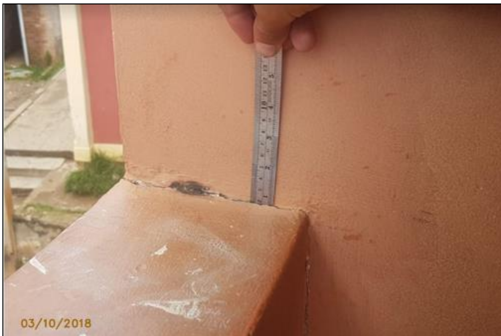
Figura 100. Módulo 02: 1º, 2º y 3º piso, presencia de una grieta en la unión del muro del voladizo en el eje F-F tramo voladizo.
