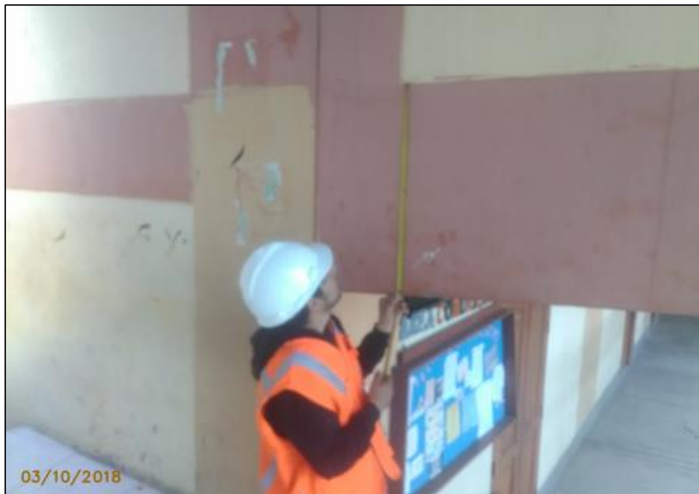
Figura 11. Tomando medidas del peralte de una viga en voladizo para su posterior verificación.
