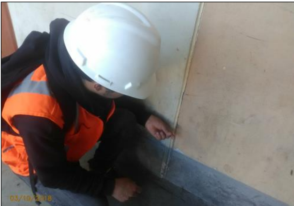
Figura 92. Módulo 01: 1º, 2º y 3º piso, presencia de una fisura en la unión muro-columna en el eje B-B tramo del 4-10.
