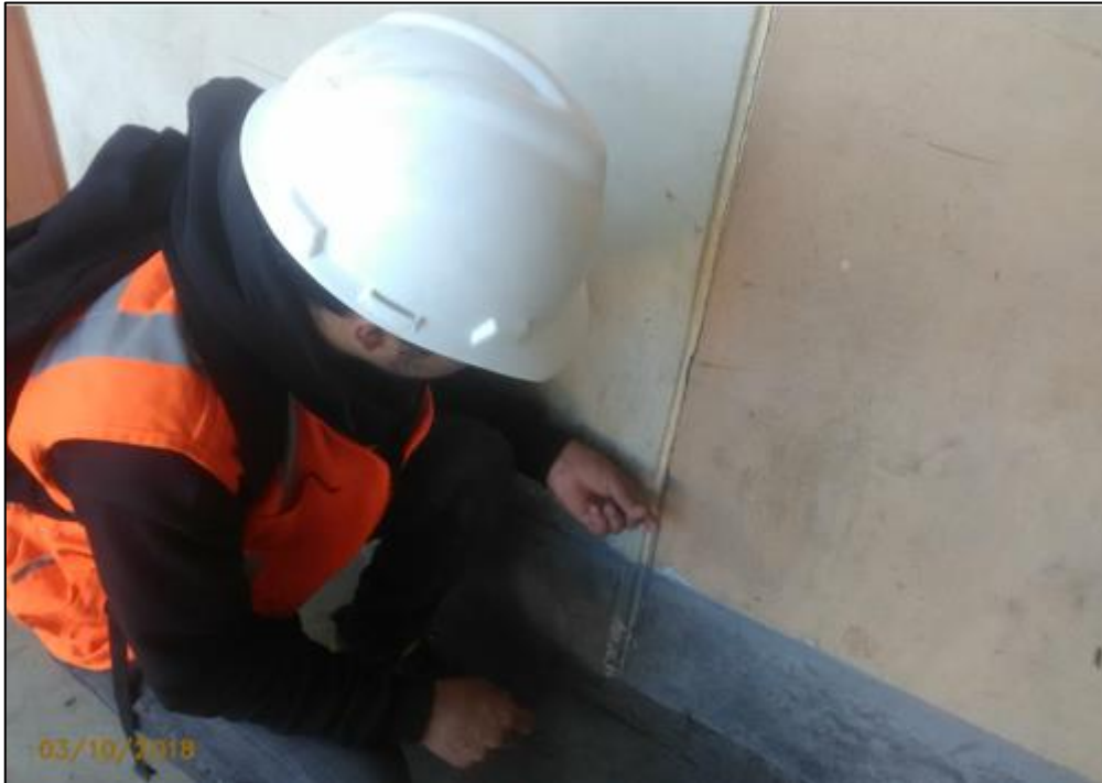
Figura 99. Módulo 02: 1º, 2º y 3º piso, presencia de una fisura en la unión del muro-columna en el eje 2-2 tramo D-F.
