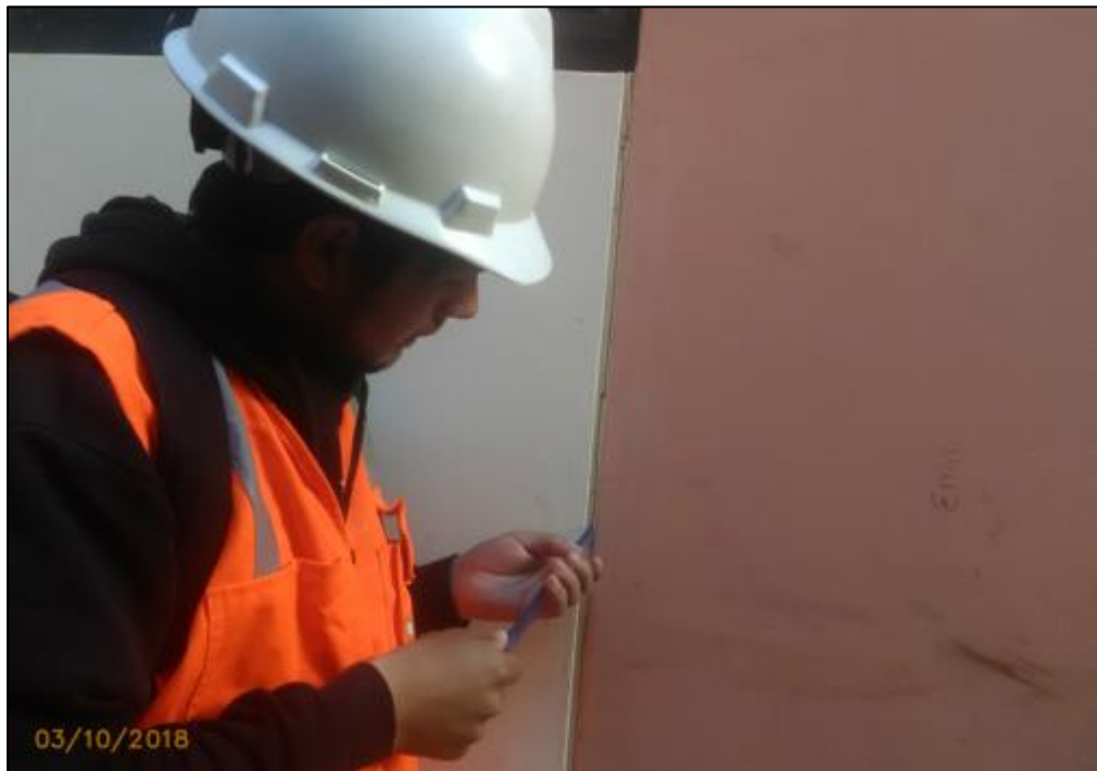
Figura 98. Módulo 02: 1°, 2° y 3° piso, presencia de una fisura en la unión del muro-columna en el eje 1-1 tramo A-F.
