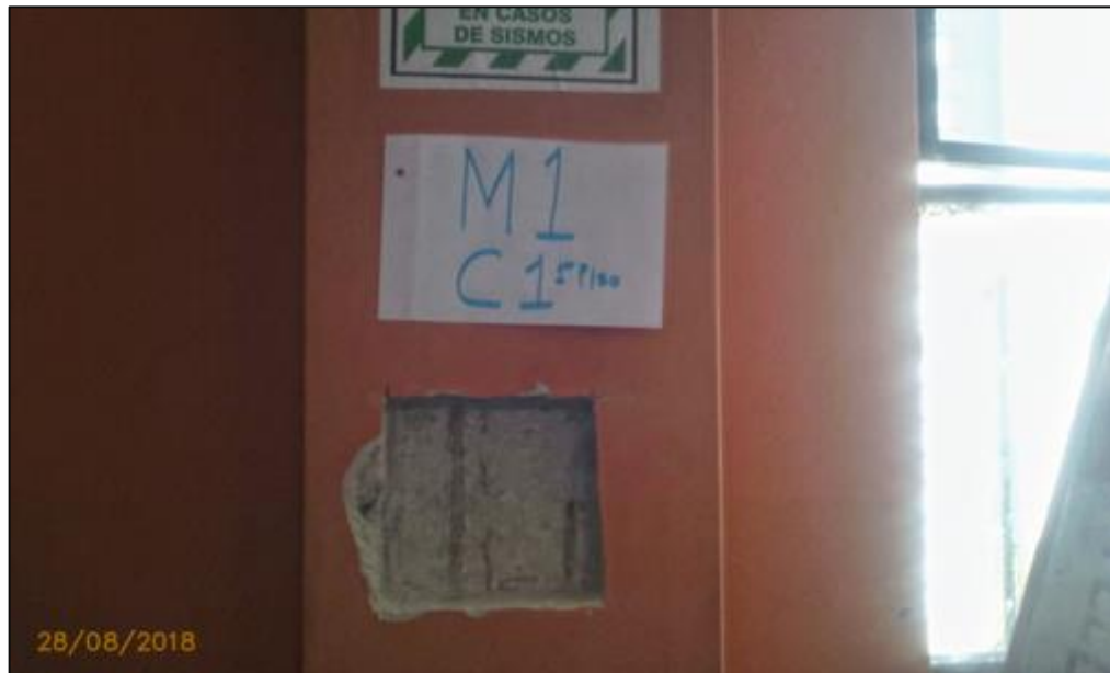
Figura 15. Descubrimiento del tarrajeo en un área de 15 \times 15 \text{ cm}^2 de la C1 del módulo 01 (Primer Piso).
