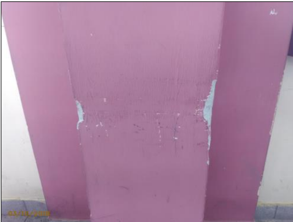
Figura 94. Módulo 01: 3° piso columna "T" con desprendimiento del tarrajeo en el eje 8-8 intersección con el eje "A".
