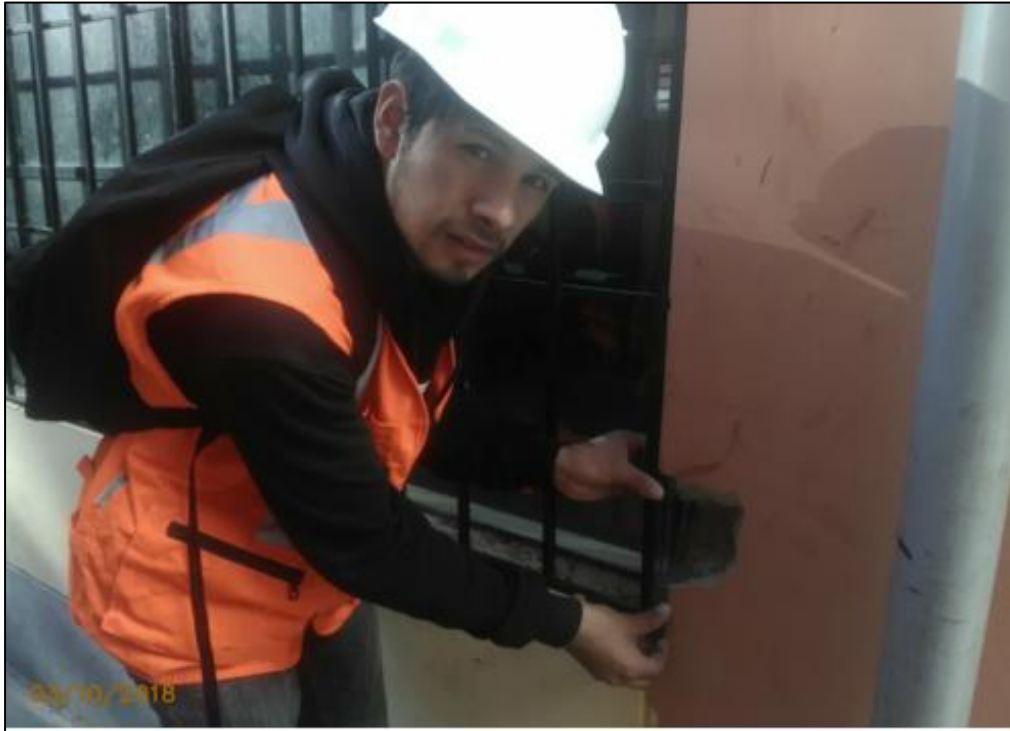
Figura 97. Módulo 02: 1° piso columna “L” con desprendimiento del tarrajeo en el eje 1-1 intersección con el eje “F”.
