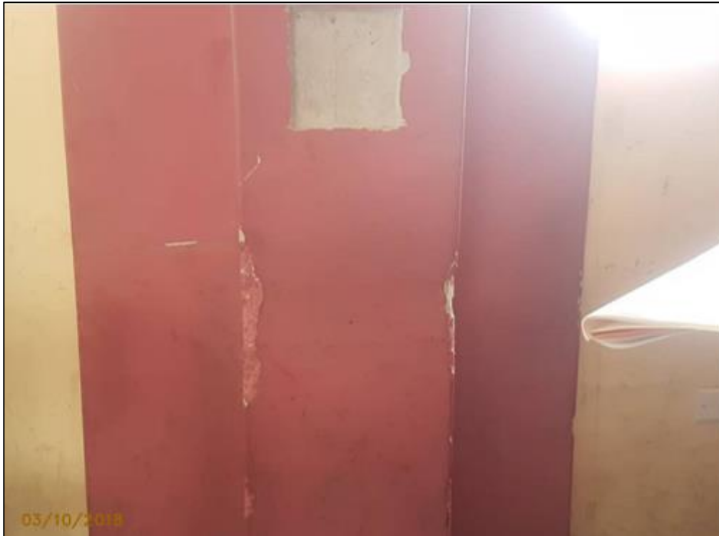
Figura 93. Módulo 01: 2° piso columna "T" con desprendimiento del tarrajeo en el eje A-A intersección con el eje "5".
