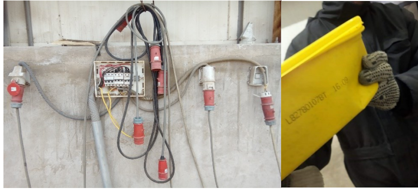
Ilustración 5 Conectores y cajas malogrados. Por NORDIGESA.
