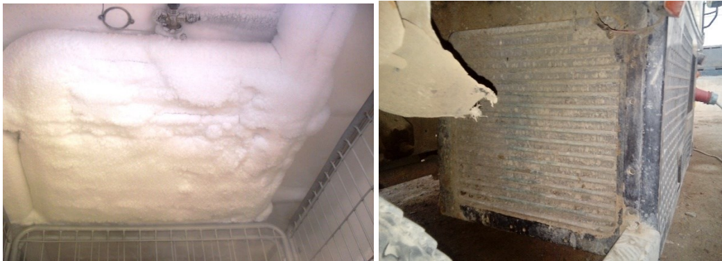
Ilustración 8 Falta de limpieza en los equipos. Por NORDIGESA.
