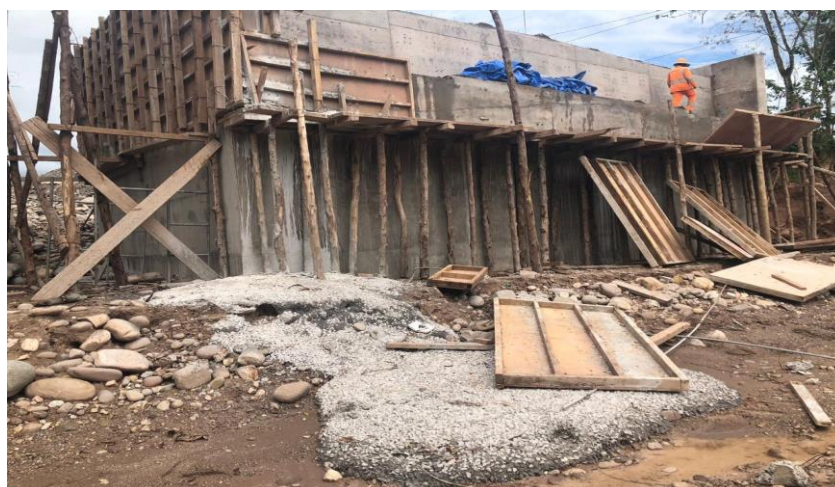
Figura n.º 27 Colapso de encofrado por mal amarre
