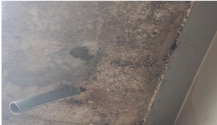
Figura n.º 24 Cangrejas en el concreto luego del desencofrado
