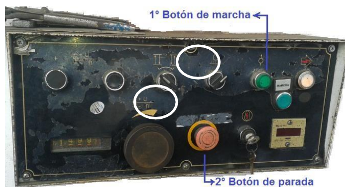
FIGURA 1: TABLERO DE MANDO DE LA CIZALLADORA.
