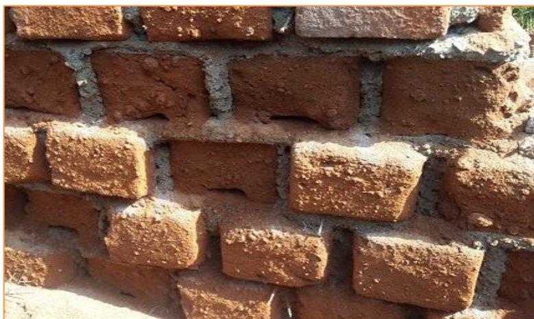
Figura 17. Muro de albañilería con presencia de criptoflorescencia.
