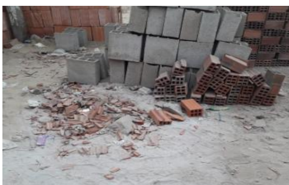
Figura 9: Ladrillos rotos (Desmedros)
