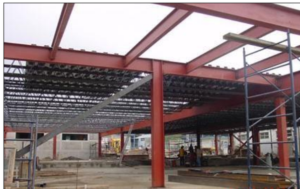
Figura 6. Perfil HEB utilizado como soporte para un edificio metálico. Perfil HEB utilizado como soporte para un edificio metálico.
