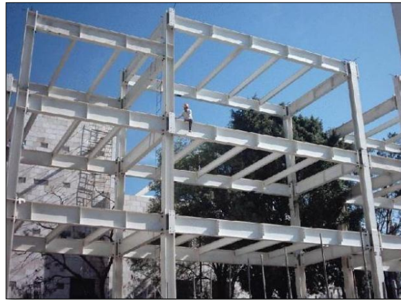
Figura 7. Perfil IPE utilizado como viga principal de los pórticos en edificio metálico.
