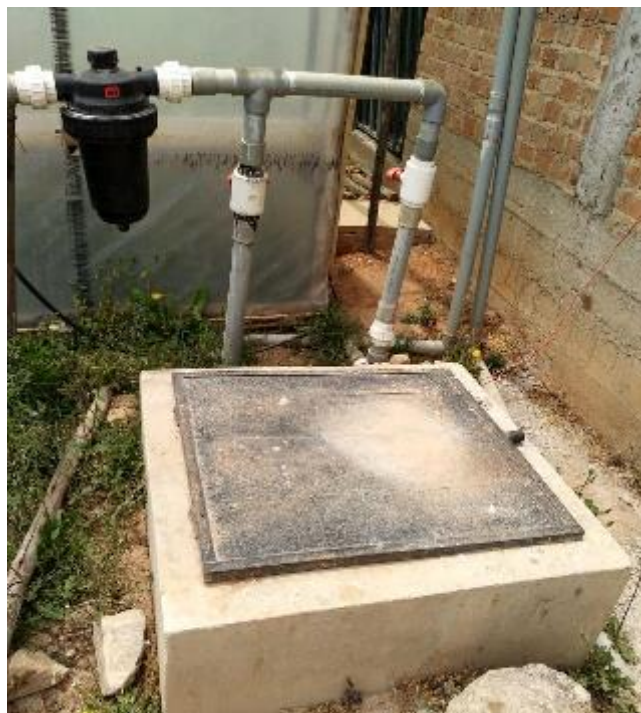
Figura 17: Pozo de captación de agua subterránea para el riego únicamente de las plantaciones de arándanos.
