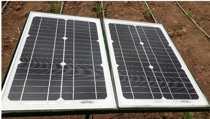
Figura 60: Generador de energía solar en funcionamiento. Fuente: Elaboración propia
