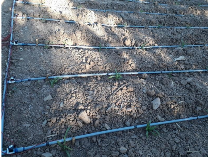
Figura 64: Sistema de tuberías con electroválvulas en funcionamiento Fuente: Elaboración propia
