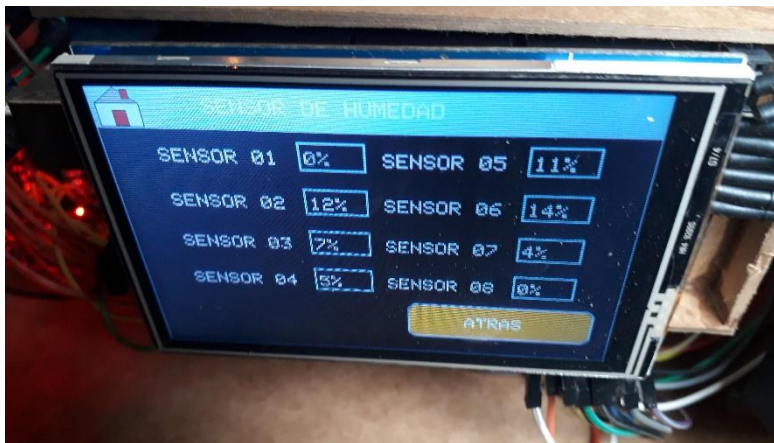
Figura 62: Datos de los sensores en el módulo de control Fuente: Elaboración propia
