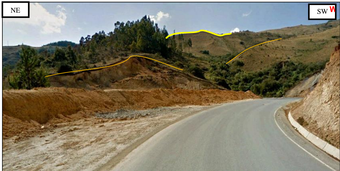
Figura 16: Ladera formada al margen izquierdo de la carretera. N: 9220430 E: 746711 Fuente: Elaboración propia.
