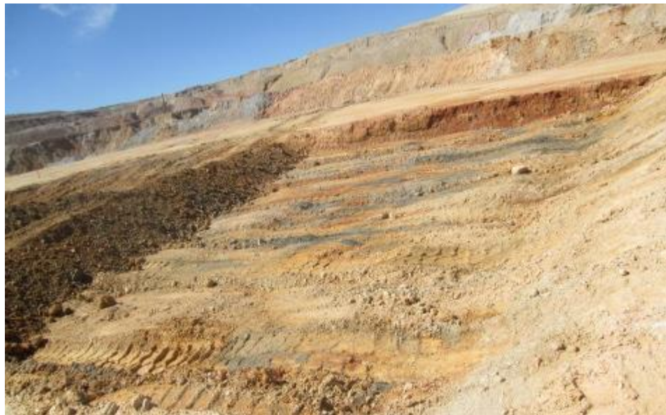
Foto 10. Piso compacto por el tránsito de equipos gigantes en un lift en la etapa 2
