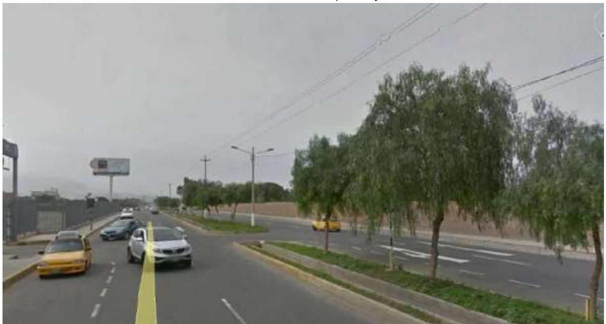
IMAGEN N° 45: Estado de pistas y veredas
