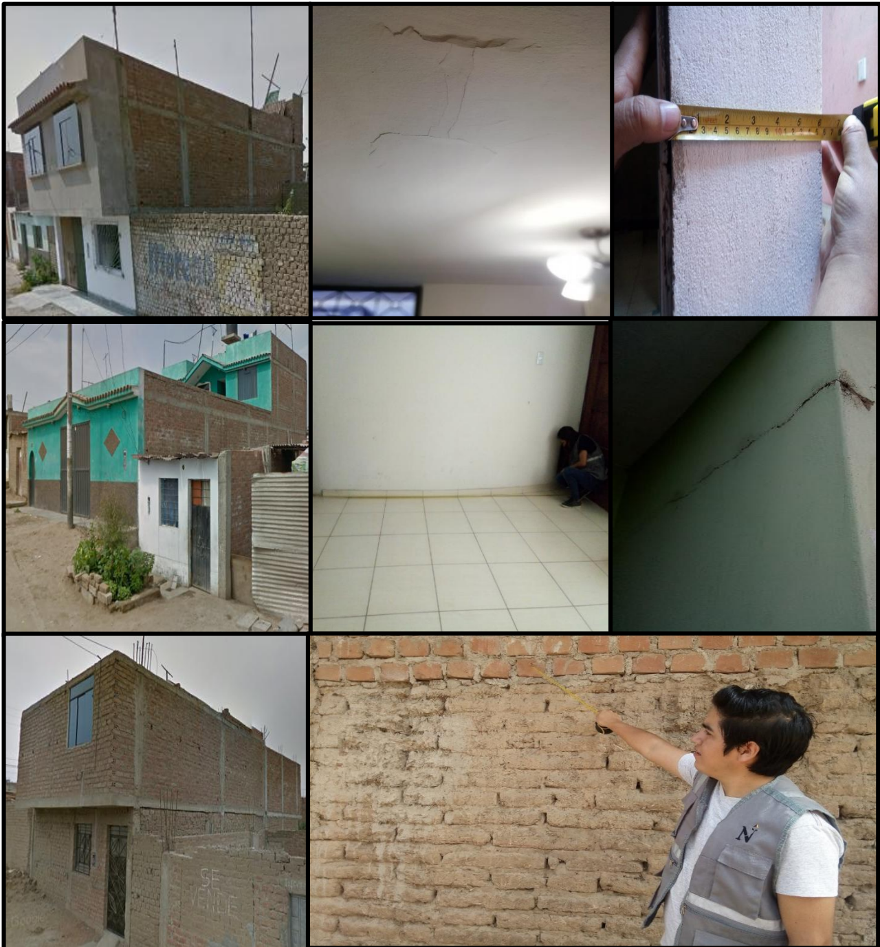
Figura 48: Viviendas seleccionadas de la tipología III, patologías y fallas encontradas en las viviendas Fuente: Elaboración Propia
