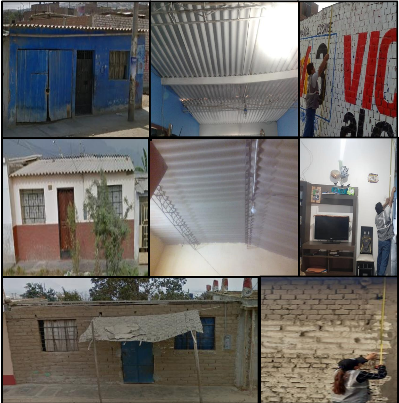
Figura 49: Viviendas seleccionadas de la tipología VIII, patologías y fallas encontradas en las viviendas
