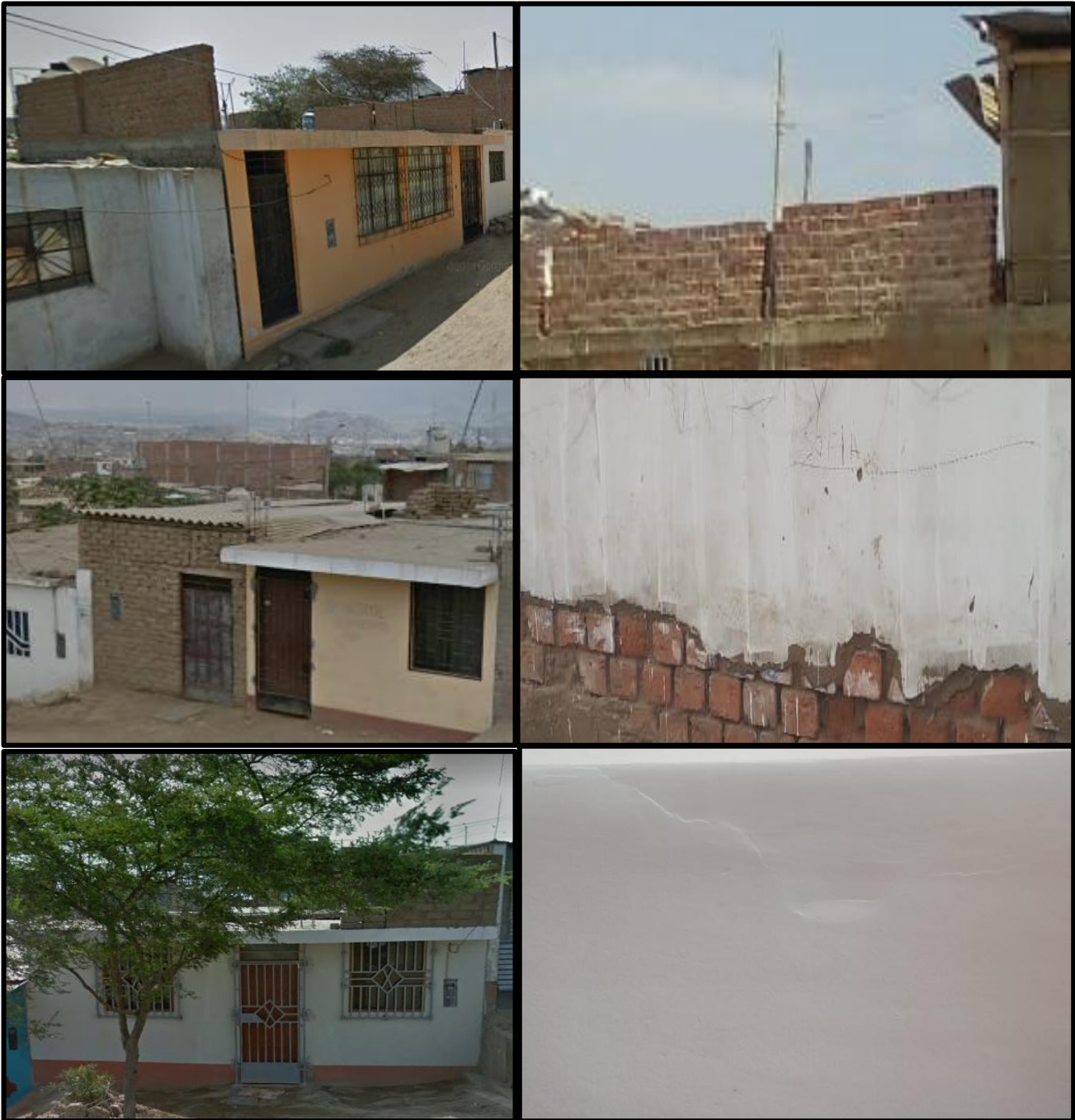
Figura 47: Viviendas seleccionadas de la tipología II, patologías y fallas encontradas en las viviendas
