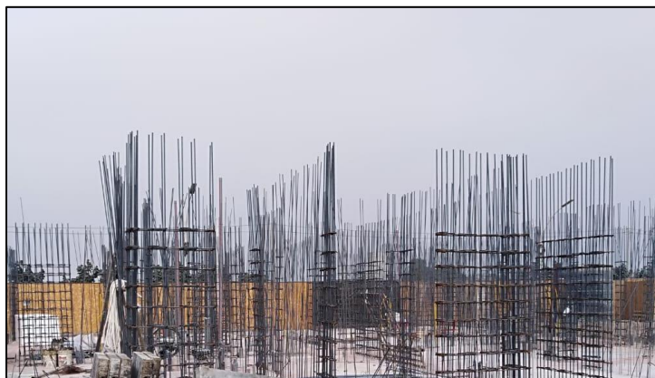
Figura 2. Colocación de acero para muros en obra Ciudad Sol de Retablo - Comas
