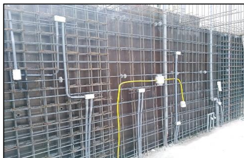
Figura 5. Instalaciones de agua, desagüe, luz y gas en obra Ciudad Sol de Retablo
