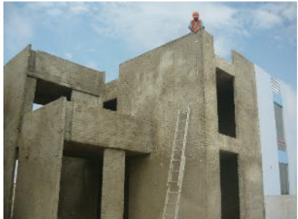
Vista del casco del primer y segundo nivel inyectado de la vivienda del sistema Emmedue-Las Terrazas de Huanchaco.
