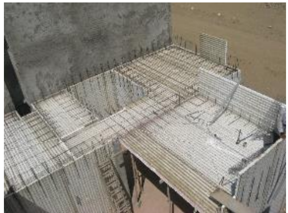
Losa de entrepiso de la vivienda de Emmedue - Las Terrazas de Huanchaco
