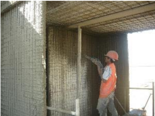
Inyección del mortero estructural en los muros del sistema Emmedue Las Terrazas de Huanchaco.
