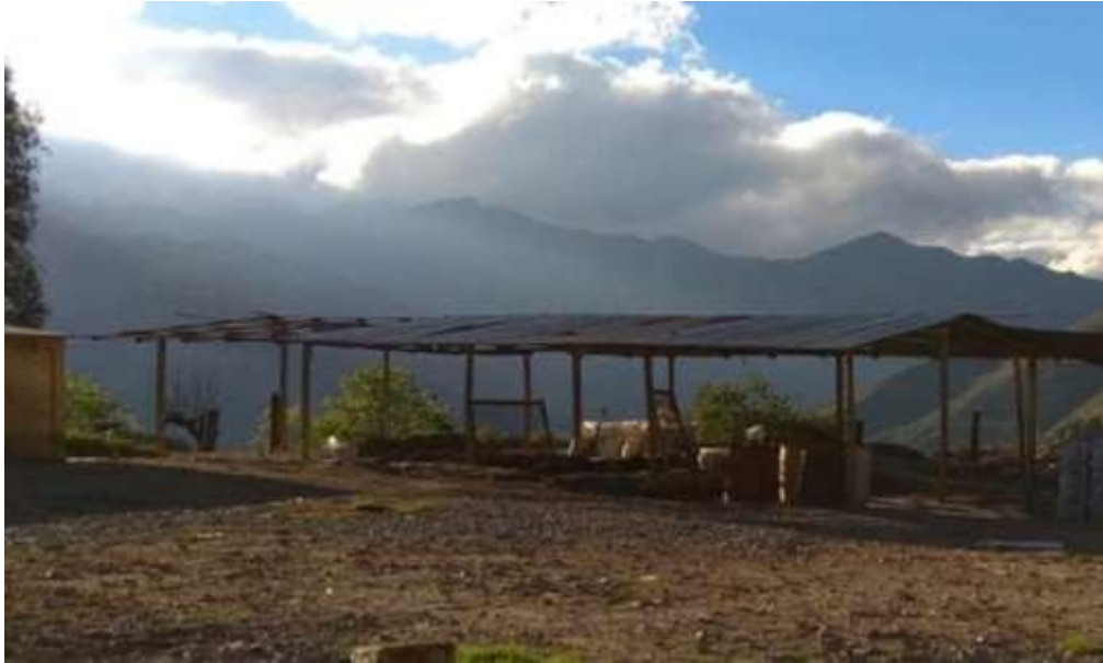
Fotografía 12: Centro de Acopio de la mina nivel 2, nueva esperanza trinidad. Fuente: Elaboración Propia.
