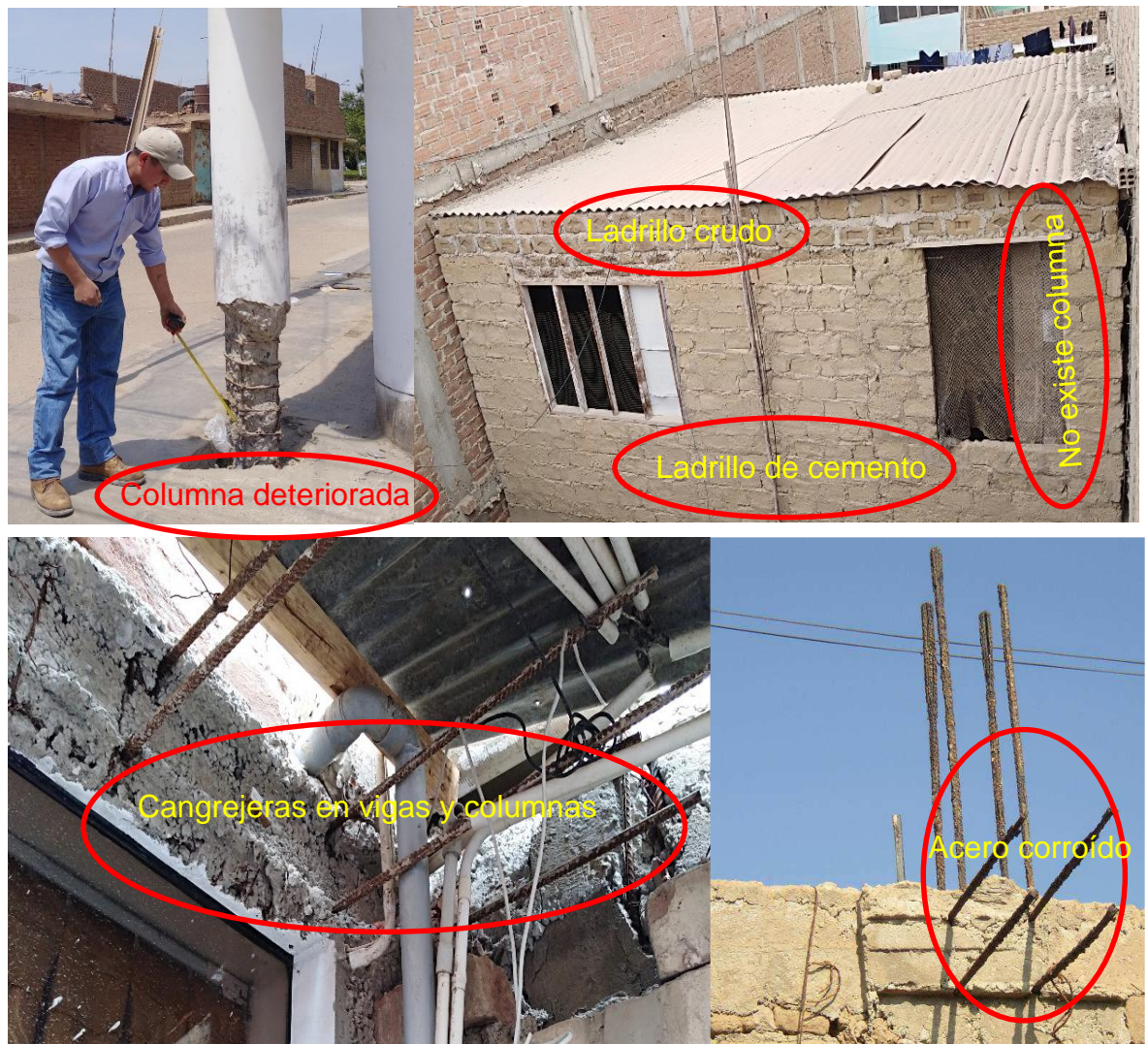
Ilustración 7: Verificación rápida por prospección simple de la situación de algunas edificaciones en el sector Manuel Arévalo.
