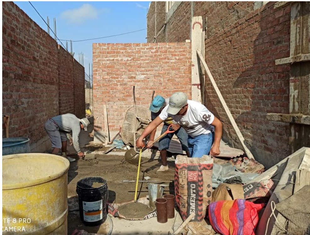
Foto. 5: Verificación de concreto fresco preparado manualmente para columnas, en primer nivel de vivienda.
