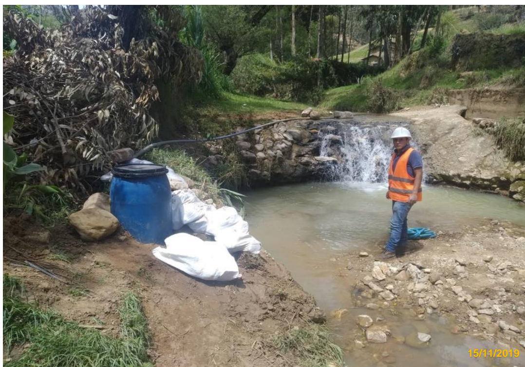
Figura 14. Filtro instalado y protegido.
