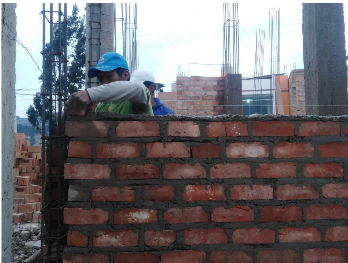
Figura 42. Se observa la actividad de colocación de mezcla en la vivienda N° 02.
