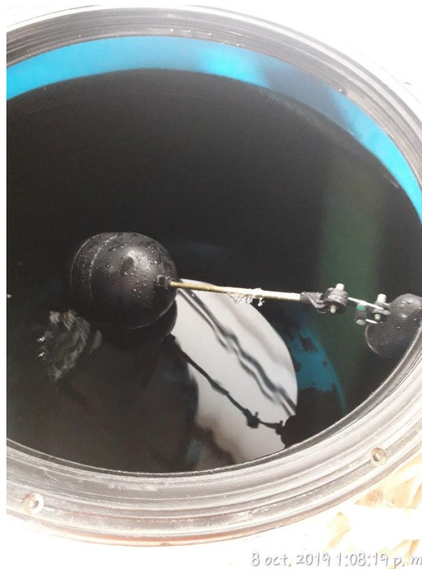
Figura 63. Se evidencia poca sedimentación en el interior del tanque, así como cierto grado de turbiedad en el agua. Correspondiente al puesto de la Sra. Delia Cerdán – Mercado Central
