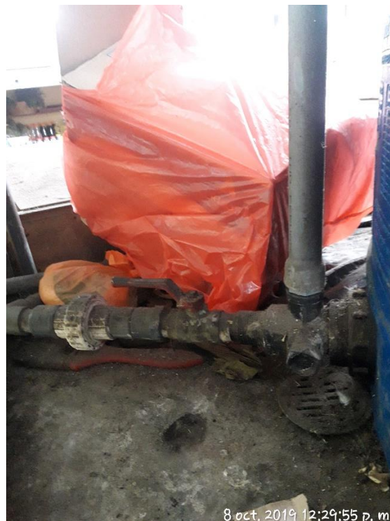
Figura 54. Instalación de tubería de salida de agua con mal estado de accesorios. Ausencia de válvula check y visor de agua defectuoso. Correspondiente al puesto 02 de la Sra. María Tafur Mosqueira – Mercado Central
