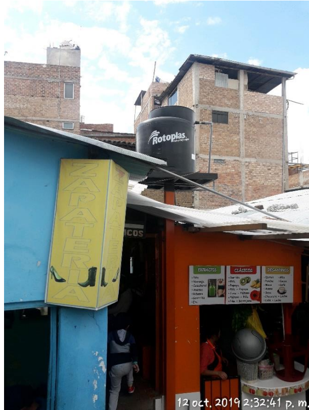
Figura 73. Difícil acceso al tanque de agua y espacio reducido para la O&M. No evidencia tubería de rebose ni de ventilación. Correspondiente al Sr. Royer Flores – Mercado San Sebastián
