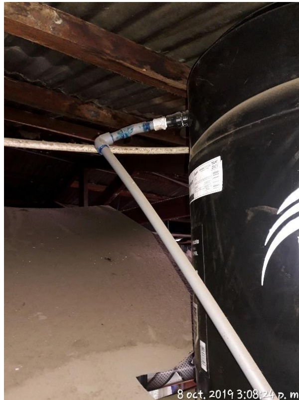
Figura 71. Falta de instalación de accesorios (válvulas check y cierre, tubo visor, llave universal). Correspondiente a la Sra. Alicia Minchán – Mercado San Sebastián
