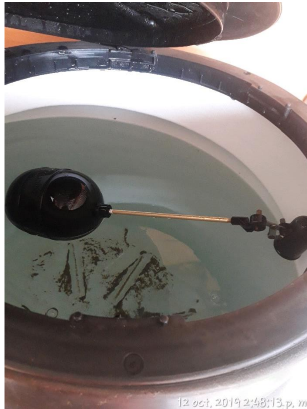
Figura 77. Se aprecia sedimentación en el interior del tanque y presencia de insectos. Correspondiente al Sr. Carlos Rojas – Mercado San Sebastián
