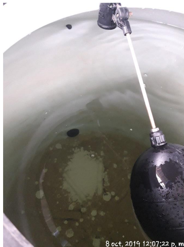
Figura 50. Interior del tanque de almacenamiento con abundante sedimentación, correspondiente al puesto 01 de la Sra. María Tafur Mosqueira – Mercado Central
