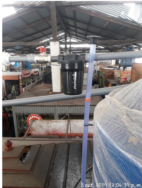
Figura 48. Correcta instalación de accesorios en la entrada de agua al tanque elevado, correspondiente al puesto 01 de la Sra. María Tafur Mosqueira – Mercado Central
