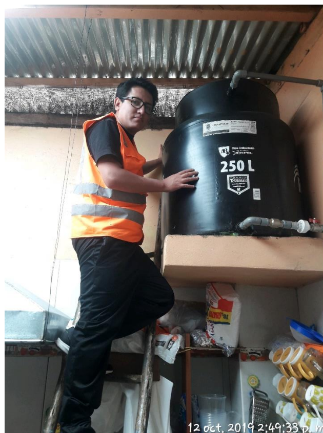
Figura 76. Ubicación de tanque elevado incorrecta. Se debe garantizar la presión de agua y espacio para la O&M. Correspondiente al Sr. Carlos Rojas – Mercado San Sebastián
