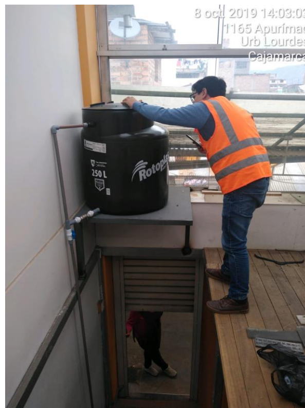
Figura 68. Inspección al tanque de agua. Se verifica falta de filtro de agua, tubería de rebose y ventilación y tubo visor de agua. Correspondiente a la Sra. María Huamán – Mercado Modelo
