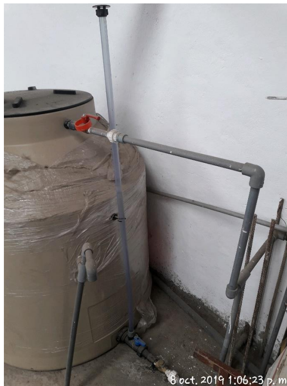
Figura 58. Instalación de accesorios adecuada. Ausencia de filtro de agua y válvula de cierre en la salida de agua. Falta de sujeción en la tubería de entrada. Correspondiente al puesto de la Sra. Elizabeth Sánchez – Mercado Central
