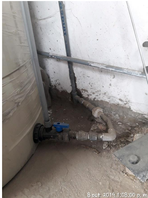
Figura 61. Instalación defectuosa en la salida de agua del tanque. Tubería de salida dañada. Ausencia de válvula check. Correspondiente al puesto de la Sra. Delia Cerdán – Mercado Central
