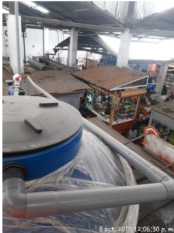
Figura 51. Tapa hermética bien colocada. Mala instalación de la tubería de rebose, con ausencia de tubería de ventilación. Correspondiente al puesto 01 de la Sra. María Tafur Mosqueira – Mercado Central
