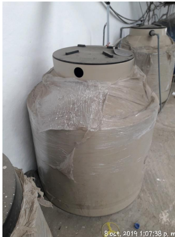
Figura 60. Se evidencia la ausencia de tubería de rebose y ventilación del sistema de almacenamiento. Tapa hermética correctamente colocada y en buen estado. Correspondiente al puesto de la Sra. Elizabeth Sánchez – Mercado Central
