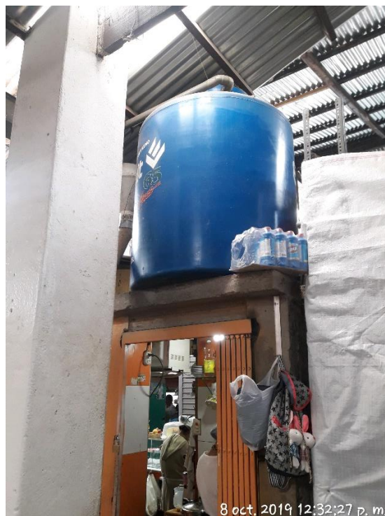
Figura 52. Mala ubicación del tanque elevado que no genera la presión suficiente de salida. No existe espacio adecuado para la O&M. Se observa una mala conexión en la tubería de rebose al desagüe. Correspondiente al puesto 02 de la Sra. María Tafur Mosqueira – Mercado Central
