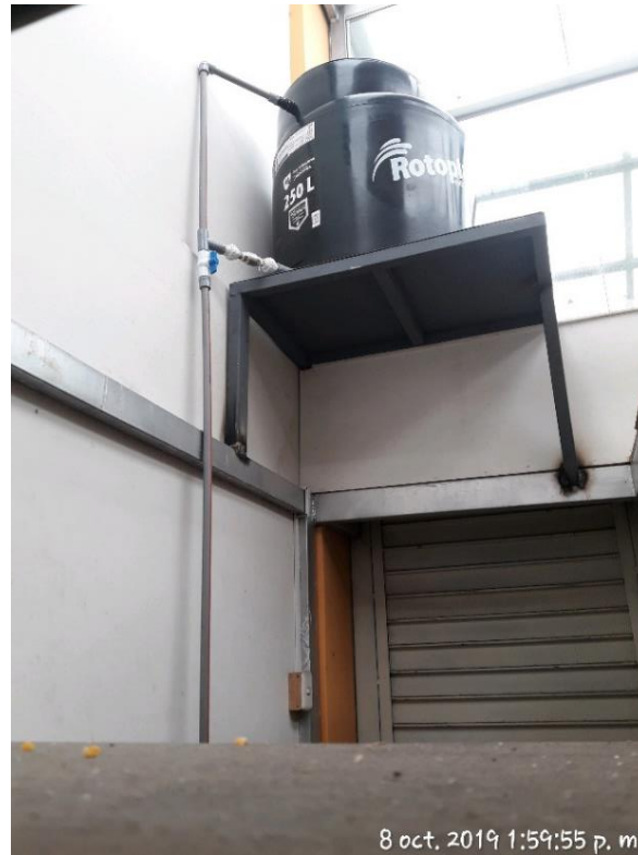
Figura 65. Ubicación del medidor adecuada, a dos metros del punto más desfavorable. Superficie adecuada para realizar la O&M. Correspondiente a la Sra. María Huamán – Mercado Modelo
