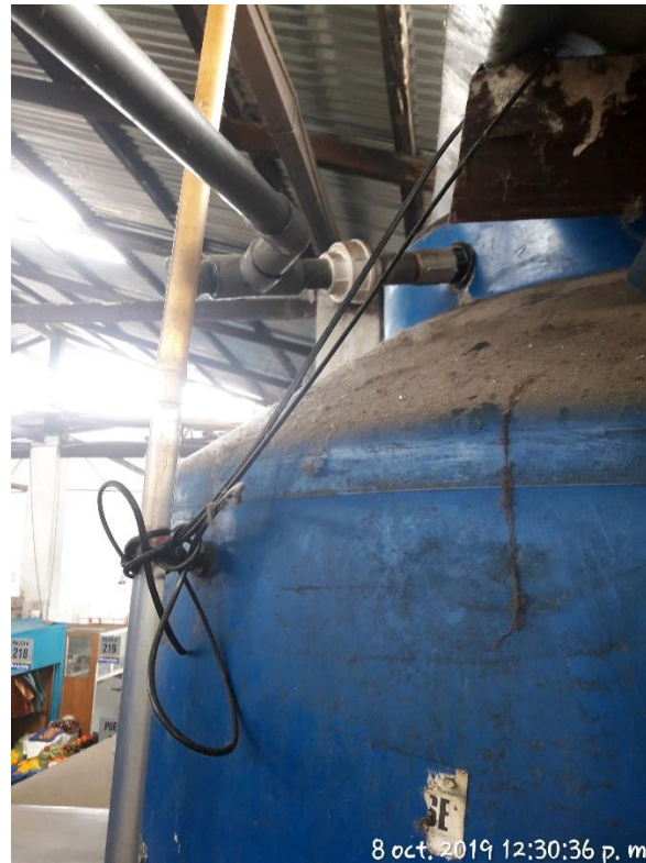
Figura 53. Instalación defectuosa de ingreso de agua. Falta de accesorios y mantenimiento. Presencia visible de suciedad y tapa hermética mal colocada. Correspondiente al puesto 02 de la Sra. María Tafur Mosqueira – Mercado Central
