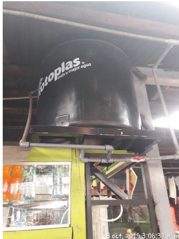
Figura 70. Ubicación inadecuada del tanque de almacenamiento que no permite la O&M y no garantiza la presión de agua. Correspondiente a la Sra. Alicia Minchán – Mercado San Sebastián
