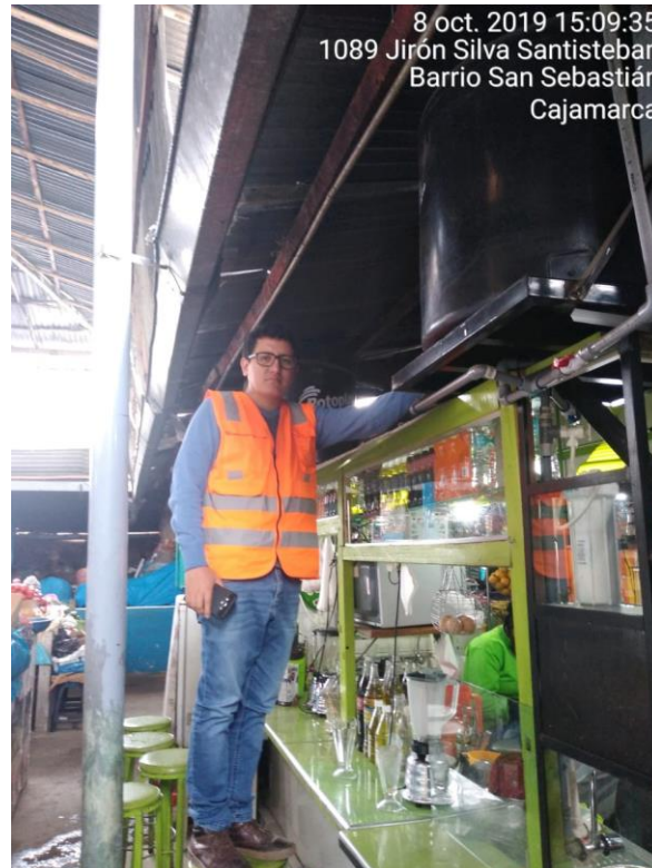
Figura 72. Se evidencia falta de tubería de rebose y ventilación en el sistema. Así como deterioro en las tuberías de alimentación y distribución del sistema. Correspondiente a la Sra. Alicia Minchán – Mercado San Sebastián
