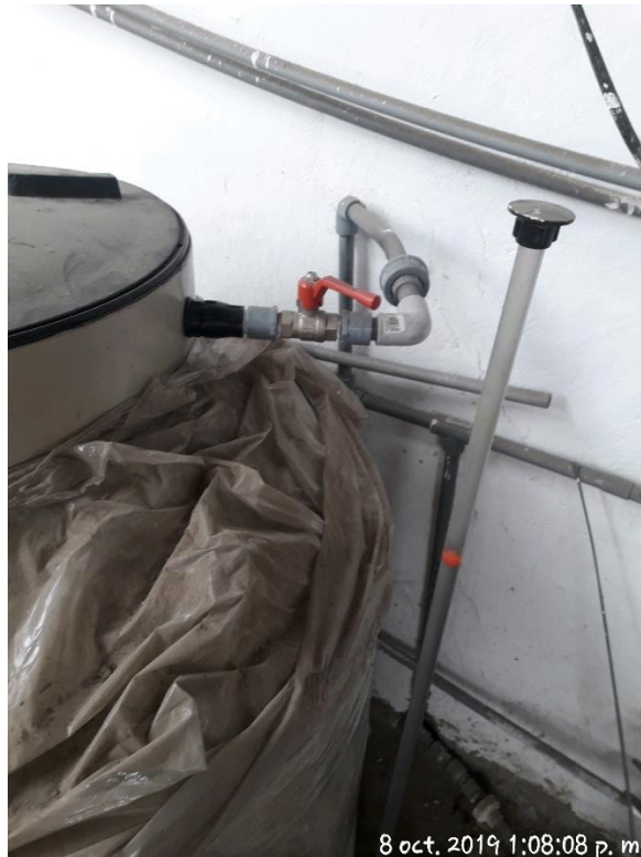
Figura 62. Ausencia de filtro de agua en la tubería de ingreso al tanque de almacenamiento. Falta de sujeción en la tubería de ingreso. Correspondiente al puesto de la Sra. Delia Cerdán – Mercado Central
