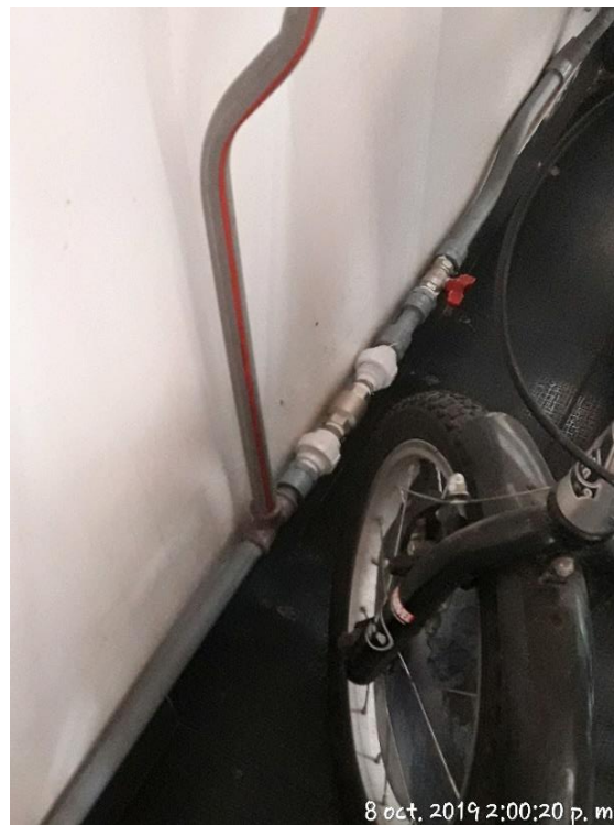
Figura 66. Tubería de impulsión hacia el tanque de agua defectuosa. Correspondiente a la Sra. María Huamán – Mercado Modelo
