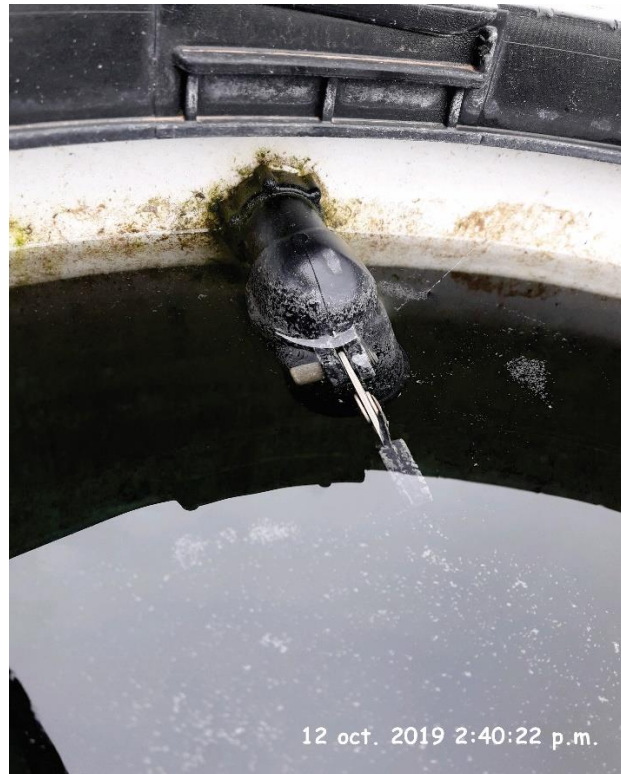
Figura 75. El interior del tanque presenta poca sedimentación y falta de mantenimiento. Falta de protección superior. Correspondiente al Sr. Royer Flores – Mercado San Sebastián
