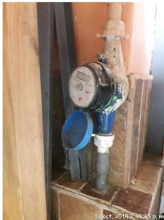
Figura 74. Ubicación del medidor de agua defectuosa. Correspondiente al Sr. Royer Flores – Mercado San Sebastián
