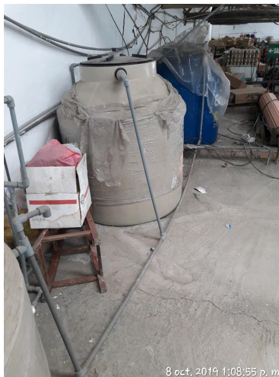
Figura 64. Tubería de rebose colocada de forma incorrecta. No existe conexión al desagüe, ni tubería de ventilación en el sistema. Correspondiente al puesto de la Sra. Delia Cerdán – Mercado Central
