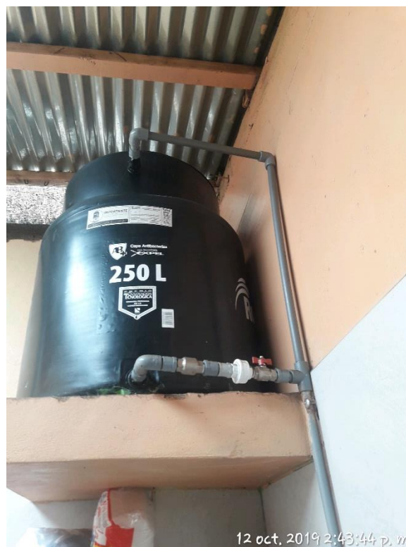
Figura 78. No se realizó la instalación de filtro de agua, tubo visor, tubería de desagüe, válvula de cierre, tubería de ventilación y llaves universales. Correspondiente al Sr. Carlos Rojas – Mercado San Sebastián
