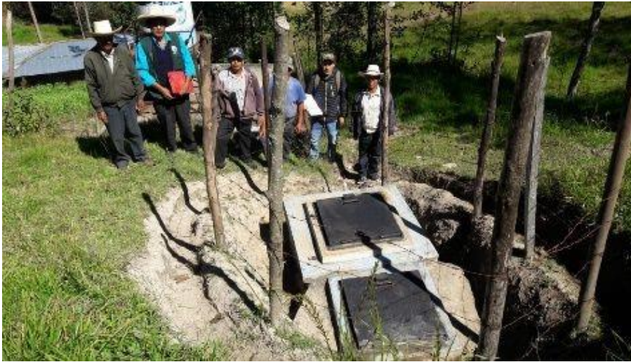
Cerco perimétrico en mal estado
