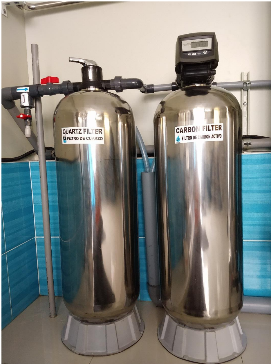
Figura 10 Primer proceso de filtración: filtro de cuarzo y carbón activado
