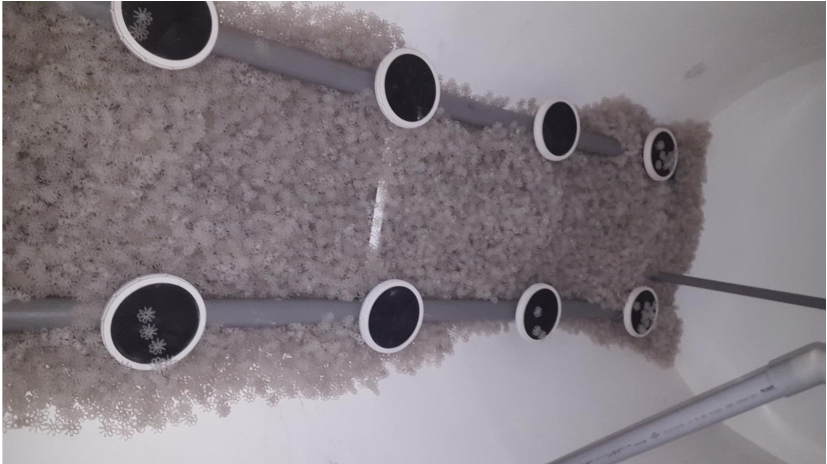
Sistema Reactor de Planta de Tratamiento de Agua Residual Doméstico (PTAD).
