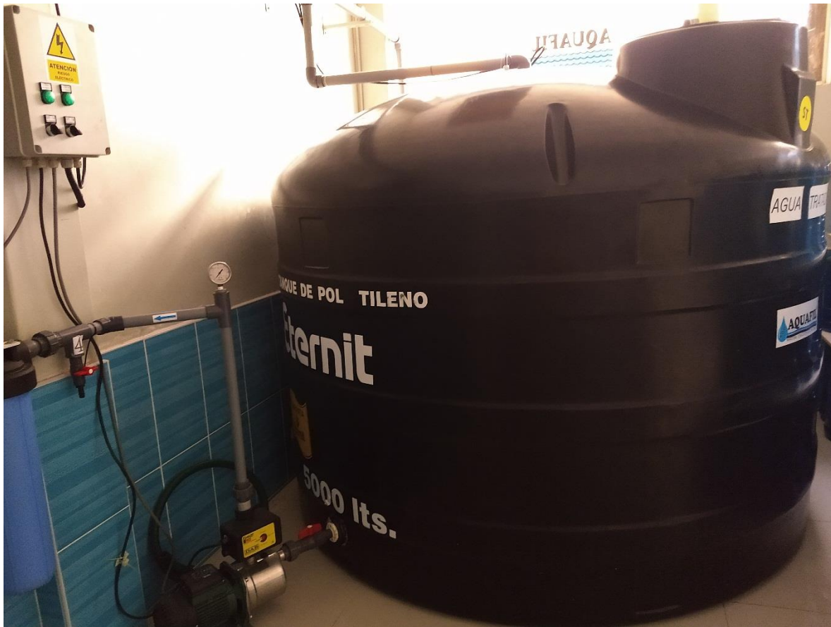
Figura 14 Tanque de almacenamiento de agua tratada
