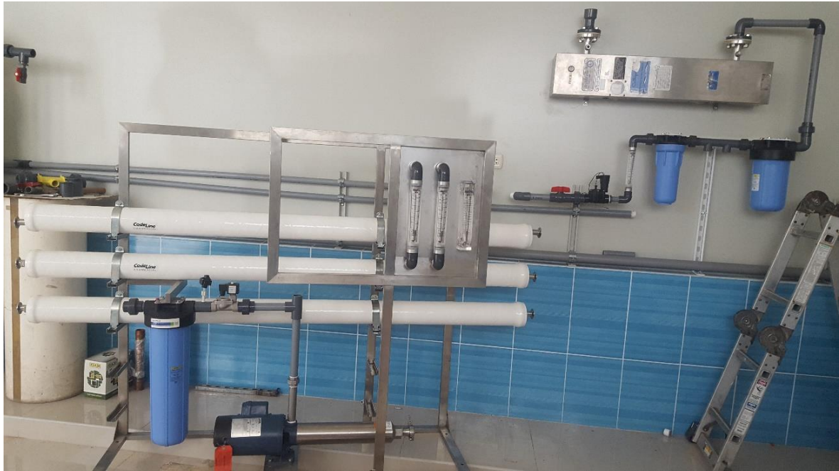
Figura 33 Ubicación de equipo de Osmosis Inversa en el punto
