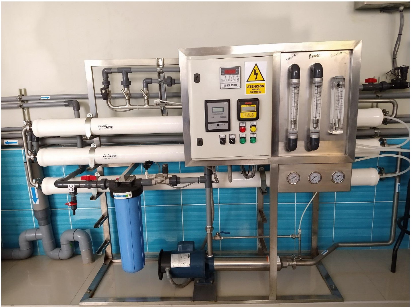
Figura 12 Equipo de Ósmosis Inversa
