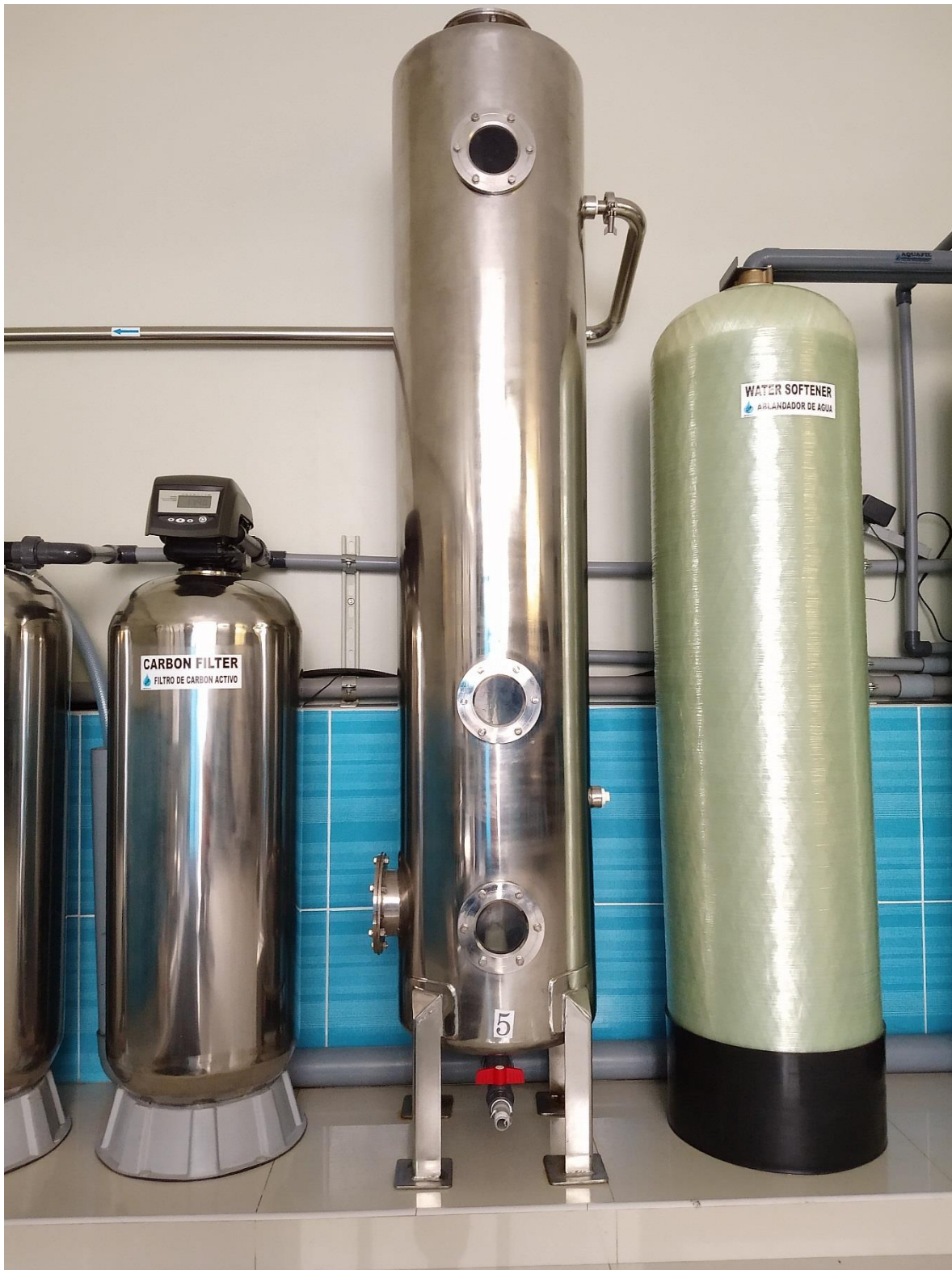
Figura 16 Tanque de contacto de Ozono
