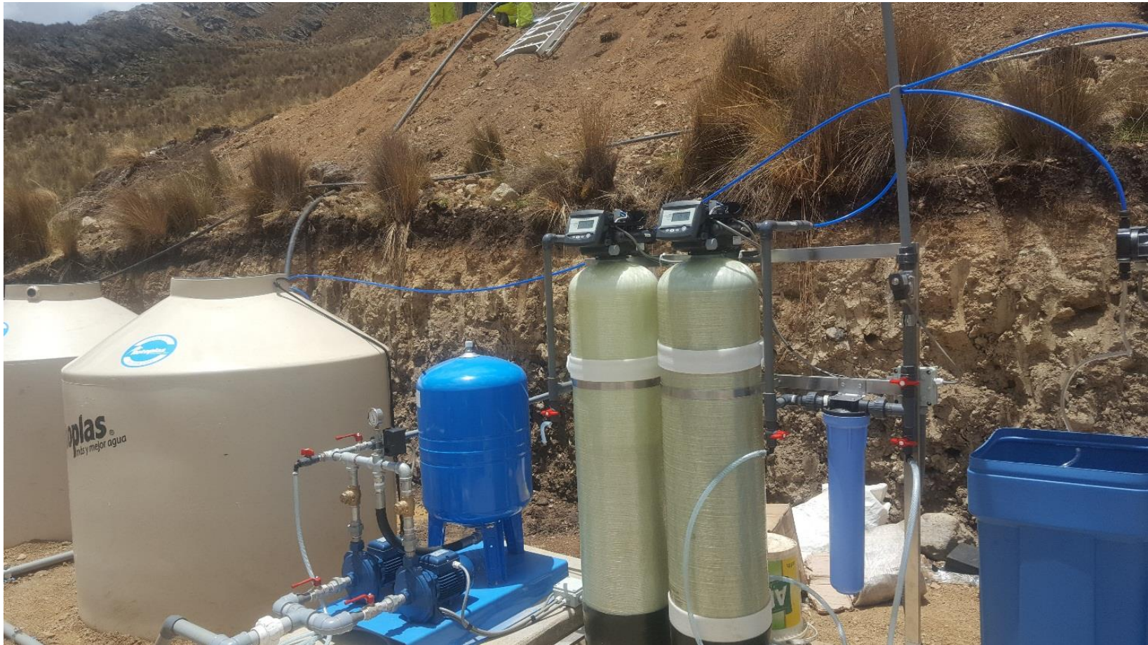
Sistema de Tratamiento de Agua Potable Minera Ares
