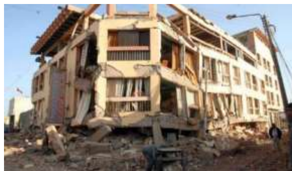
Figura 1: Edificación colapsada en Ica – 2007
