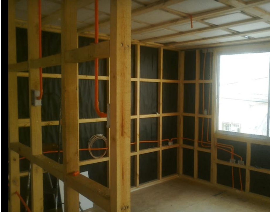
Figura 26: Implementación del sistema eléctrico.
