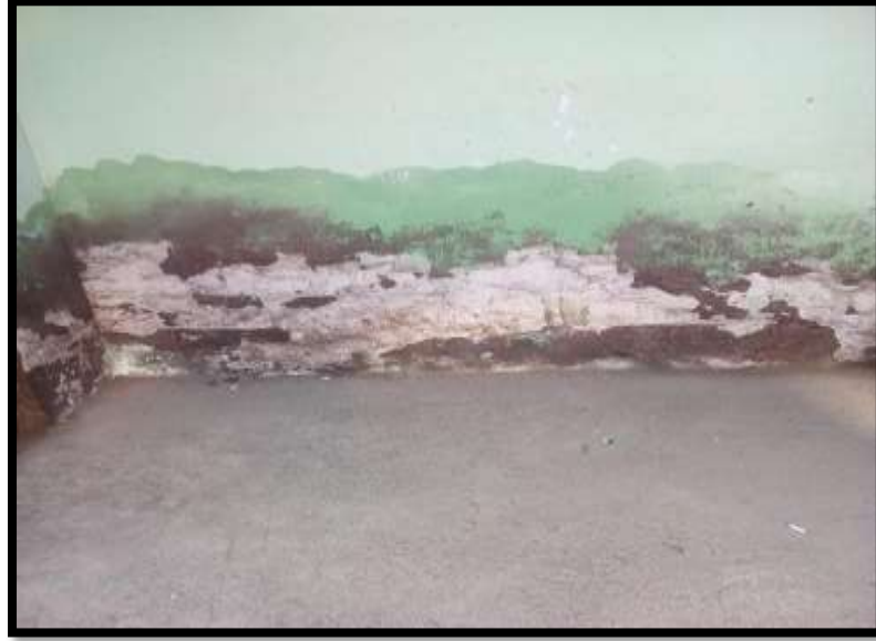
Figura 32. Visualización de la humedad y desprendimiento de la pintura.
