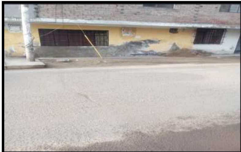
Figura 31. Visualización de la humedad y desprendimiento de la pintura.
