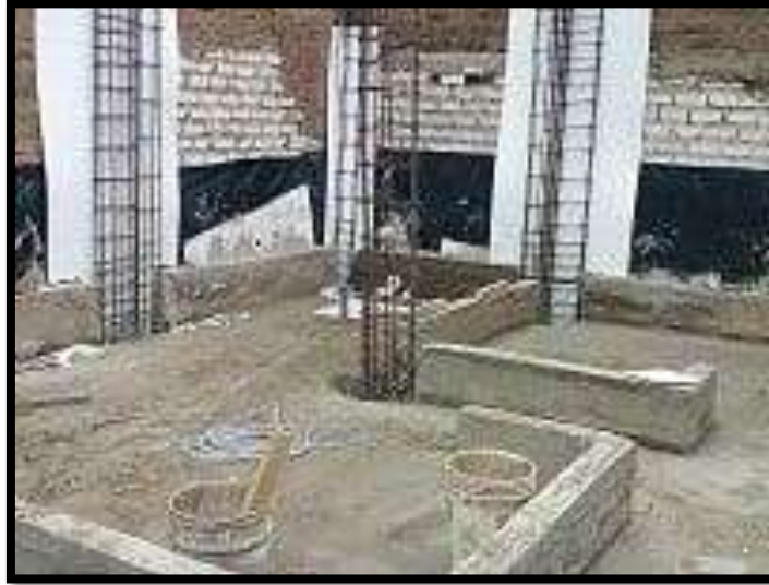
Figura 25. Foto de cimientos vaciados con polietileno colocado en Urb. La Floresta – Los Olivos.
