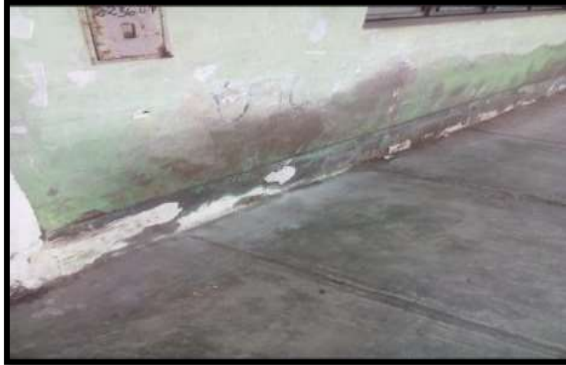
Figura 30. Visualización de la humedad en las paredes.
