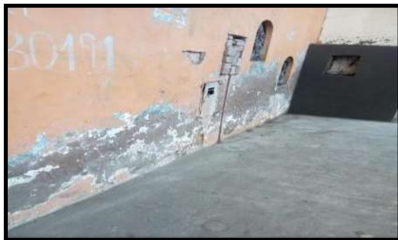
Figura 33. Visualización de la humedad y desprendimiento de la pintura.
