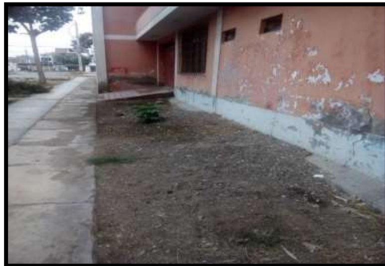
Figura 29. Visualización del deterioro del tarrajeo en las paredes.
