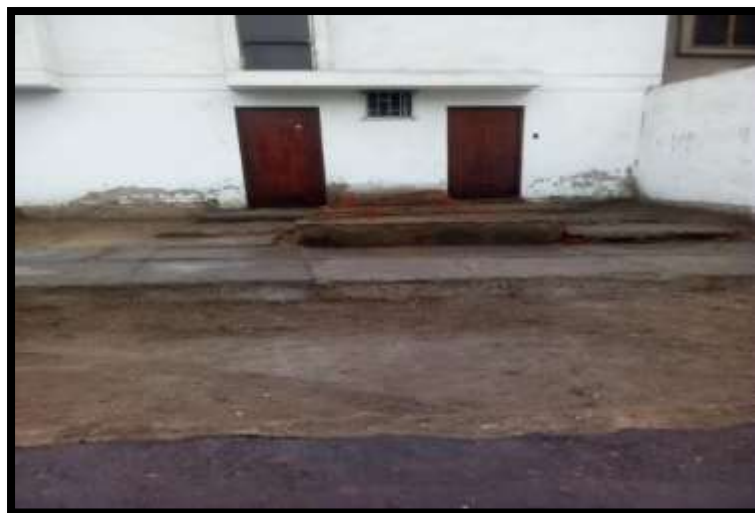
Figura 37. Visualización del deterioro de las paredes de ladrillo.
