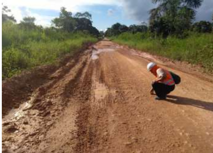
Figura 47. Deformación de la plataforma Km 10+600 de severidad alto
