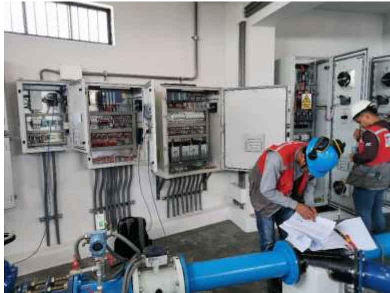
Figura 92 Programación de tableros
