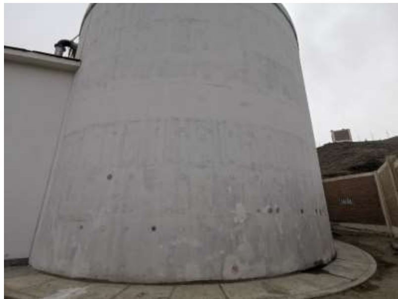
Figura 70 Detección de filtraciones
