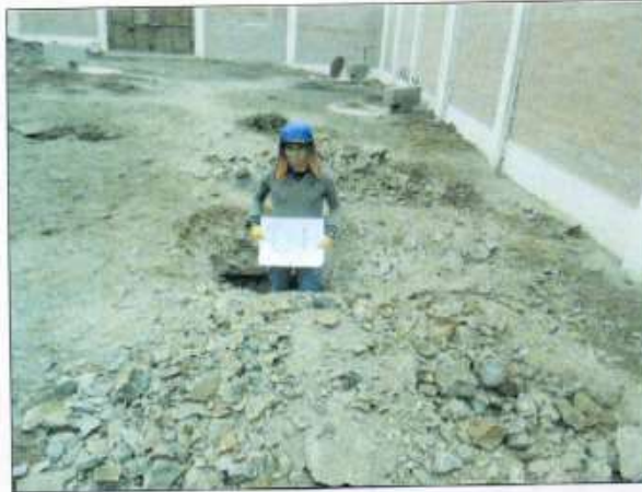
Foto N°3: De 0.00 a -0.10m de profundidad de la calicata C-1, se encuentra una losa de concreto simple (Cs) se encuentra en mal estado de conservación. De -0.10 a -0.20m de profundidad, es una arena mal graduada (SP), contiene gravas sub-redondeadas de tamaño máximo 1", suelta, de color gris, 0.9% de humedad, su composición es: 32.91% de gravas, 62.70% de arenas y 4.39% de finos.
