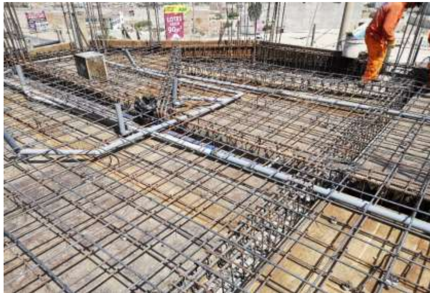
Figura 55 Armado losa maciza y vigas más colocación de las tuberías para sumideros y conexiones eléctricas de caseta
