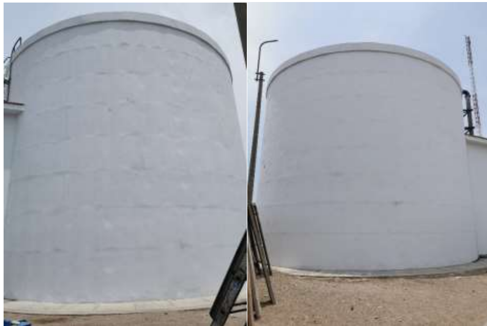
Figura 74 Verificación de filtraciones de la segunda llenada
