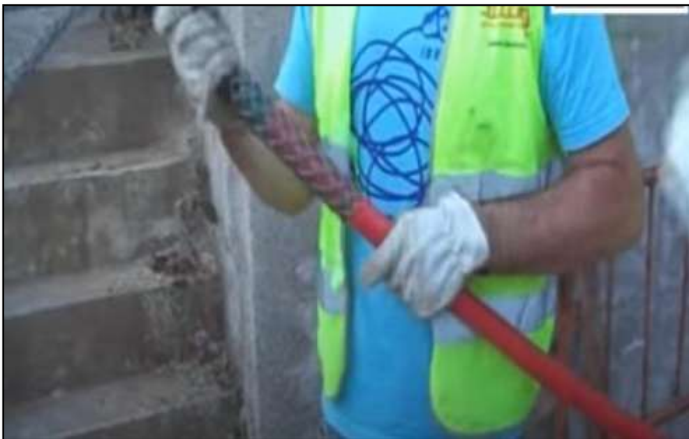
Figura 12: Preparación del cable de media tensión con la malla tensora y el empalme giratorio.
