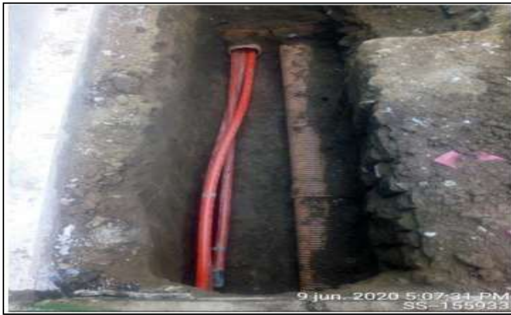
Figura 3: Canalización existente de cables eléctricos de media tensión protegidos con tubo de PVC corrugados de 6'' dentro de la zanja donde se realiza el tendido de red eléctrica de media tensión. Lima San Miguel Maranga 4ta etapa 2020
