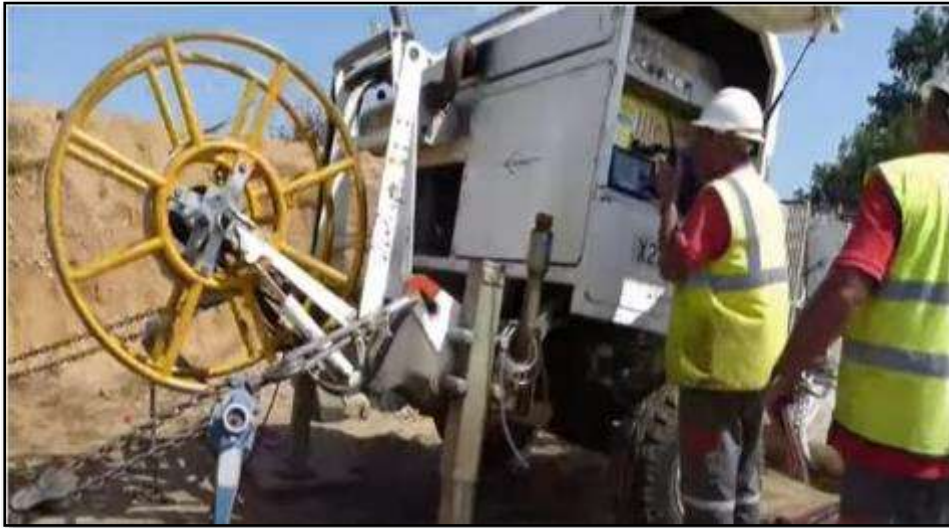
Figura 9: Equipo mecánico de tiro (winche) utilizado en tendido de redes de media tensión en canalizaciones cerradas en la empresa Iberdrola. España 2014.
