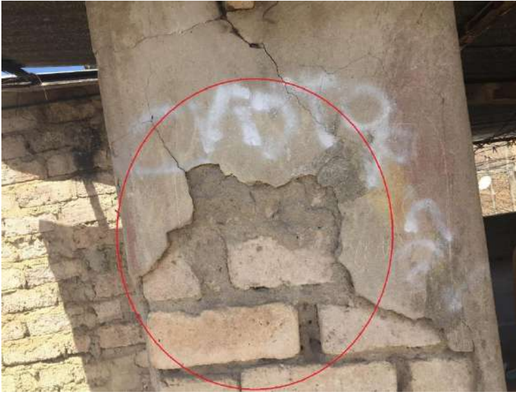
Figura 103: Presenta desprendimiento y fisuras en columna.
