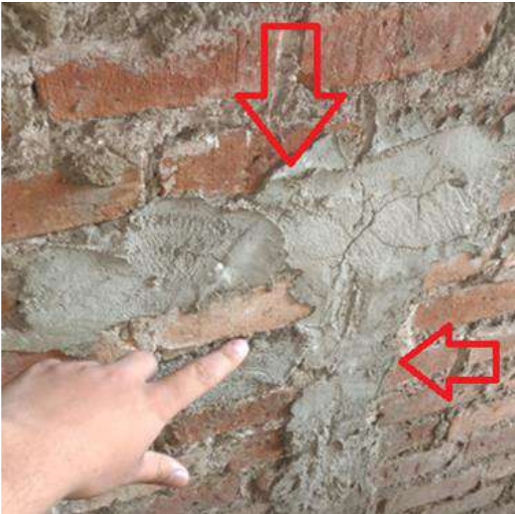
Figura 71: Muro perforado para instalación de agua sin ningún criterio de construcción.
