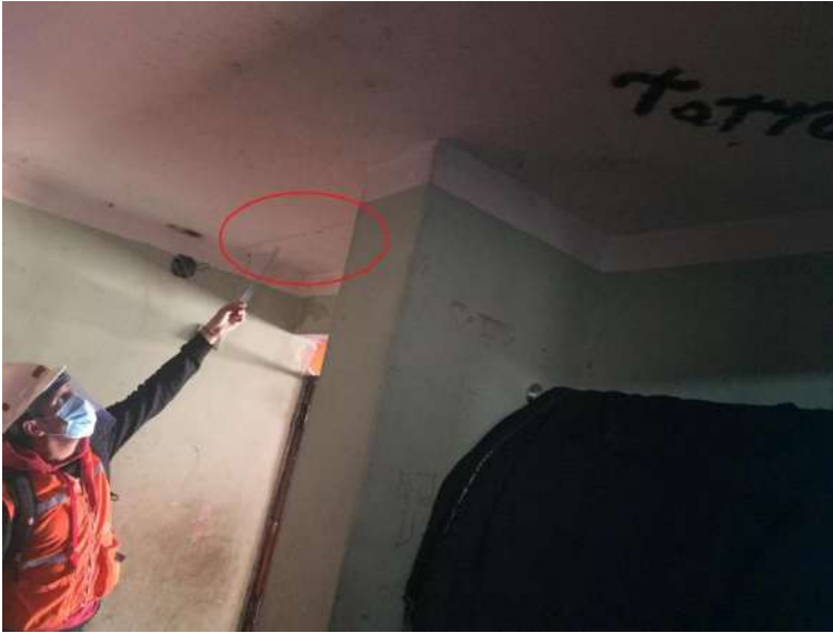
Figura 121: Fisuras en losa aligerada.
