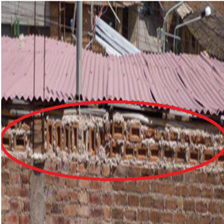
Figura 11: Asentado de ladrillo en malas condiciones y sin criterio técnico.
