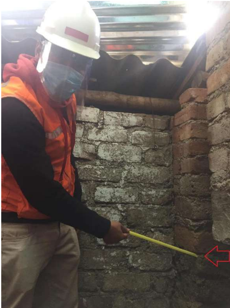
Figura 85: El espesor del mortero entre ladrillo no reglamentaria.
