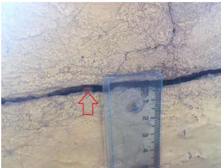
Figura 52: Presenta grieta vertical en muro.
