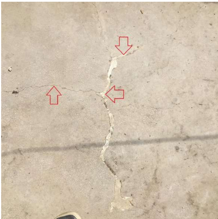
Figura 92: Fisura vertical y horizontal en losa.
