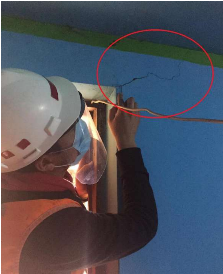
Figura 125: Grieta vertical en muro.
