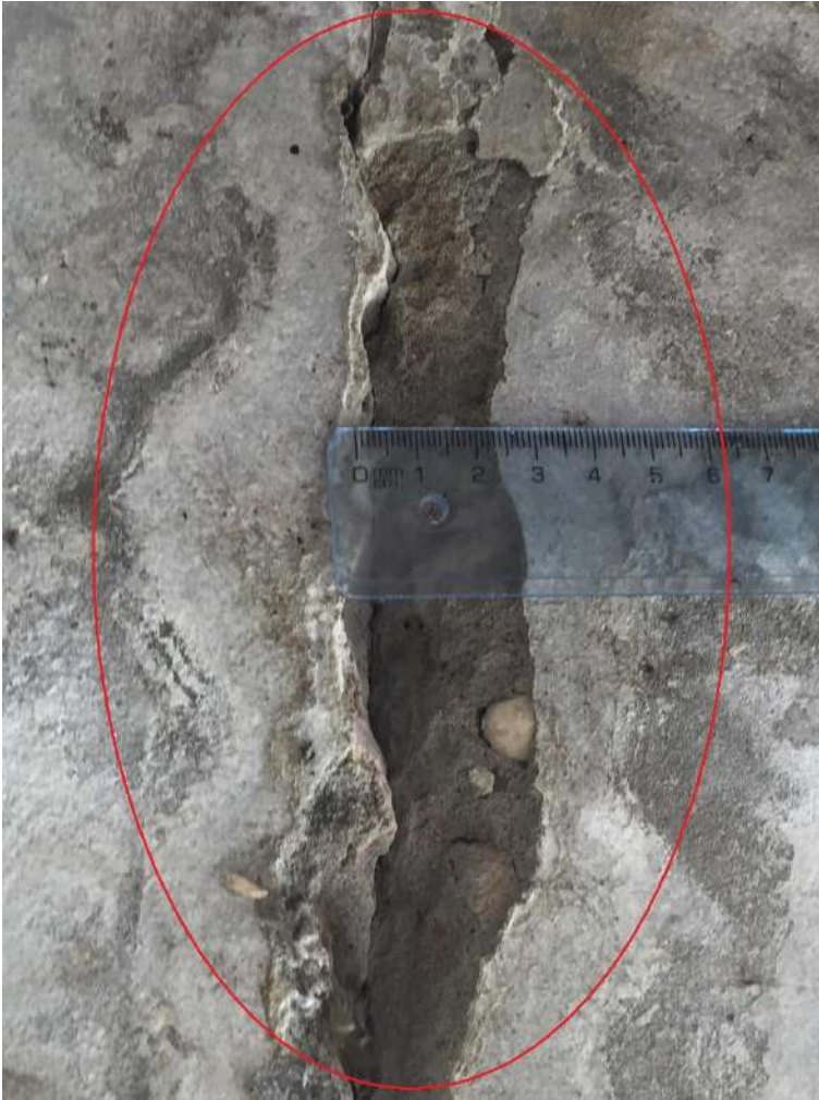
Figura 83: Grieta horizontal en muro.
