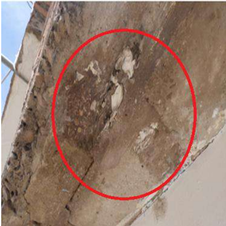
Figura 160: Restos de obra en losa aligerada.
