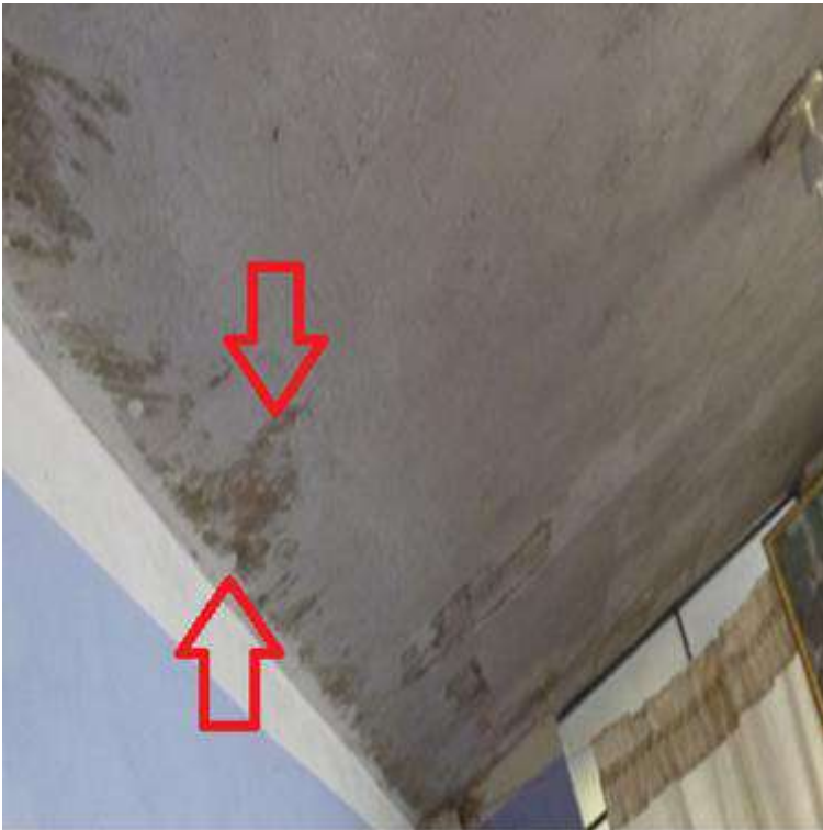
Figura 39: Presenta humedad y desprendimiento de losa.
