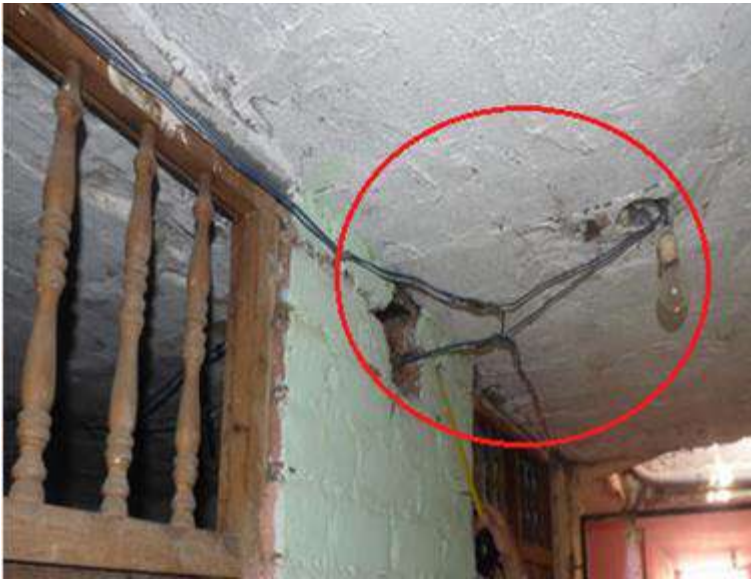
Figura 53: Presenta mal diseño de cableado expuesto a la intemperie y mal asentado de ladrillo.
