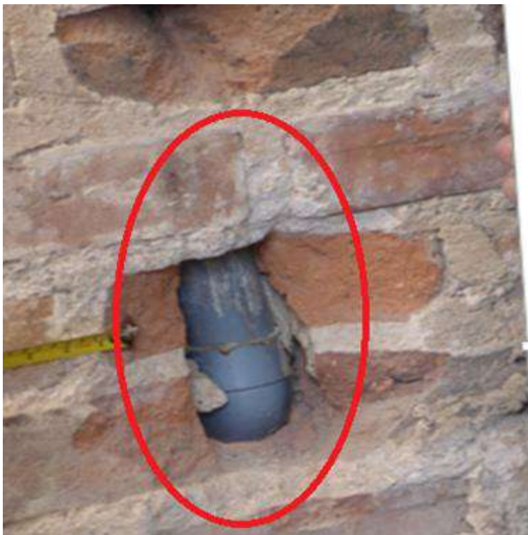
Figura 158: Muro perforado sin sellar exponiendo tubería de desagüe.
