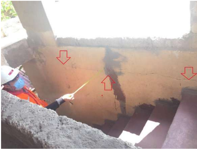
Figura 147: Grietas verticales y horizontales en muro de confinamiento.
