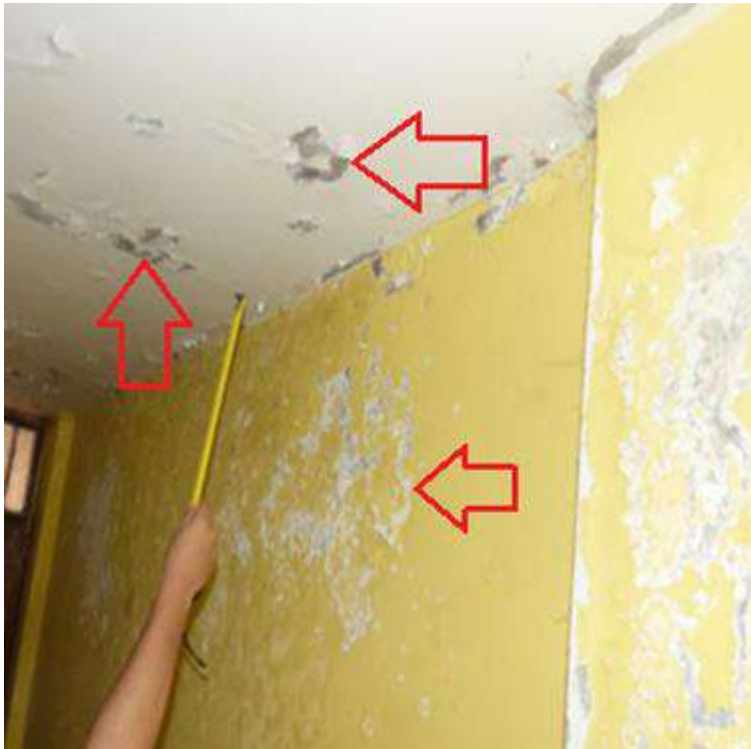
Figura 51: Presenta humedad y desprendimiento en muro y techo.
