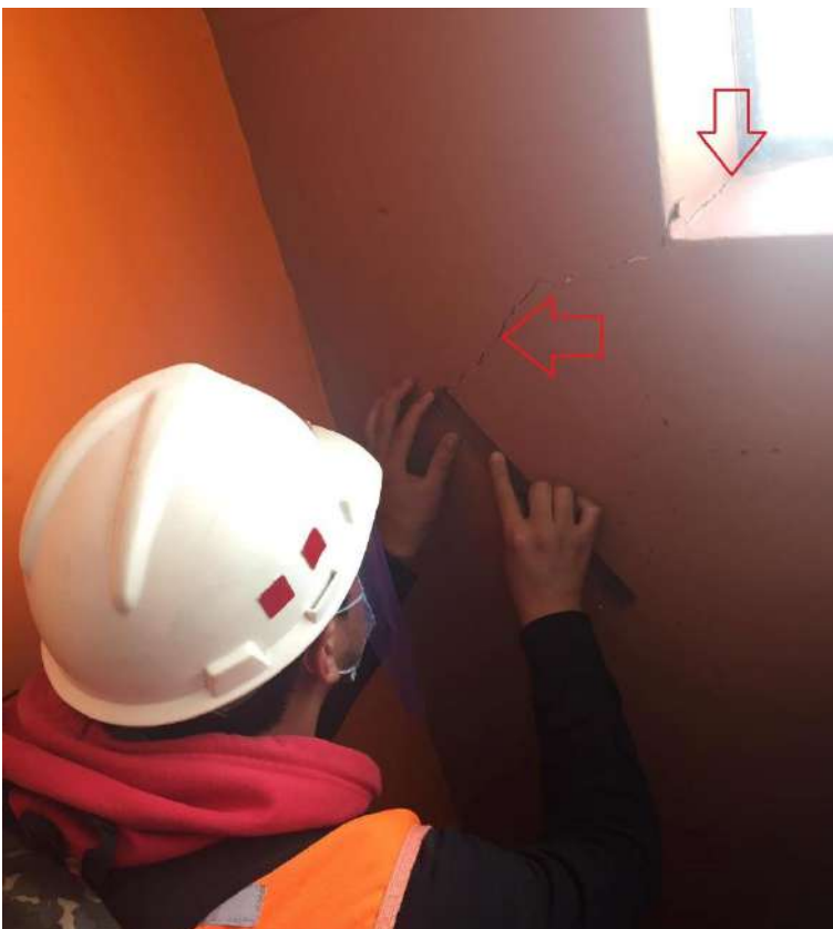
Figura 180: Grieta vertical en muro de albañilería.
