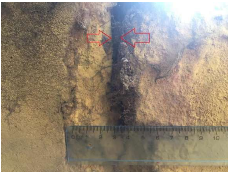
Figura 90: Grieta horizontal en pared.
