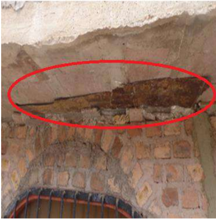
Figura 173: Residuos de encofrado.
