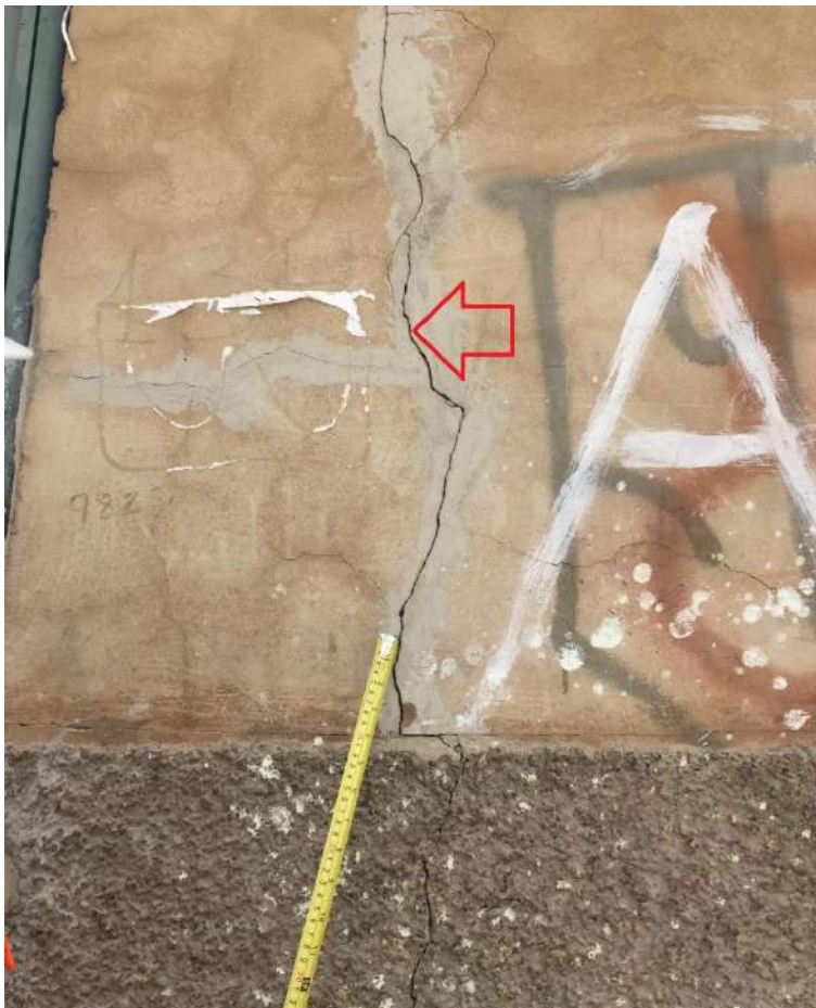
Figura 68: Grieta horizontal en muro.
