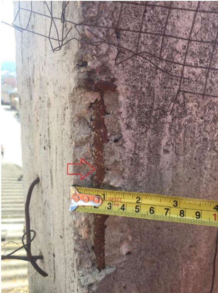
Figura 115: Corrosión de acero y expuesta a la intemperie y desprendimiento del recubrimiento de la columna.
