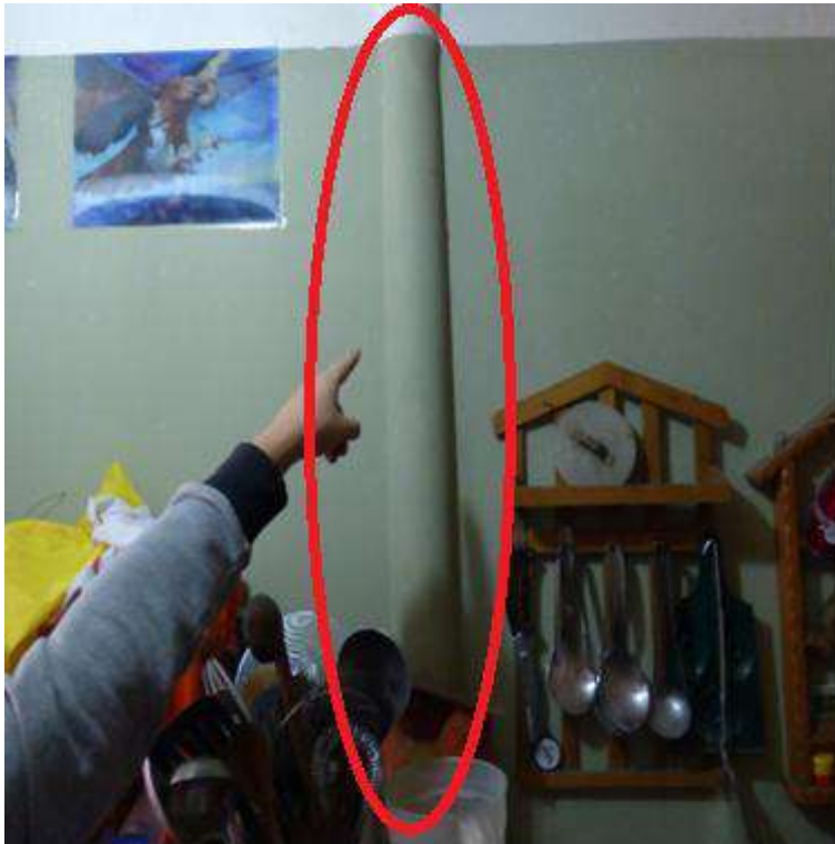
Figura 13: Tubo de desagüe sin criterio técnico expuesto fuera de muro.
