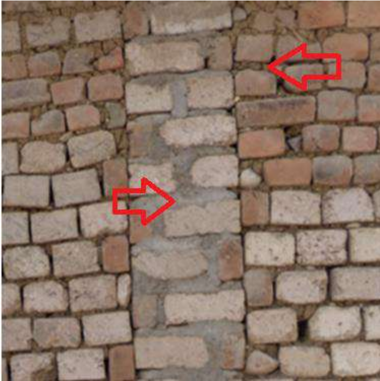
Figura 67: Asentado de ladrillo con mortero y tierra sin criterio de construcción.
