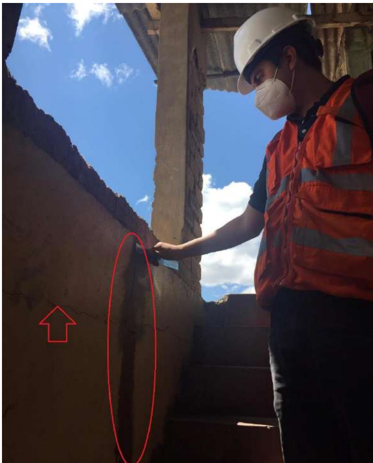
Figura 182: Grieta vertical y horizontal en muro de albañilería.
