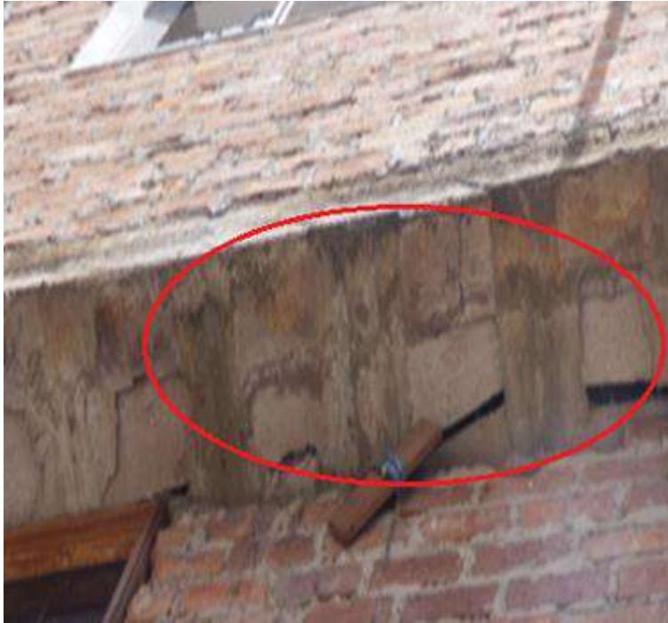
Figura 165: Fractura en losa aligerada.
