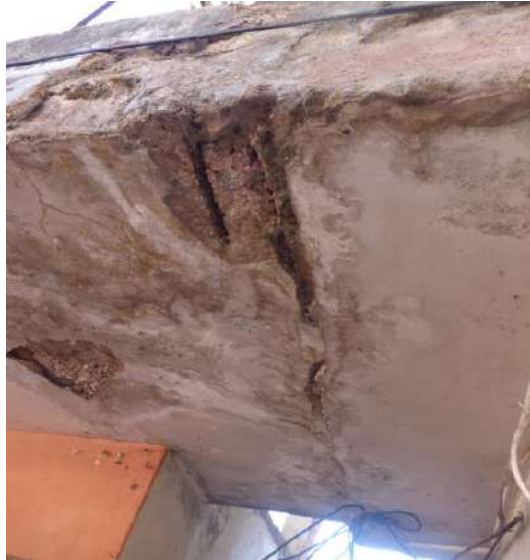
Fig.3. Indicios de corrosión en el techo y Nótese el escaso recubrimiento del refuerzo positivo.
