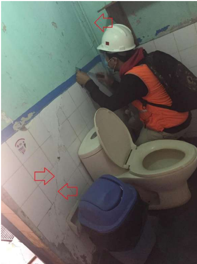
Figura 178: Grietas verticales y horizontales en muro de albañilería.
