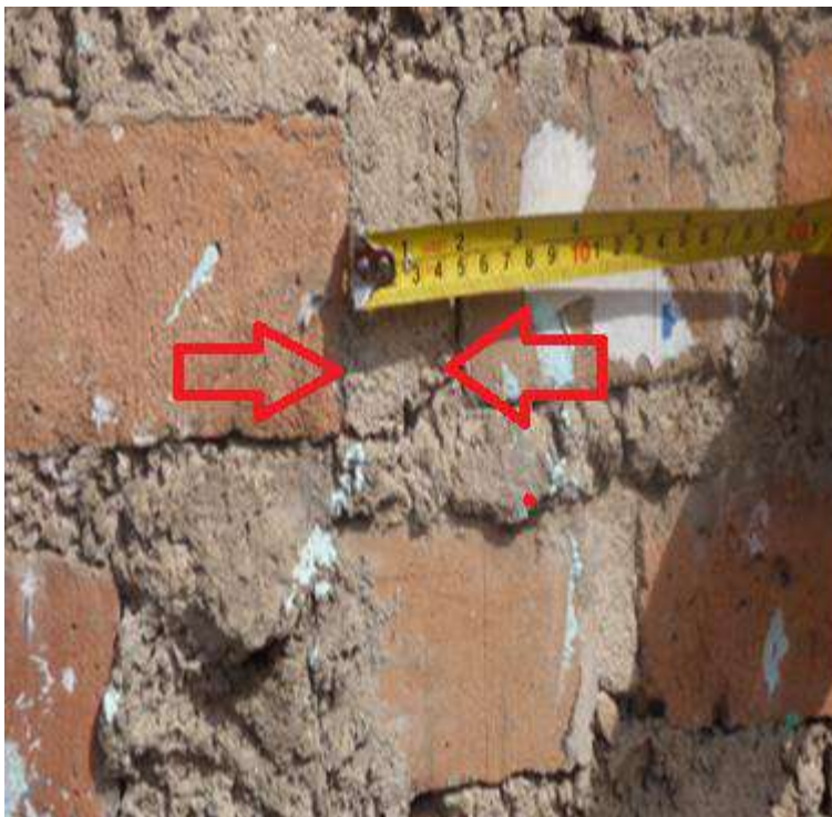
Figura 152: Espesor de mortero para asentado de ladrillo no reglamentario.
