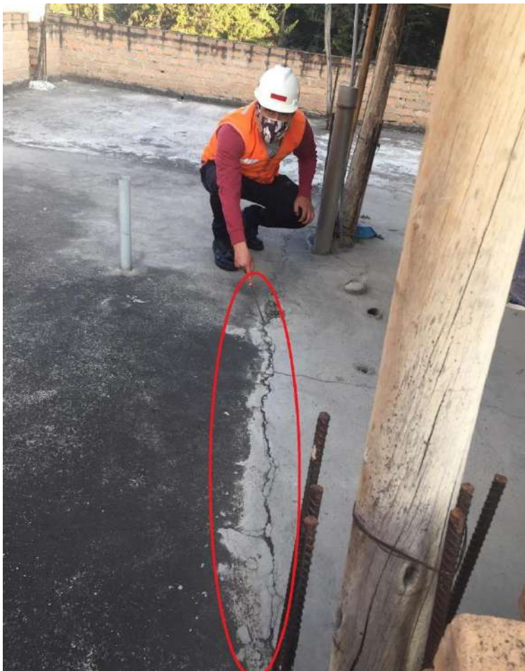
Figura 66: Presenta grieta en losa.
