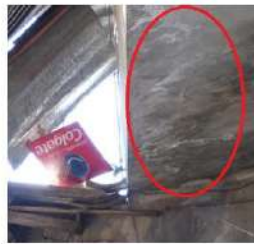
UBICACIÓN DE PATOLOGÍAS
