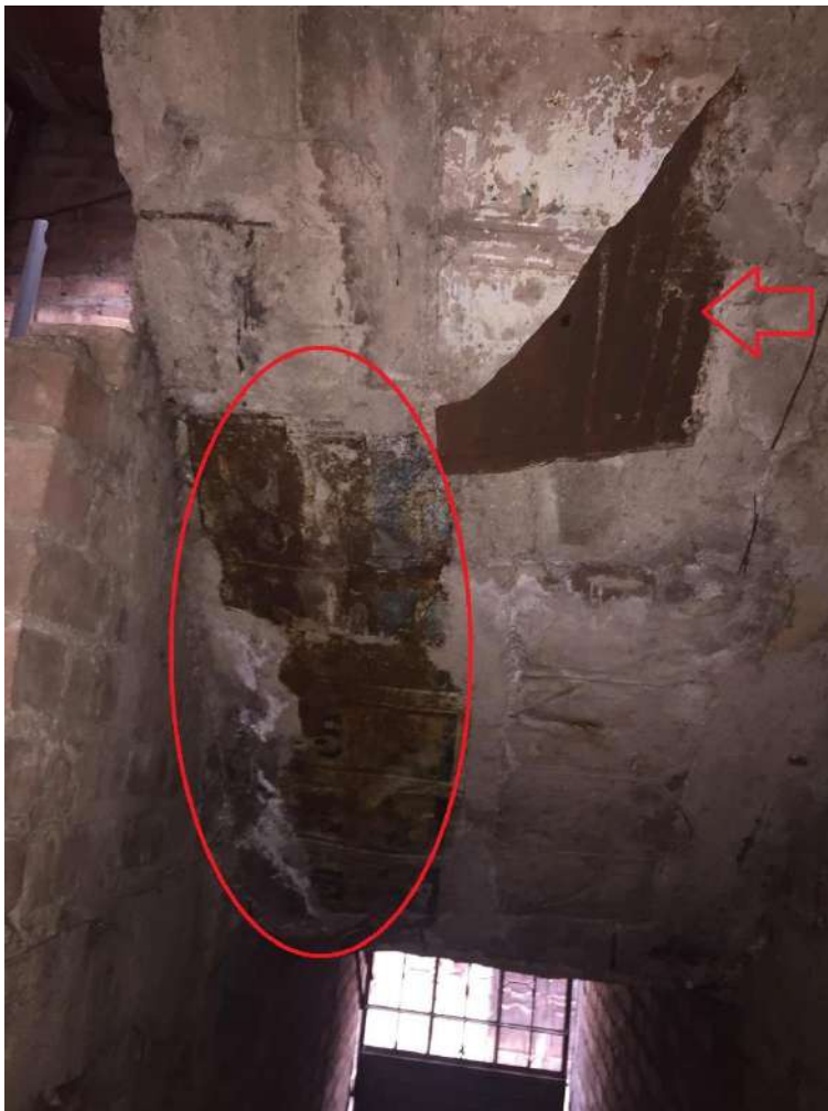
Figura 20: Presenta residuos de encofrado.
