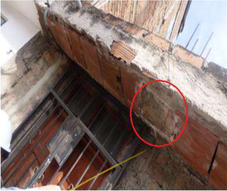
Figura 41: Presenta humedad y eflorescencia en losa.
