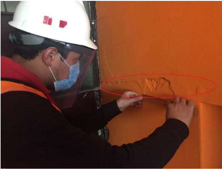
Figura 133: Grieta vertical en muro.
