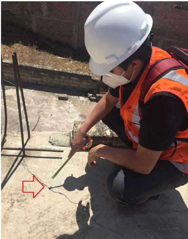
Figura 34: Presenta fisura en losa.
