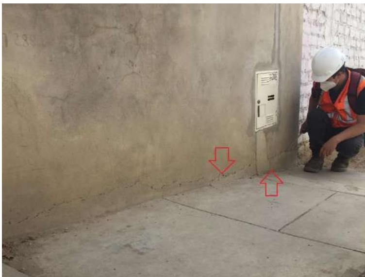
Figura 8: Falla longitudinal en muro.
