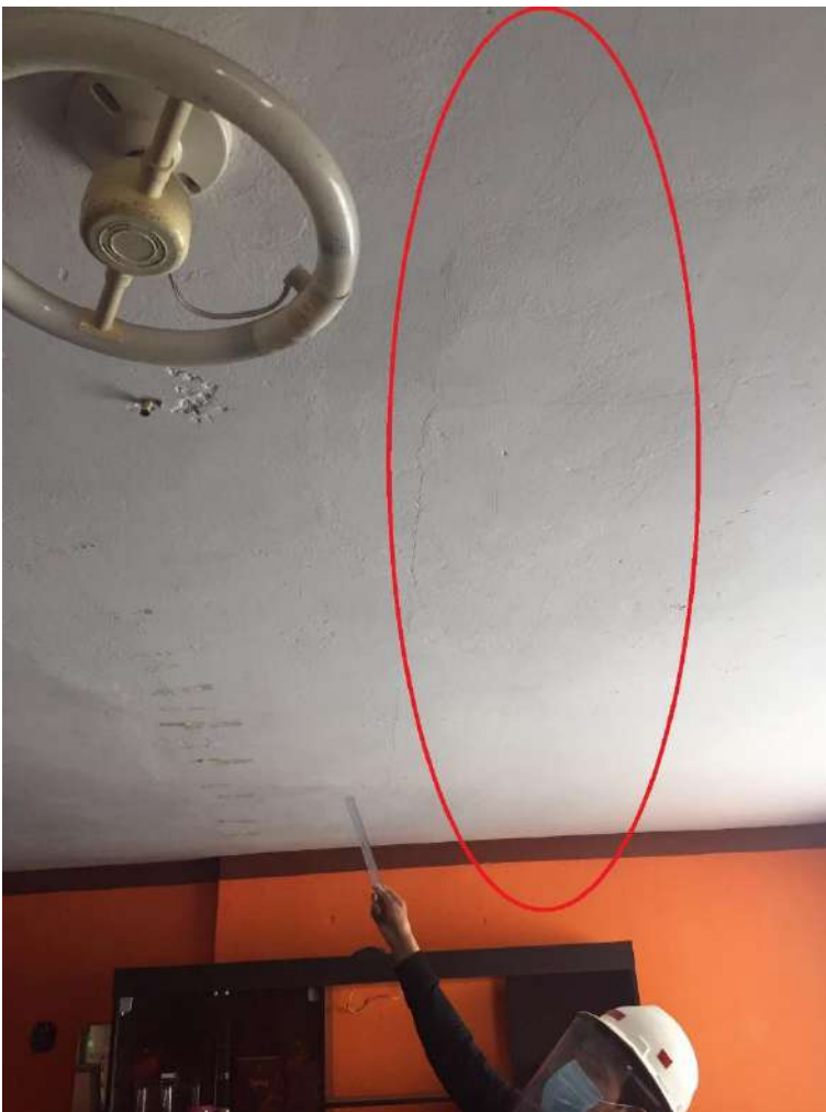
Figura 74: Presenta fisura en losa.
