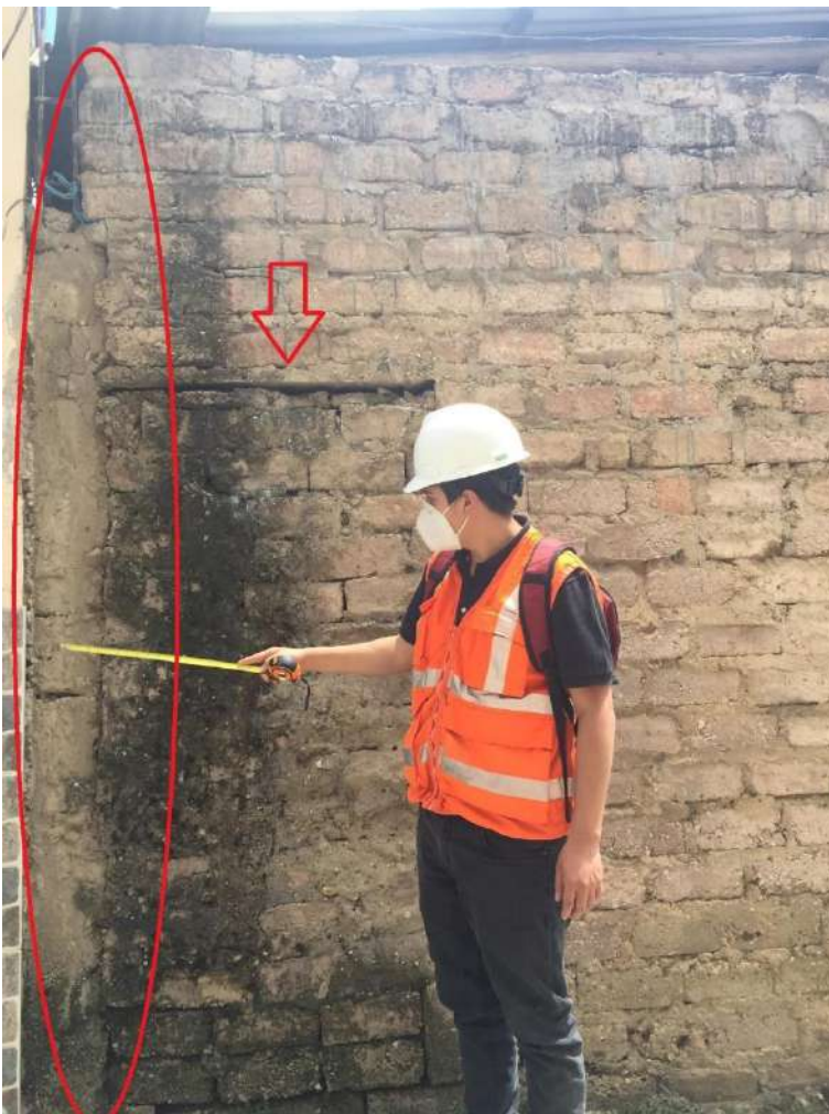
Figura 4: Columna con cangrejas, muro de puertas clausurada mal criterio de diseño.
