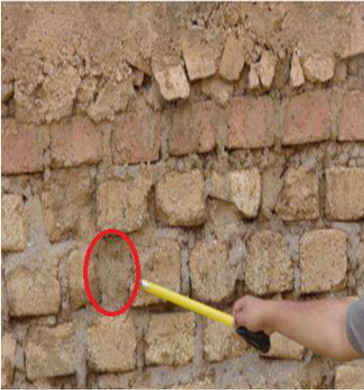
Figura 55: Mal criterio de asentado de ladrillo.
