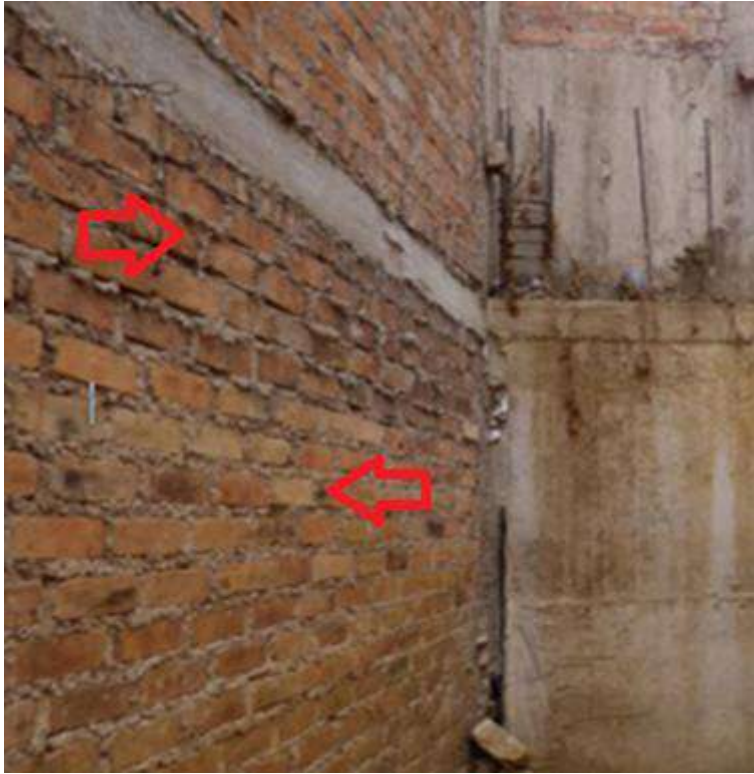
Figura 69: Muro de contención en condiciones de rajadura y mal asentado de ladrillo.
