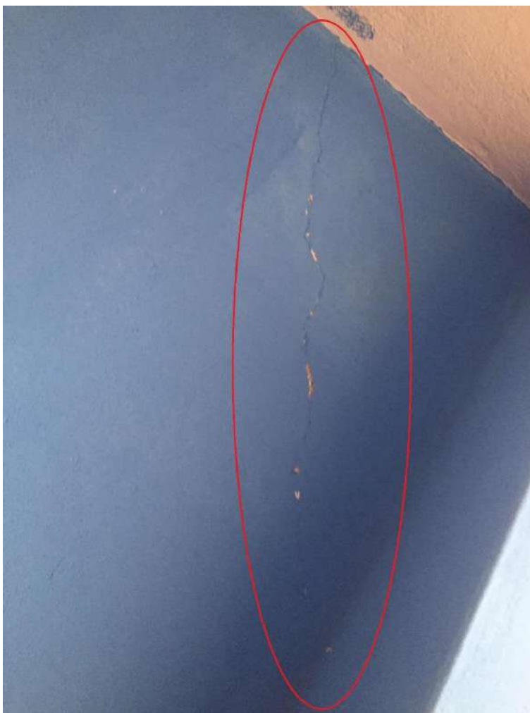
Figura 164: Presenta grietas en los muros.
