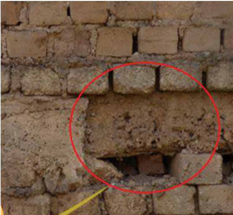
Figura 73: Unión de muro con losa unidos con ladrillos rotos sin ningún criterio de confinamiento.
