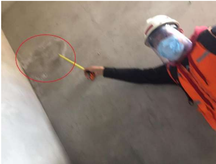
Figura 135: Humedad en losa aligerada.
