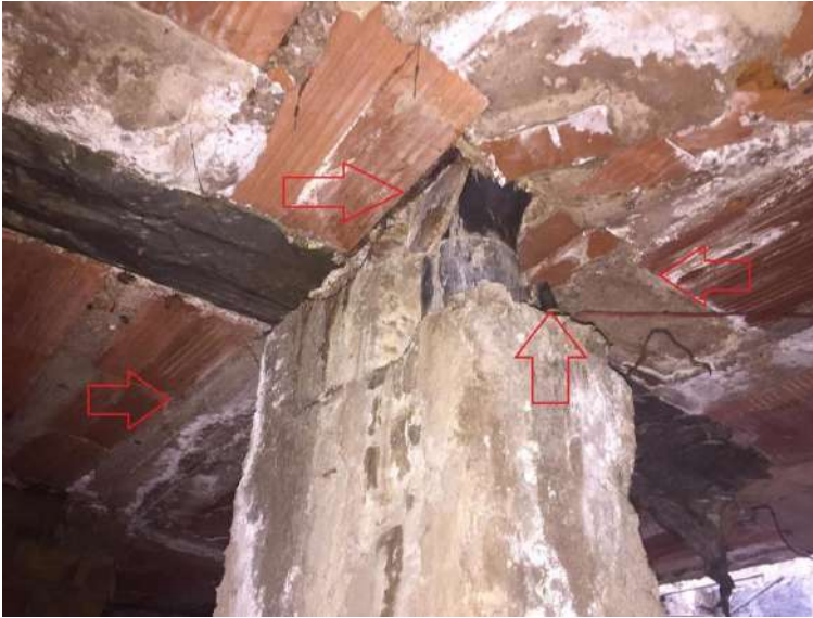
Figura 119: Presenta eflorescencia en la losa.
