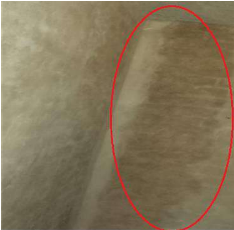
Figura 47: Presenta humedad en losa.
