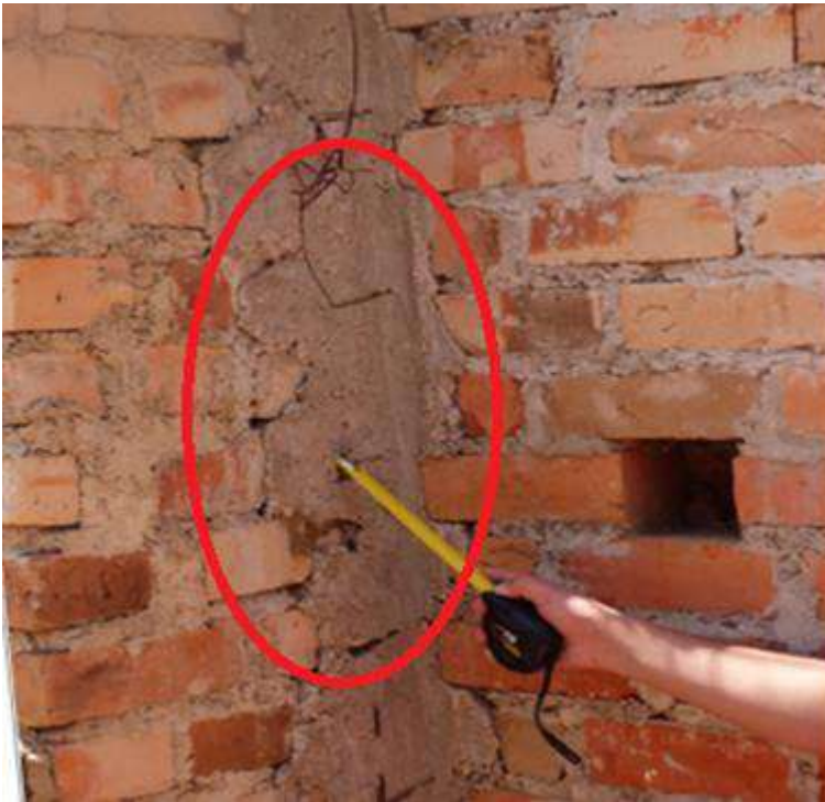
Figura 7: Presenta cangrejas en columna de amarre.
