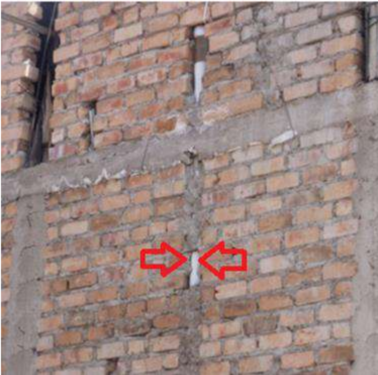
Figura 17: Tubería de desagüe expuesta a intemperie.
