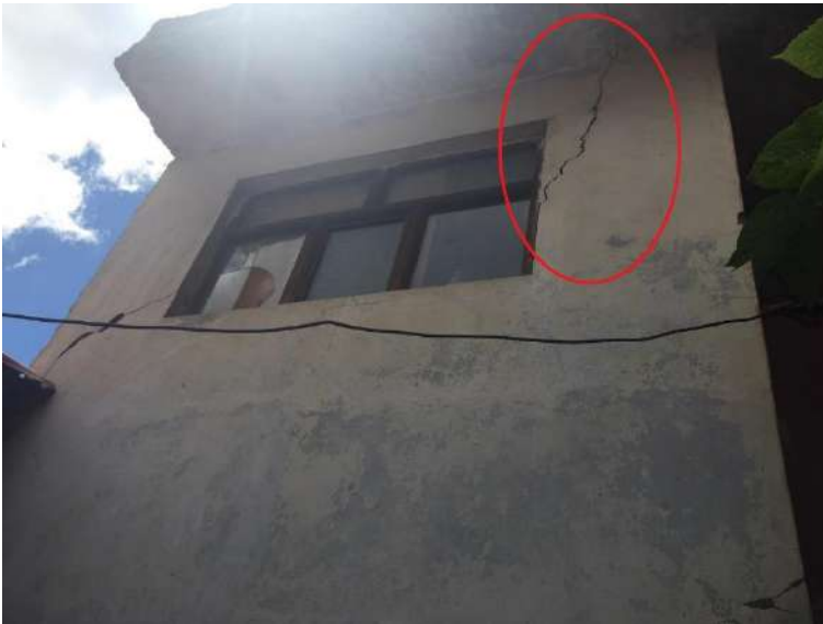
Figura 72: Presenta grieta horizontal en muro.
