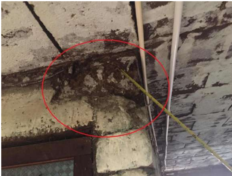
Figura 38: Mal criterio de asentado de ladrillo y presenta desprendimiento de concreto.
