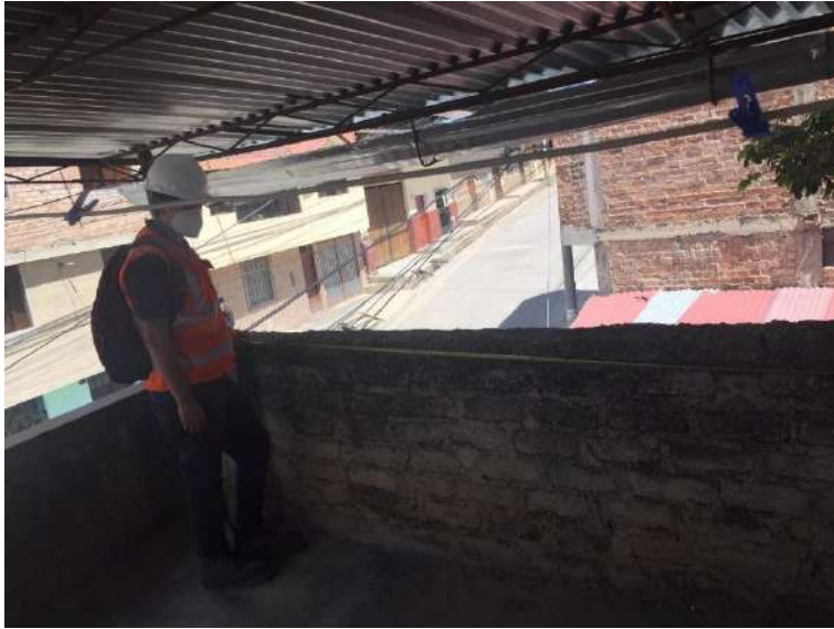
Figura 131: Desprendimiento de ladrillos de muro.
