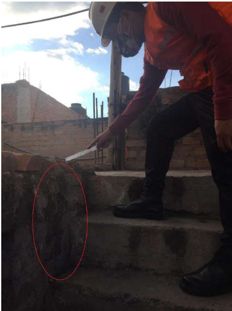
Figura 174: Presenta eflorescencia por causas de la infiltración de humedad.
