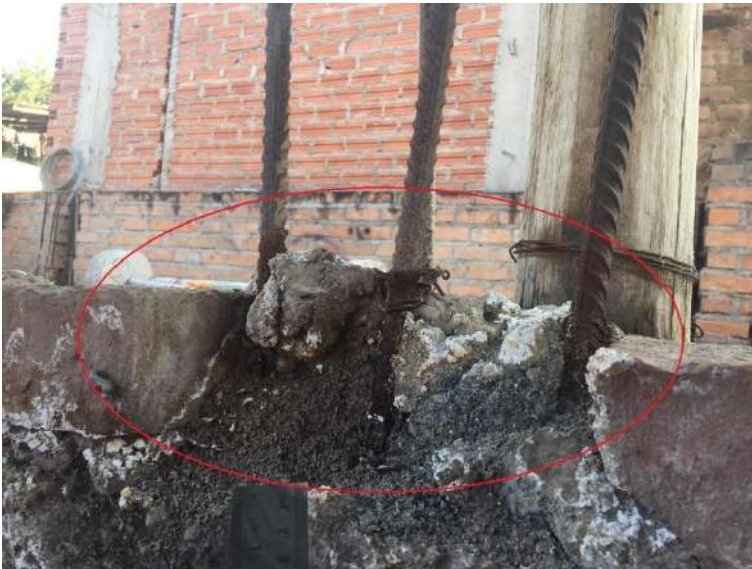
Figura 94: Presenta corrosión del acero de refuerzo.
