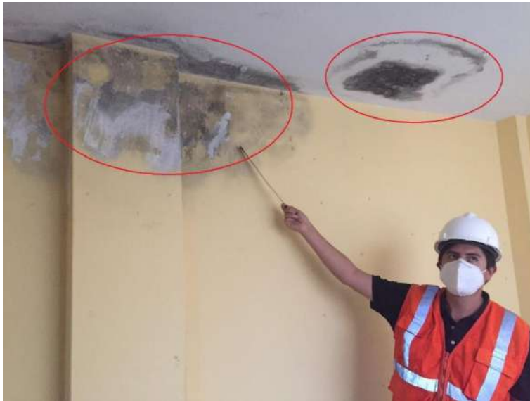
Figura 109: Presenta humedad, eflorescencia y causas en muros interiores.
