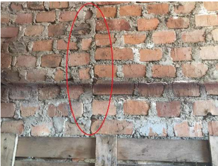
Figura 18: Mal asentado de ladrillo.
