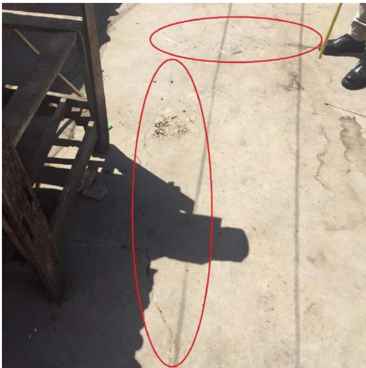
Figura 60: Presenta fisuras en losa.
