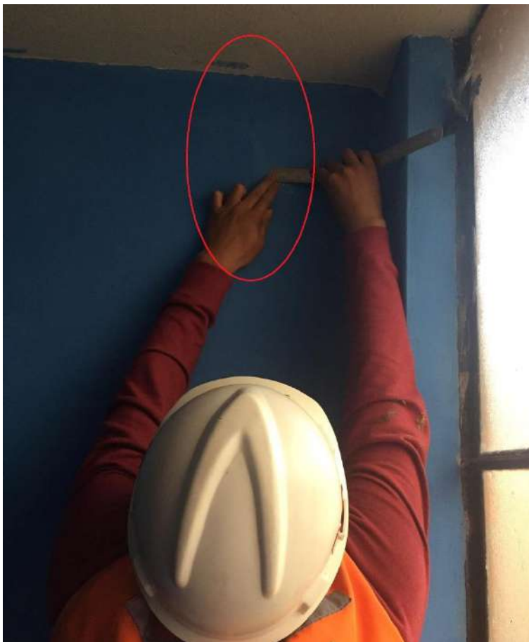
Figura 170: Fisura en muro de albañilería.
