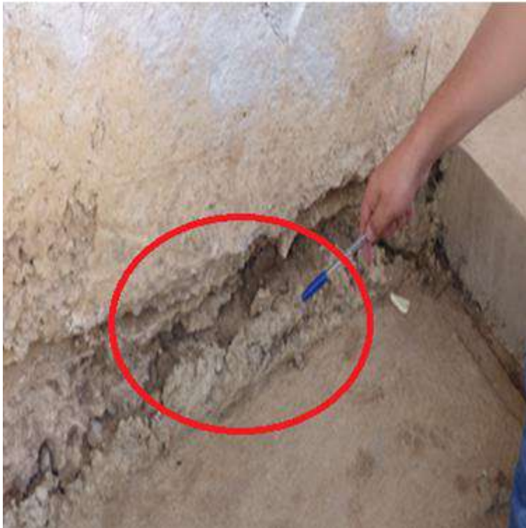
Figura 6: Desprendimiento de sobrecimiento.
