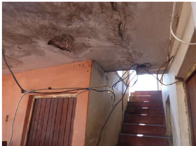
Fig.2. Corrosión y corrimientos de fisuras techo del segundo nivel.
