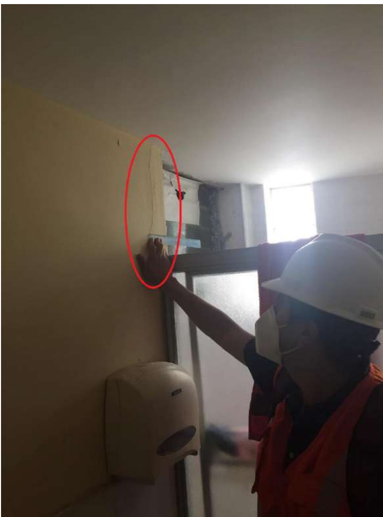
Figura 40: Presenta fisura horizontal en muro.
