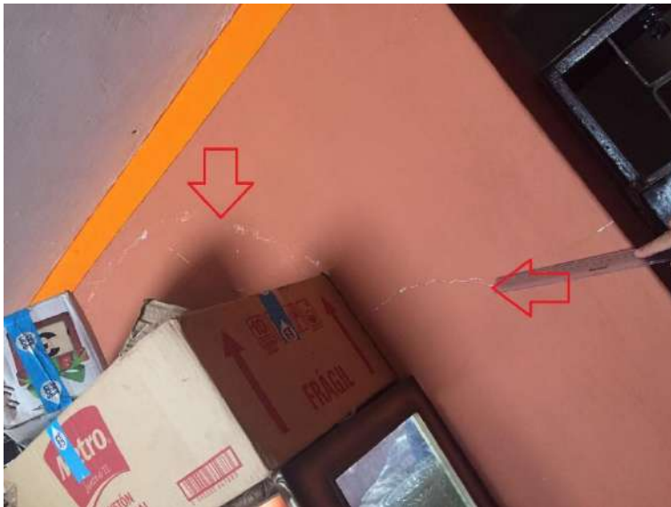
Figura 70: Presenta fisura horizontal en muro.
