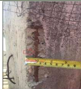
UBICACIÓN DE PATOLOGÍAS
