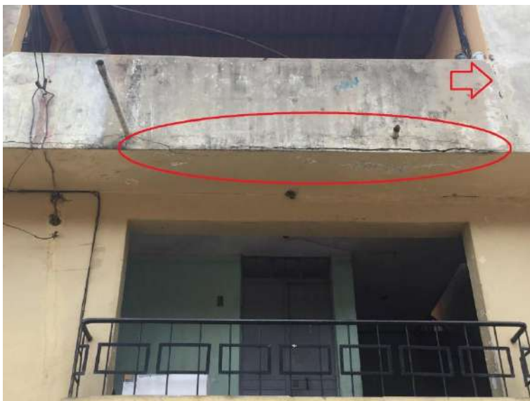
Figura 30: Presenta grieta vertical voladizo.
