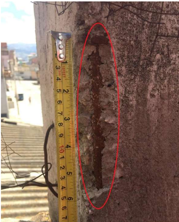
Figura 36: Presenta corrosión de acero y desprendimiento de concreto.
