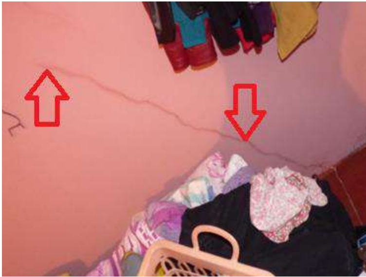
Figura 21: Falla vertical en muro.
