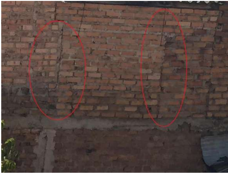
Figura 5: Asentado de ladrillo sin criterio técnico por partes.
