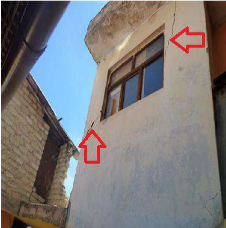
Figura 19: Presenta grieta vertical en miro.
