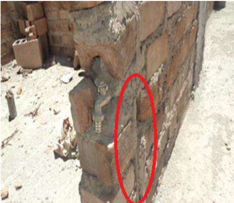
Figura 61: Mal criterio para poner caño de agua.
