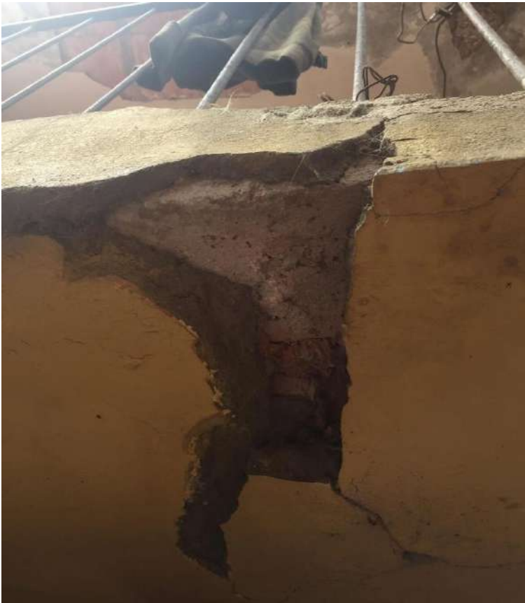
Figura 153: Desprendimiento de recubrimiento de losa aligerda.
