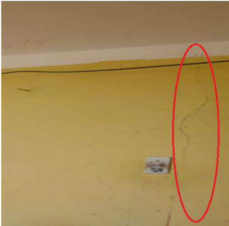
Figura 31: Presenta fisura vertical en muro.
