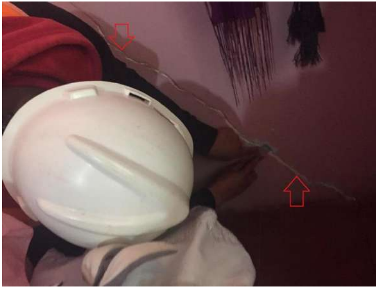
Figura 157: Grieta vertical de muro de albañilería.
