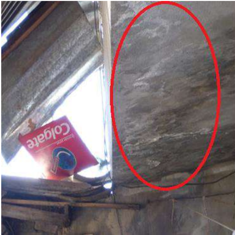
Figura 37: Presenta humedad y eflorescencia en losa.
