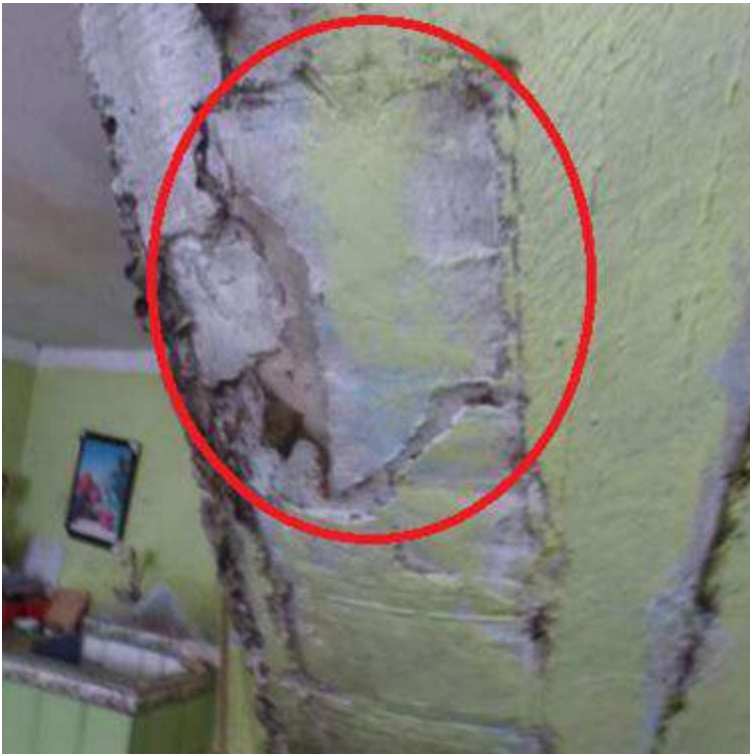
Figura 87: Restos obra en escalera con mal encofrado.
