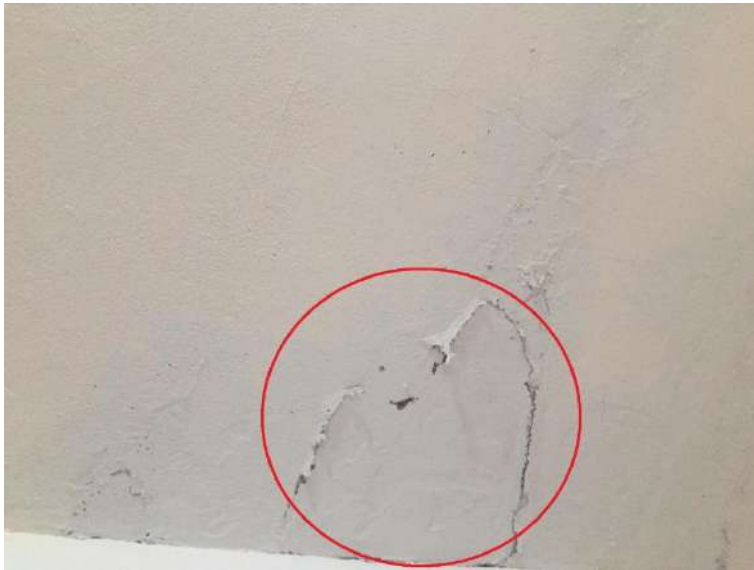
Figura 123: Humedad en losa aligerada y fisuras.
