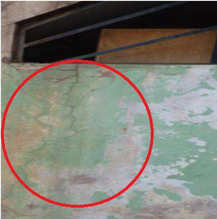
Figura 57: Presenta grietas horizontales en muro.
