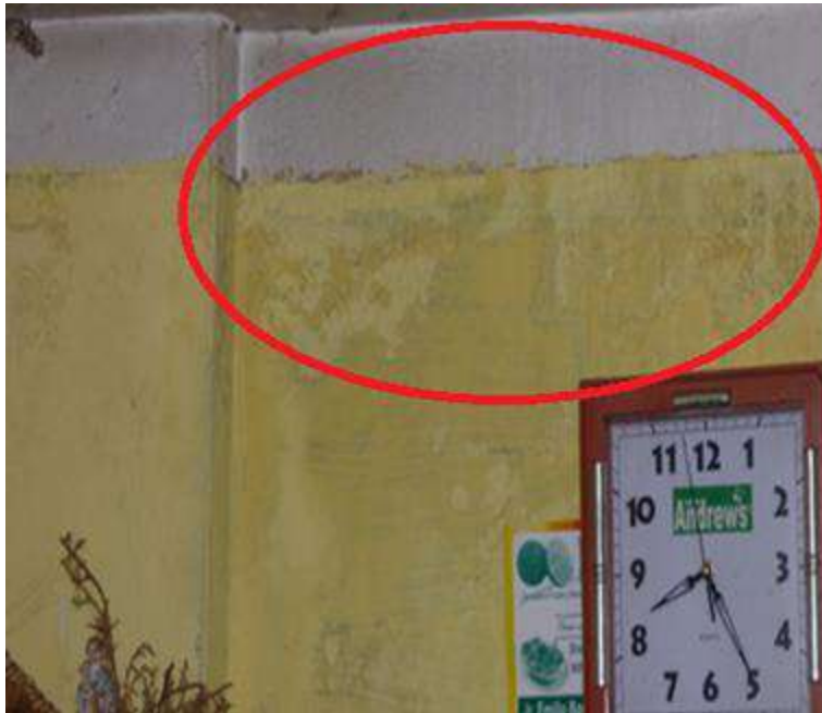
Figura 49: Presenta humedad en muros.
