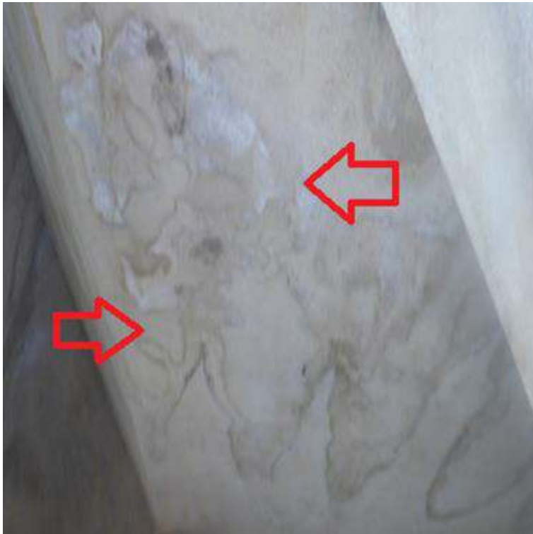
Figura 43: Presenta humedad y eflorescencia en losa.
