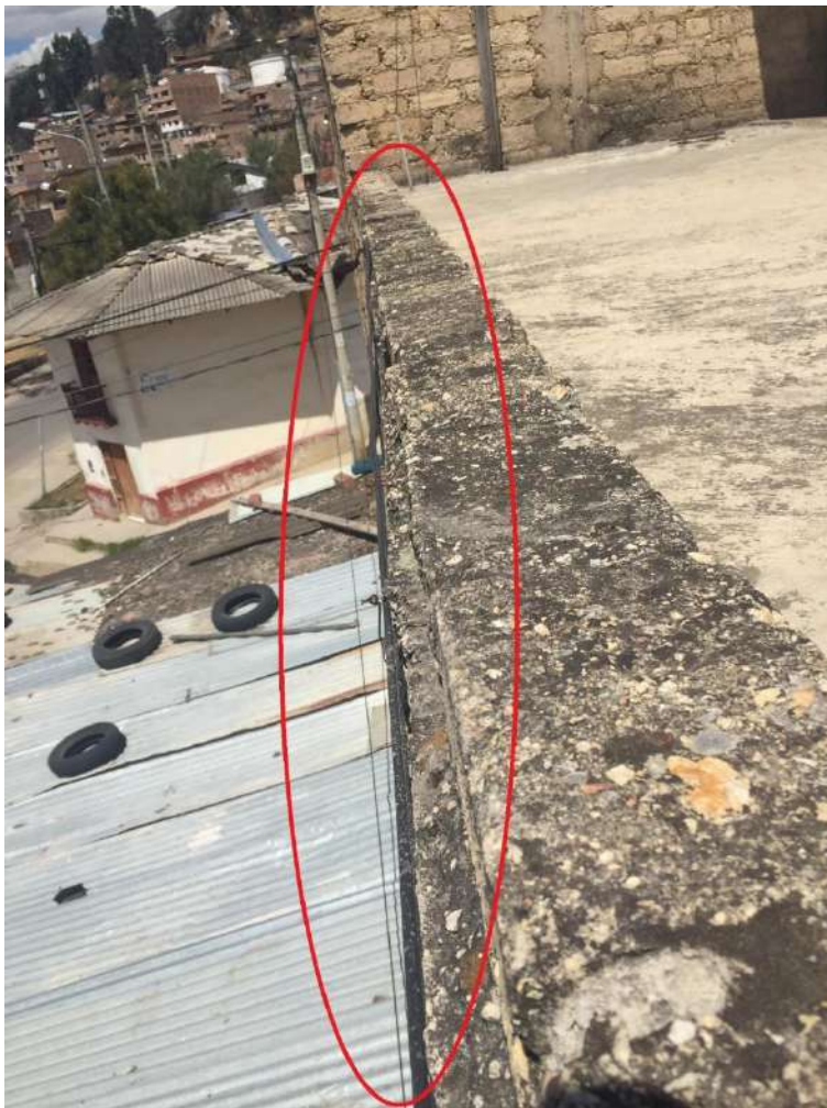
Figura 14: Presenta viga deflectada.
