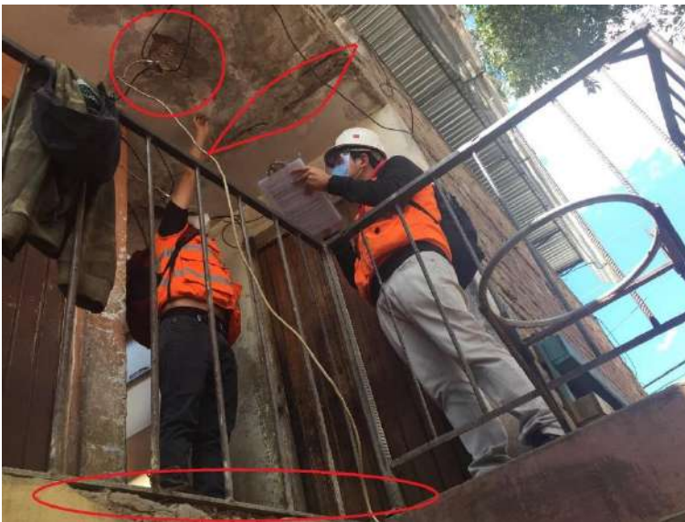
Figura 56: Presenta humedad, desprendimiento y eflorescencia de losa.
