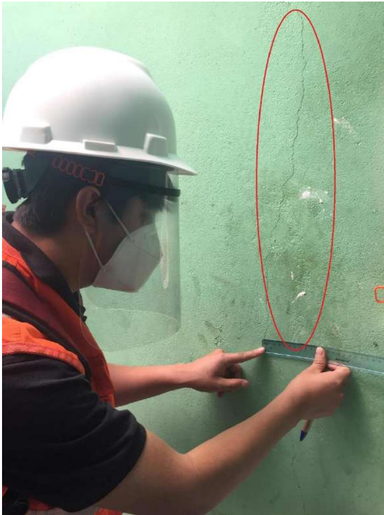
Figura 161: Fisura horizontal en muro de albañilería
