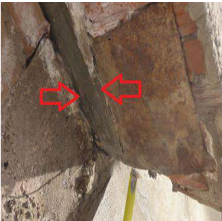
Figura 128: Restos de encofrado en losa.
