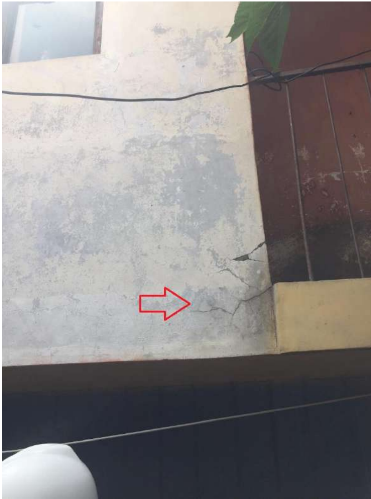
Figura 99: Presenta grietas en muro
