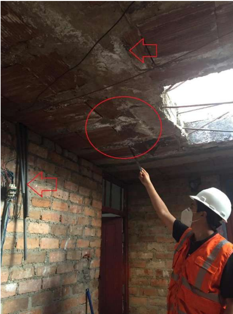
Figura 111: Presenta eflorescencia de losa y cableado eléctrico expuesto.
