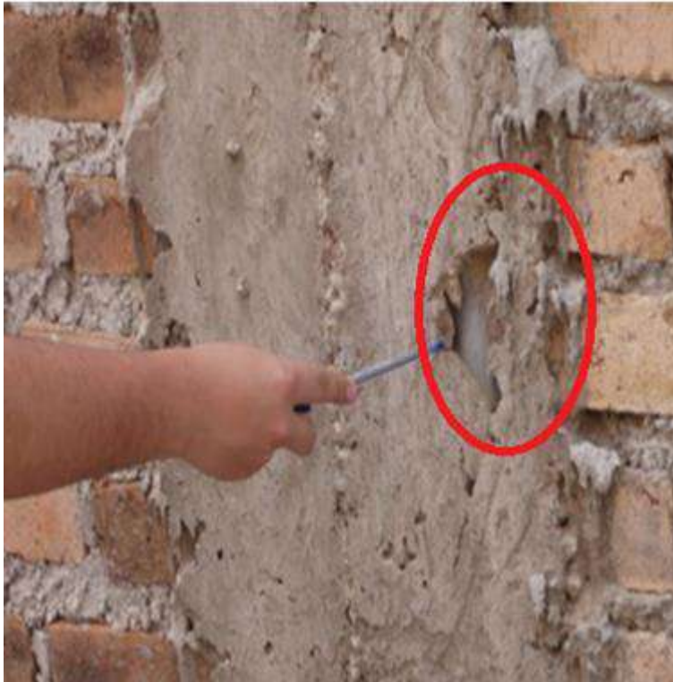
Figura 9: Presenta fractura en columna.
