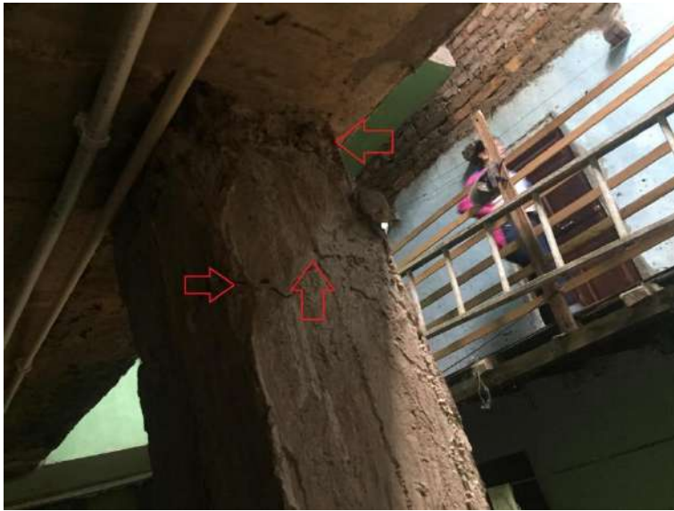
Figura 137: Cangrejas en columna y fisuras con desprendimiento.
