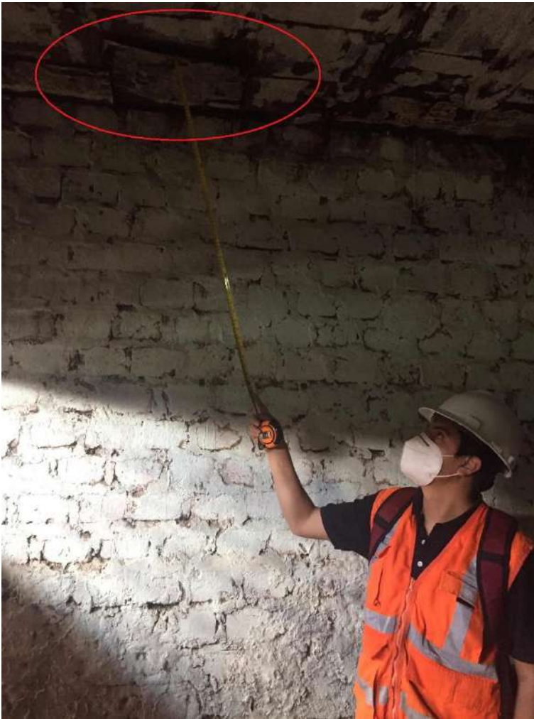
Figura 95: Residuos de encofrado.
