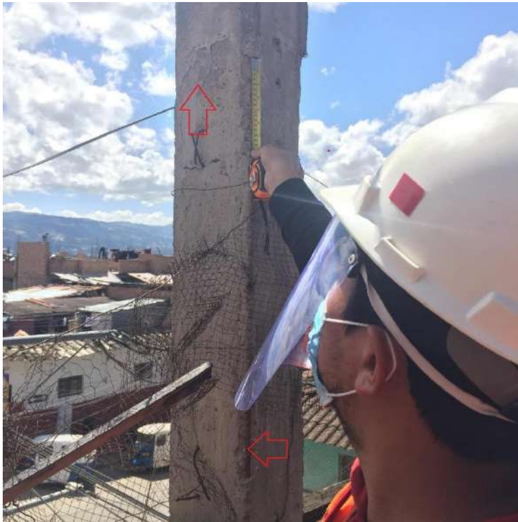
Figura 181: Presenta corrosión del acero, cangrejeras y concreto pobre.
