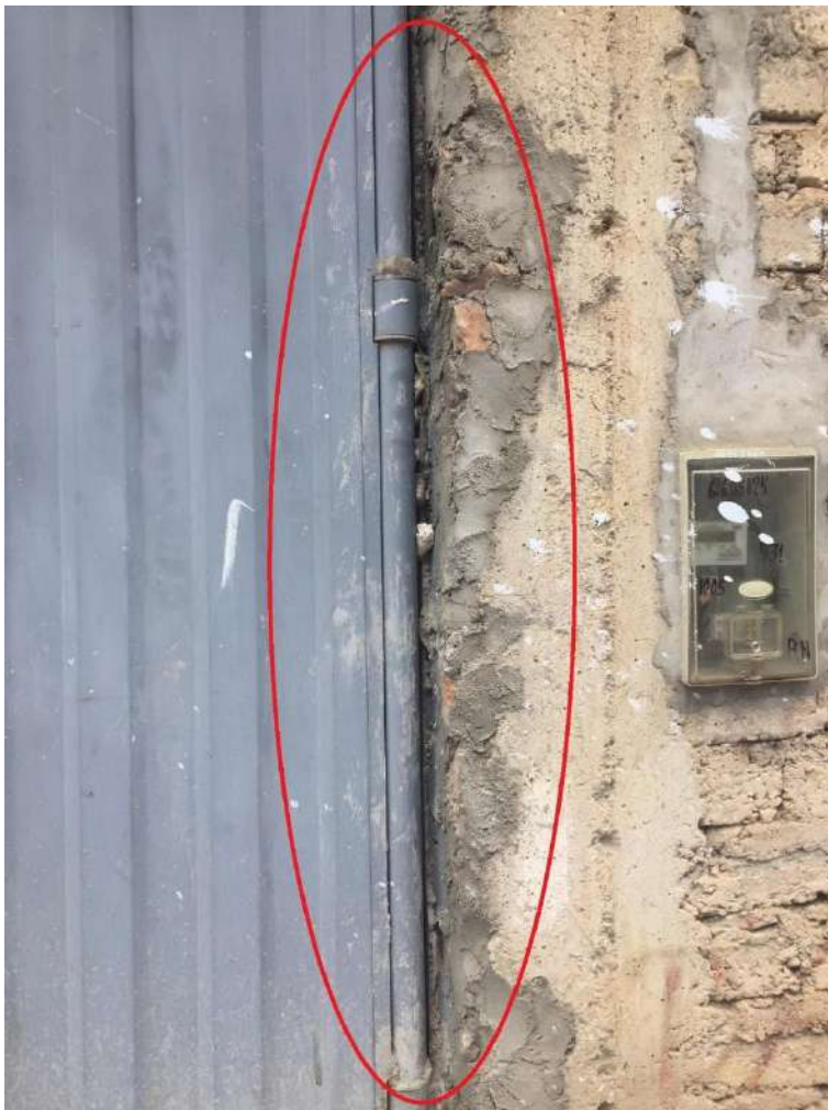
Figura 32: Presenta fractura de columna.
