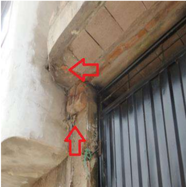
Figura 163: Resto de obra en losa aligerada y en columna.
