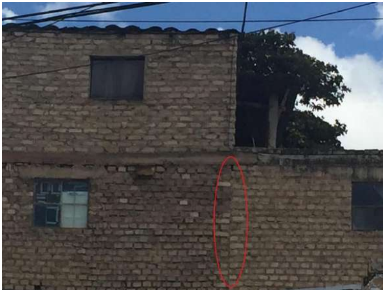
Figura 166: Muro de albañilería no presenta columna de amarre en la parte céntrica.
