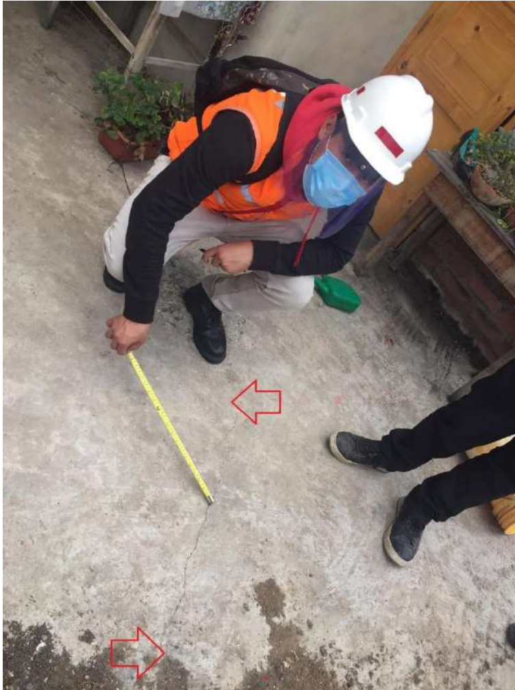
Figura 117: Fisuras e losa aligerada.
