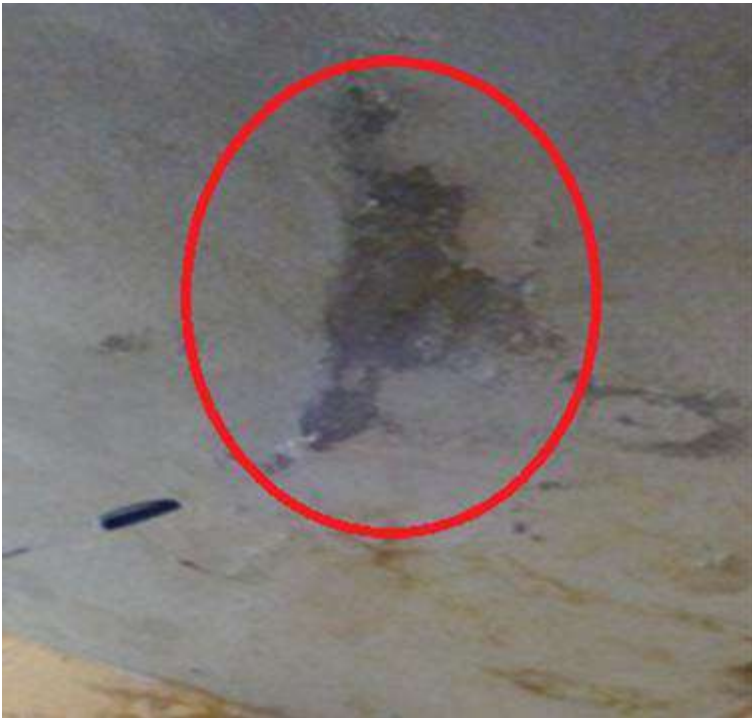
Figura 45: Presenta humedad en losa.
