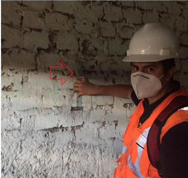
Figura 97: Espesor de mortero de asentado de ladrillo no reglamentaria.
