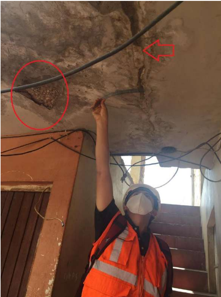
Figura 139: Desprendimiento de tarrageo de losa, gritas y humedad.
