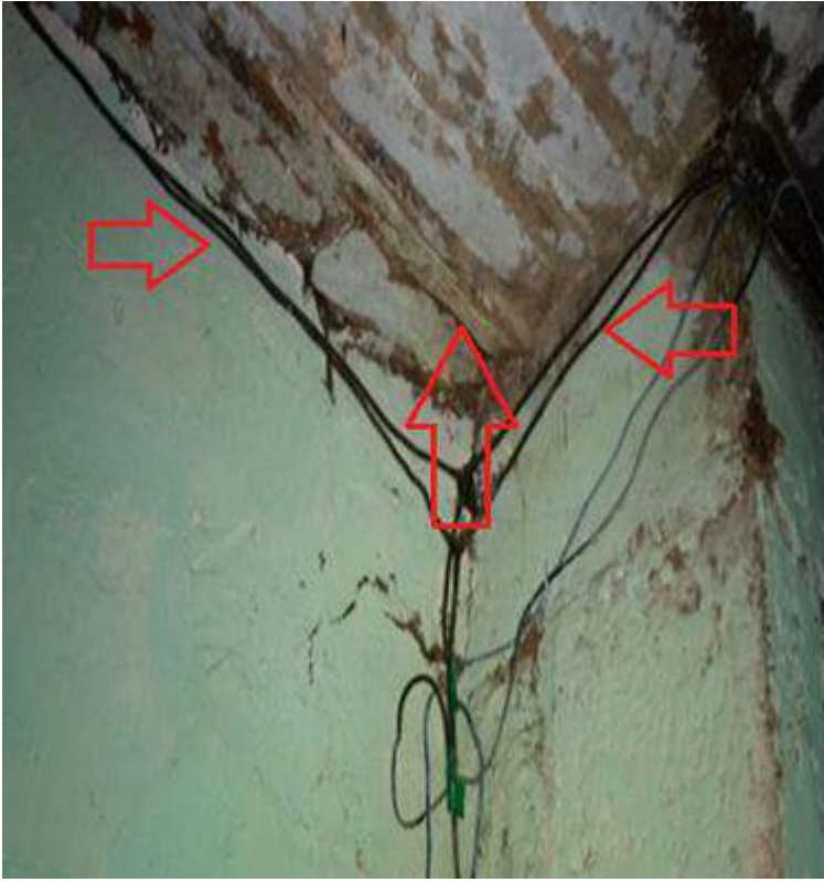
Figura 1: Grietas en muros cables de electricidad expuestos sin ningún aspecto técnico
