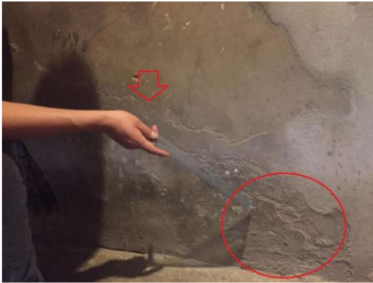
Figura 113: Fisuras verticales en muro y desprendimiento de tarrajeo.
