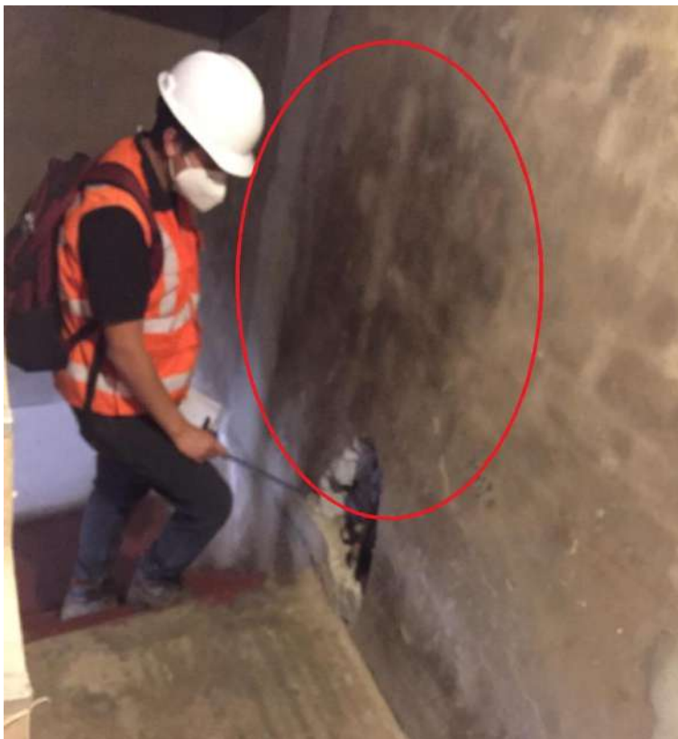
Figura 28: Presenta humedad en muro y llave de agua expuesta.
