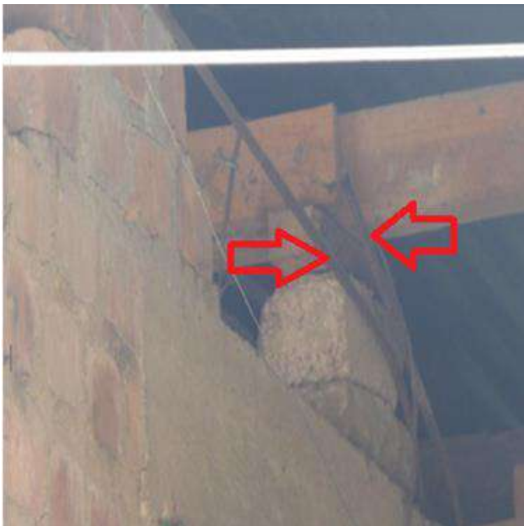
Figura 142: Amarre con aceros de proyección de columna sin ningún criterio de construcción.
