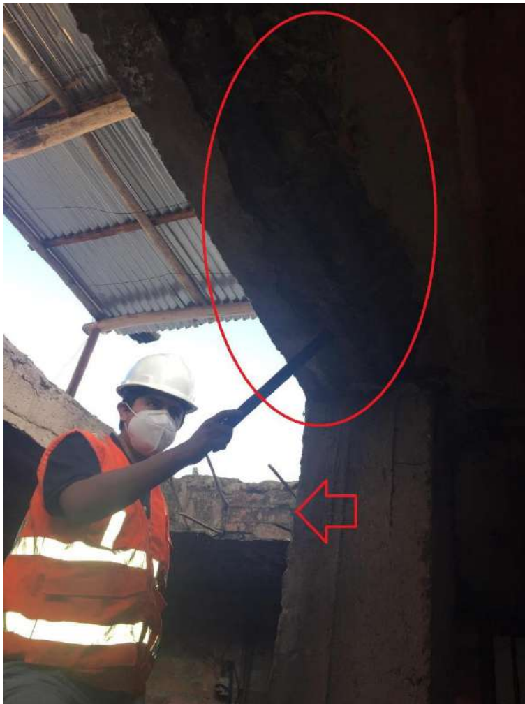
Figura 64: Presenta residuos de encofrado.
