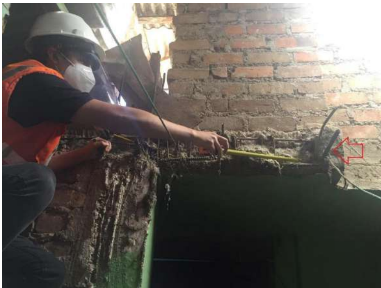
Figura 162: Proyección de acero de losa sin perfilar expuesto a la intemperie.
