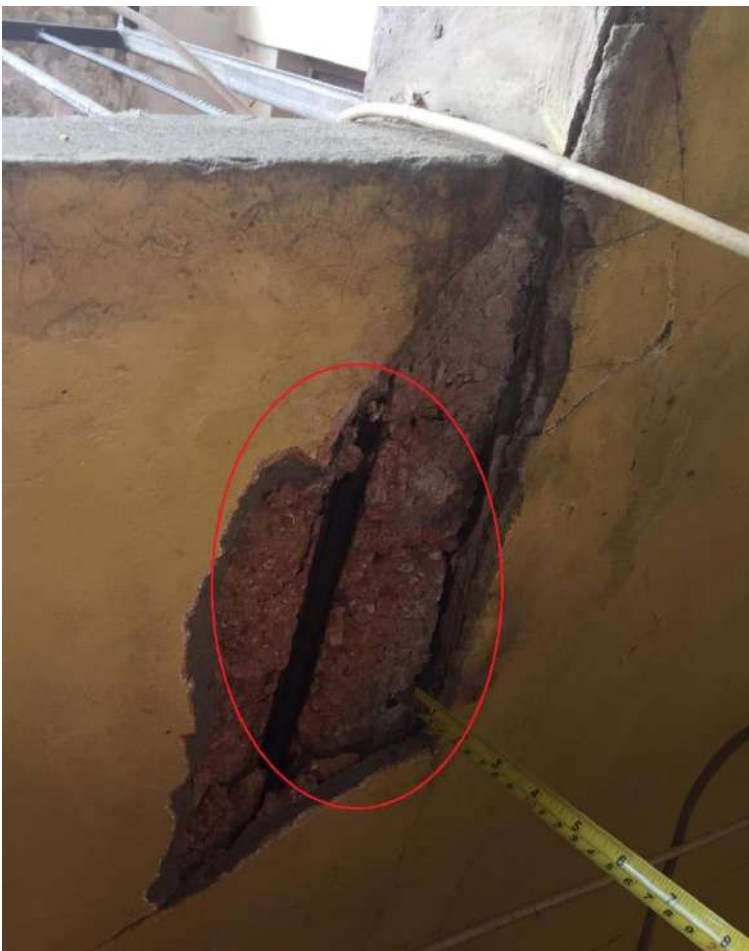
Figura 168: Corrosión de acero y desprendimiento de losa aligerada.
