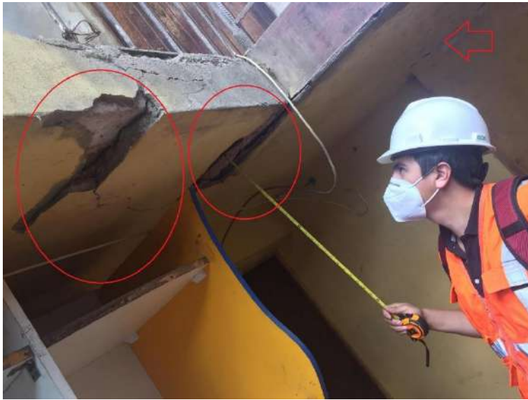
Figura 141: Desprendimiento de tarrajeo de losa y presenta grietas.
