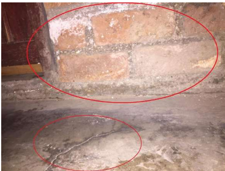
Figura 86: Presenta fisuras y eflorescencia.
