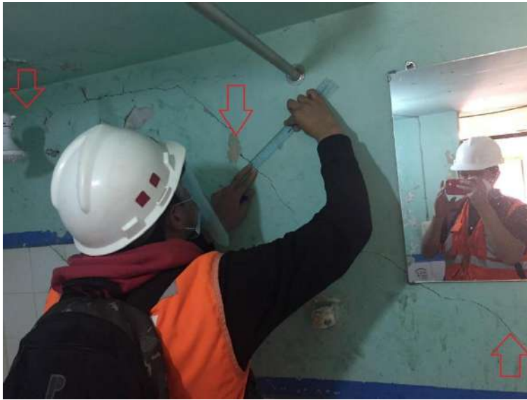
Figura 177: Grietas verticales en muros de albañilería.
