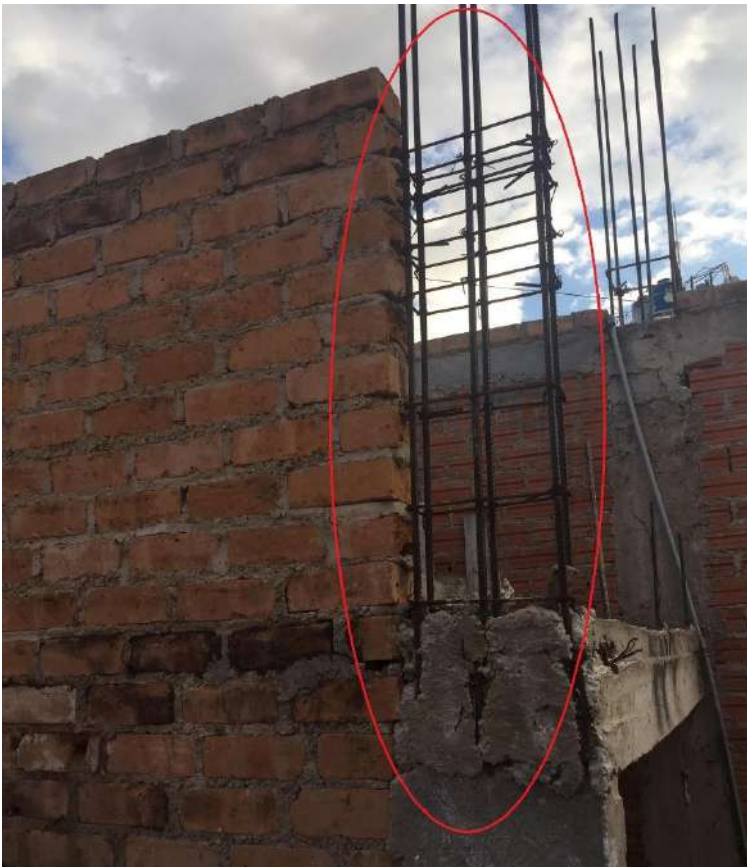
Figura 2: Acero expuesto a la intemperie y cangrejera.
