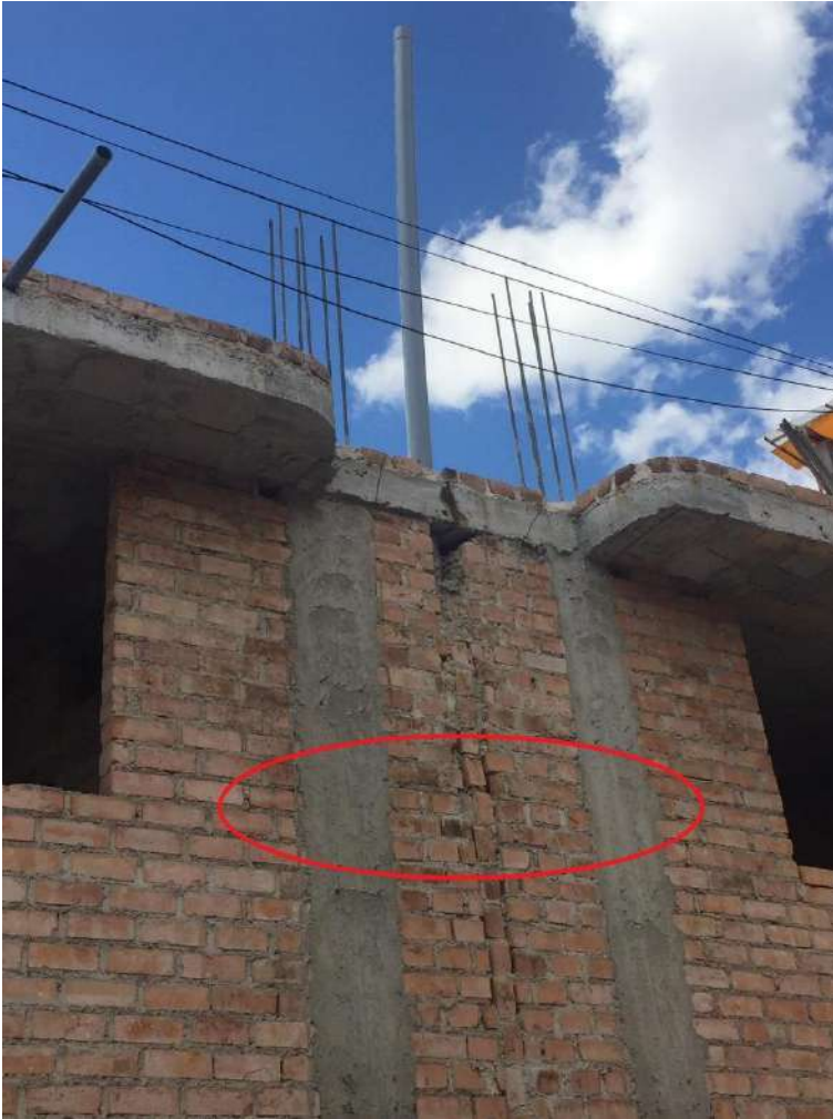
Figura 107: Distancia mínima entre columnas no reglamentaria.
