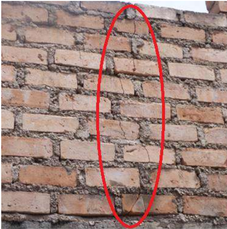
Figura 27: Presenta grieta vertical en muro.
