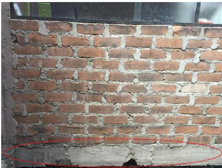
Figura 80: Fractura del recubrimiento de la viga.
