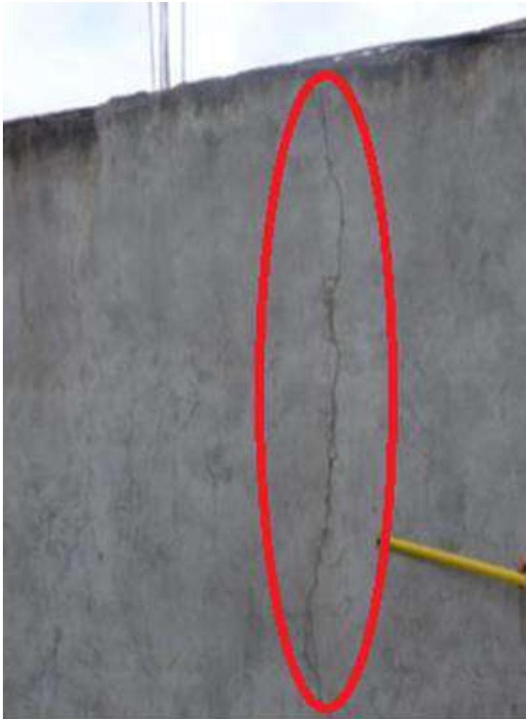
Figura 29: Presenta falla horizontal en muro.
