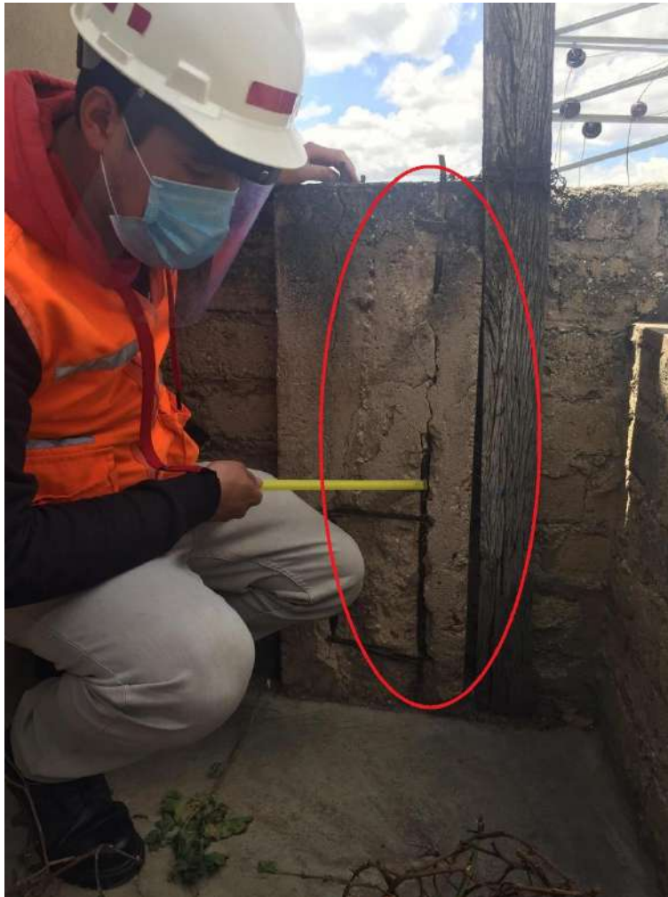
Figura 54: Presenta corrosión de acero y desprendimiento de concreto de la columna.
