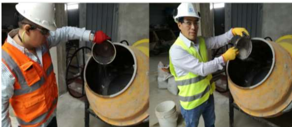
Figura 2. Preparación del concreto f_c = 210 Kg/cm 2 en estado fresco utilizando fibras de vidrio y acero.
