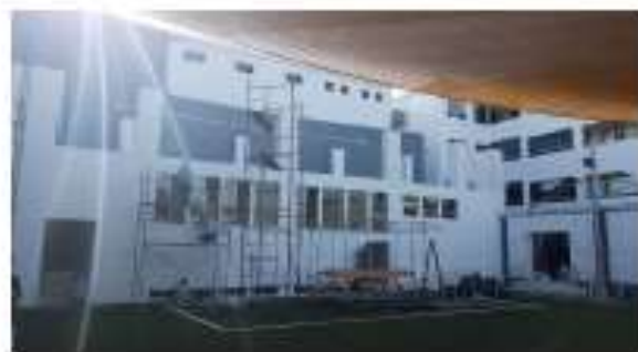
Se instala malla de seguridad en la parte superior y mano final de pintura en fachada.
