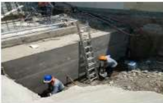
calzadura de cemento del ascensor.
