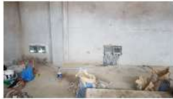
Cajas pase para instalaciones de data.
