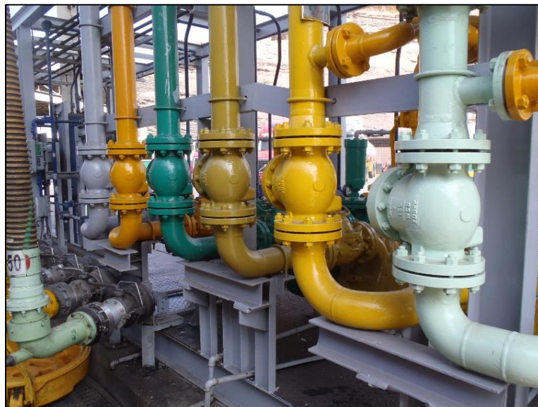
Figura 32. Tomas de brazos de carga de islas de despacho de combustibles Fuente: Phoenix EPC S.A.C.
