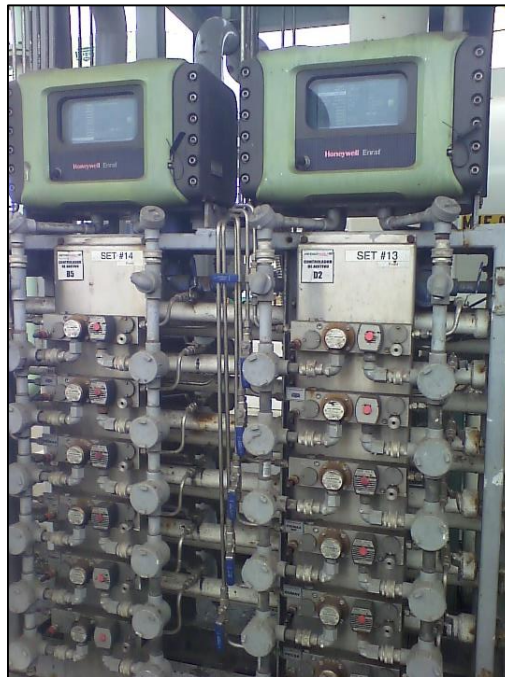
Figura 28. válvulas de inyección, pertenecientes al controlador de aditivo
