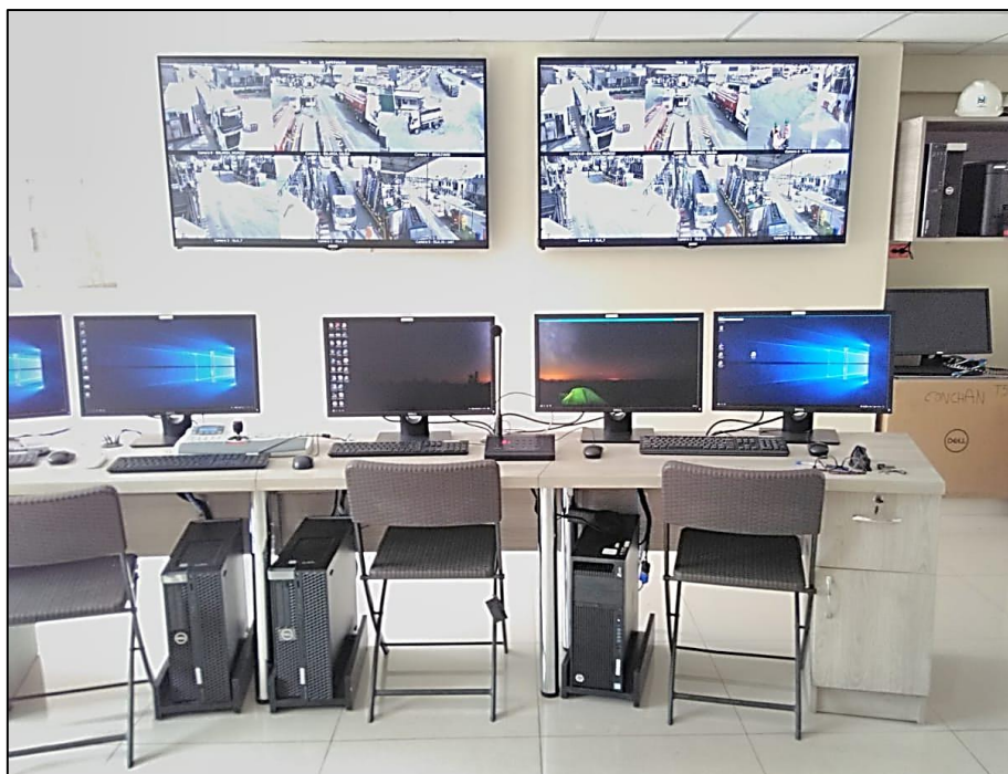
Figura 58. Supervisión de operación de despacho en islas desde sala de control
