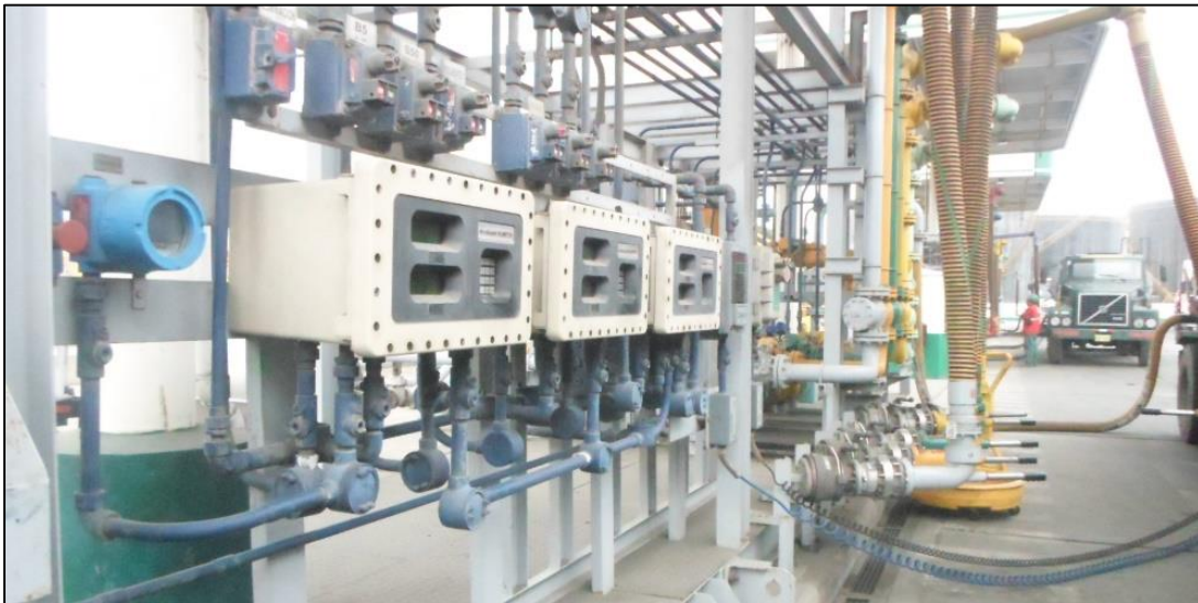
Figura 25. Isla de despacho de combustibles del terminal
