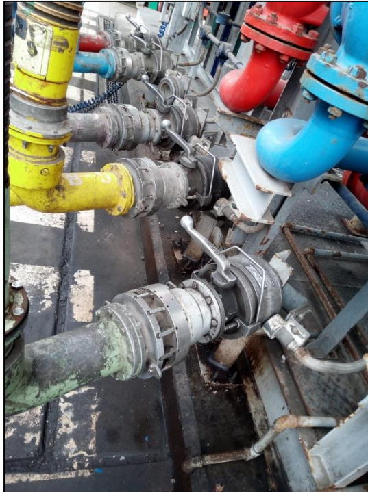
Figura 52. Montaje de sensores capacitivos en toma de brazos de carga Fuente: Phoenix EPC S.A.C.
