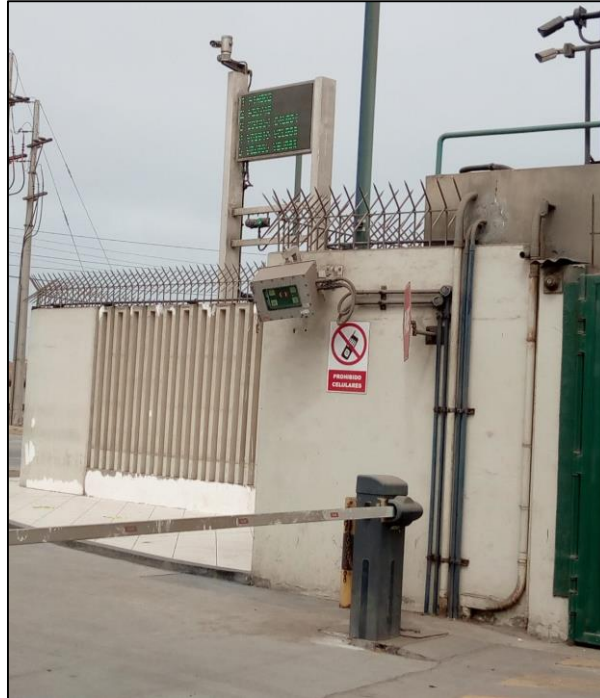
Figura 46. Equipos para el sistema de control de acceso y CCTV en entrada de terminal Fuente: Phoenix EPC S.A.C.
