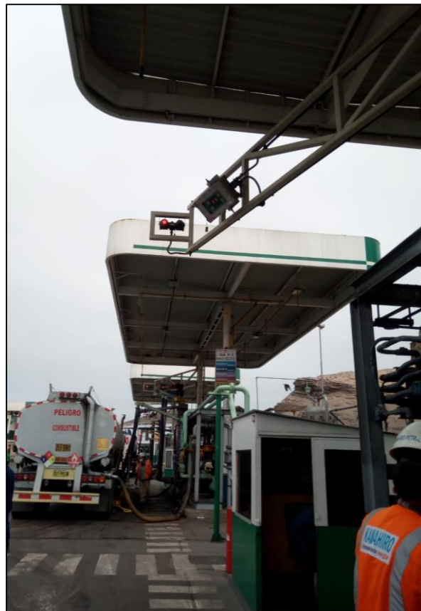
Figura 51. Montaje de lector RFID y semáforos en Isla de Despacho
