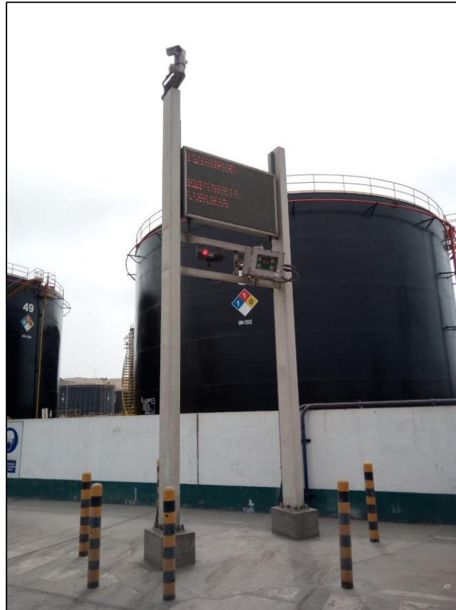
Figura 48. Equipos para el sistema de control de acceso y CCTV en balanza de ingreso
