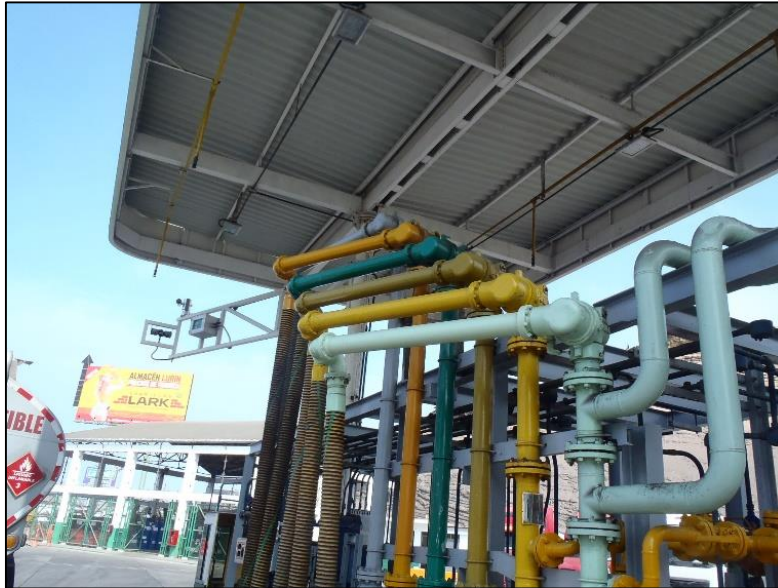
Figura 31. Brazos de carga de islas de despacho de combustibles Fuente: Phoenix EPC S.A.C.
