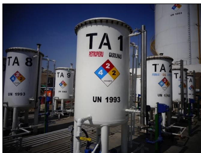
Figura 24. Zona de tanques de aditivos
