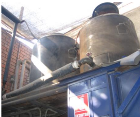
Figura 21: Sistema de enfriamiento de agua
