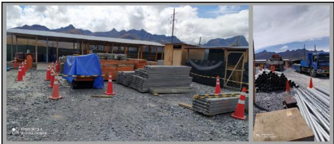
Figura 62. Evidencia de materiales almacenados en zonas incorrectas expuestos a la intemperie Fuente: Elaboración Propia
