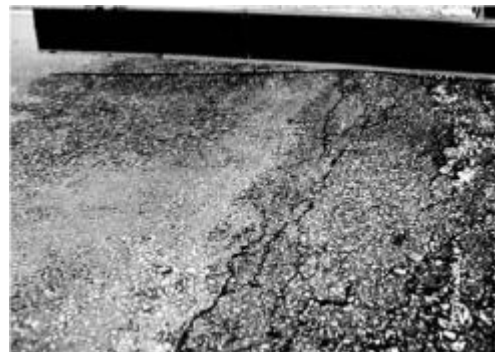
Figura 16: Abultamientos y hundimientos - severidad alta
