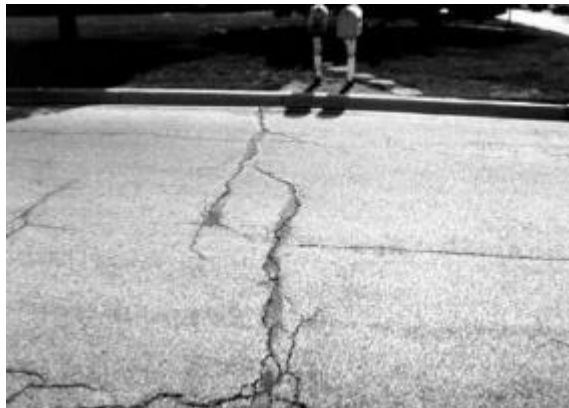
Figura 12: Agrietamiento en bloque - severidad media
