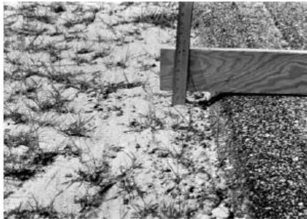
Figura 29: Desnivel carril/berma - severidad baja
