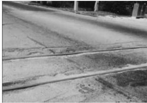
Figura 43: Cruce de vía férrea - severidad media
