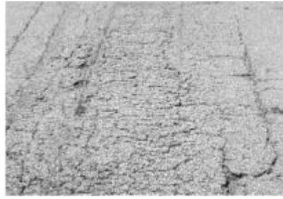
Figura 56: Meteorización y desprendimiento de agregados - severidad media
