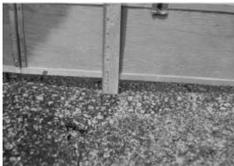
Figura 47: Ahuellamiento - severidad alta
