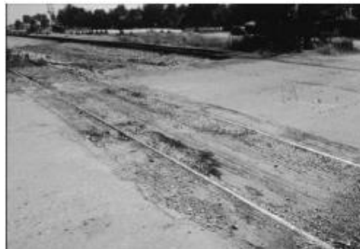
Figura 44: Cruce de vía férrea - severidad alta
