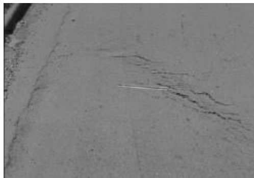
Figura 52: Grietas parabólicas - severidad media
