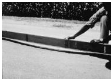
Figura 21: Depresión - severidad media
