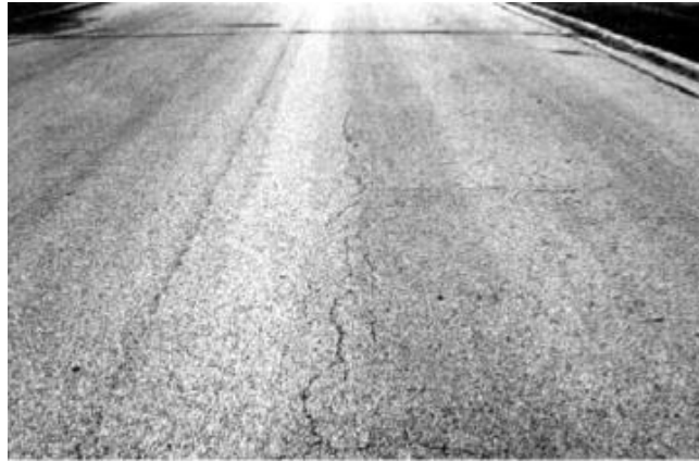
Figura 5: Piel de cocodrilo - severidad baja
