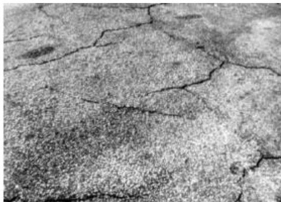
Figura 13: Agrietamiento en bloque - severidad alta
