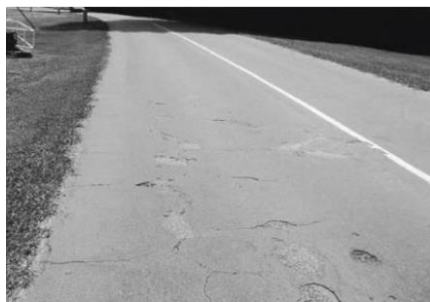
Figura 57: Meteorización y desprendimiento de agregados - severidad alta
