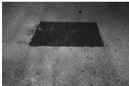
Figura 35: Parcheo y acometidas de servicios públicos - severidad baja
