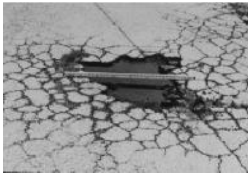
Figura 41: huecos - severidad alta
