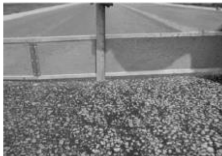
Figura 46: Ahuellamiento - severidad media
