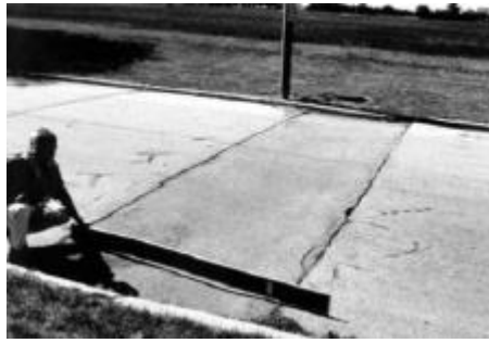
Figura 36: Parqueo y acometidas de servicios públicos - severidad media
