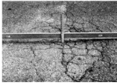
Figura 22: Depresión - severidad alta
