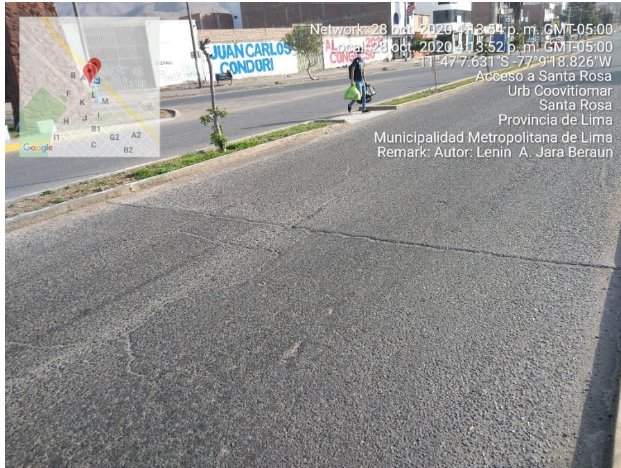
Identificación de Grietas Longitudinales y Transversales.
