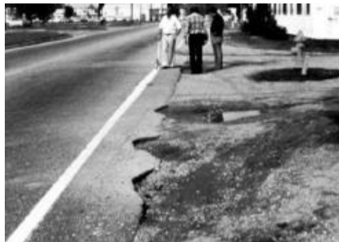
Figura 25: Grieta de borde - severidad alta
