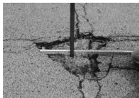
Figura 40: Huecos - severidad media
