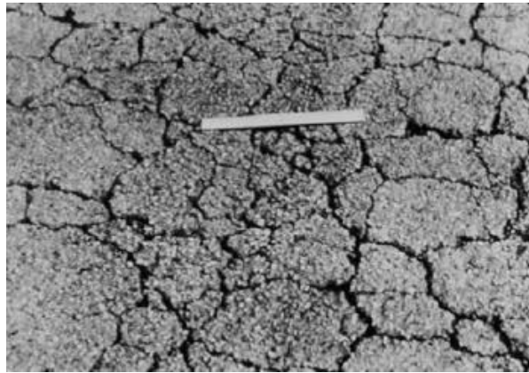
Figura 7: Piel de cocodrilo - severidad alta
