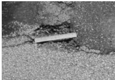
Figura 39: Huecos - severidad baja
