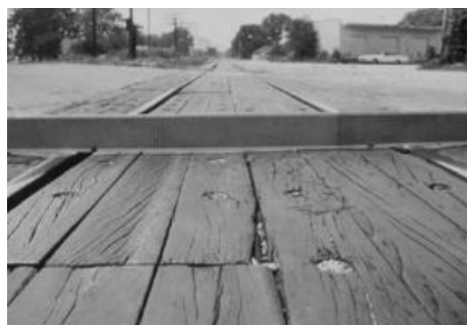
Figura 42: Cruce de vía férrea - severidad baja
