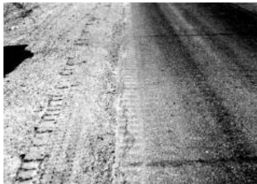
Figura 26: Grieta de reflexión de junta - severidad baja
