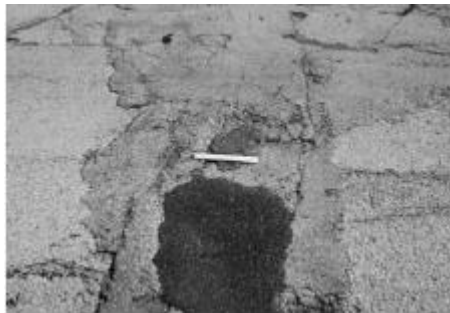
Figura 37: Parqueo y acometidas de servicios públicos - severidad alta
