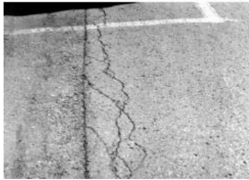
Figura 24: Grieta de borde - severidad media
