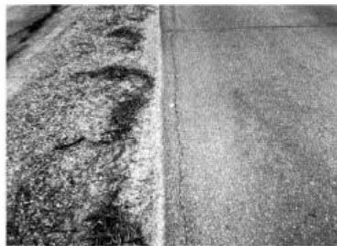
Figura 23: Grieta de borde - severidad baja
