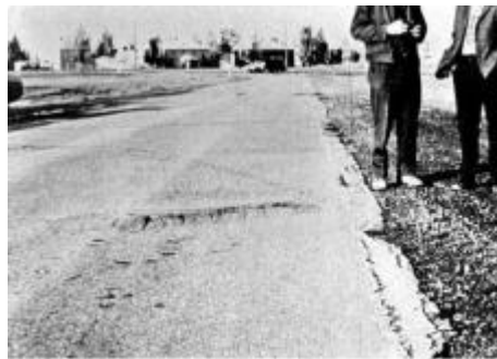
Figura 15: Abultamientos y hundimientos - severidad media
