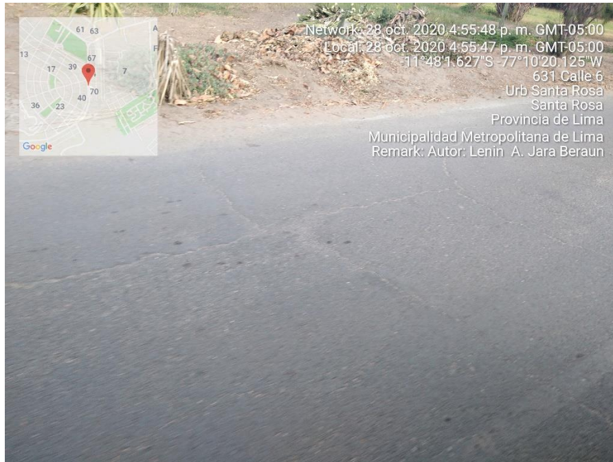
Identificación de Agrietamiento en Bloque.
