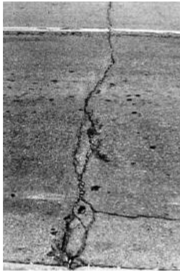
Figura 27: Grieta de reflexión de junta - severidad media
