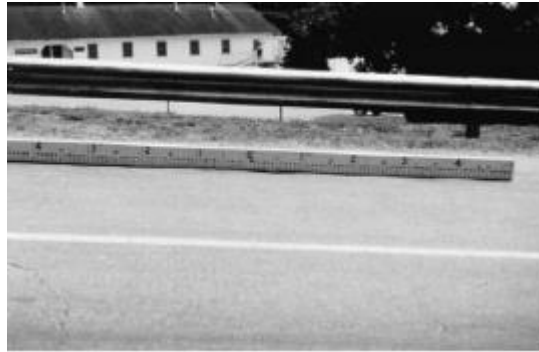
Figura 17: Corrugación - severidad baja
