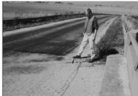
Figura 48: Desplazamiento - severidad baja
