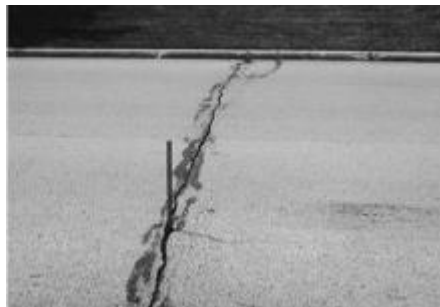
Figura 33: Grietas longitudinales y transversales - severidad media
