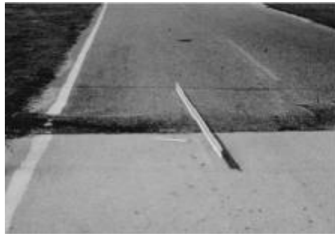
Figura 50: Desplazamiento - severidad alta
