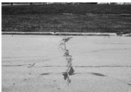
Figura 34: Grietas longitudinales y transversales - severidad alta
