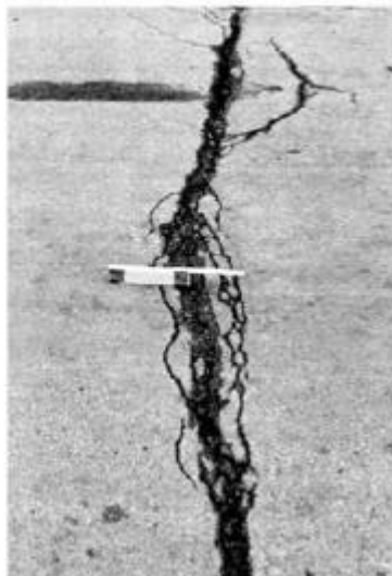
Figura 28: Grieta de reflexión de junta - severidad alta
