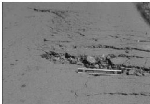
Figura 53: Grietas parabólicas - severidad alta
