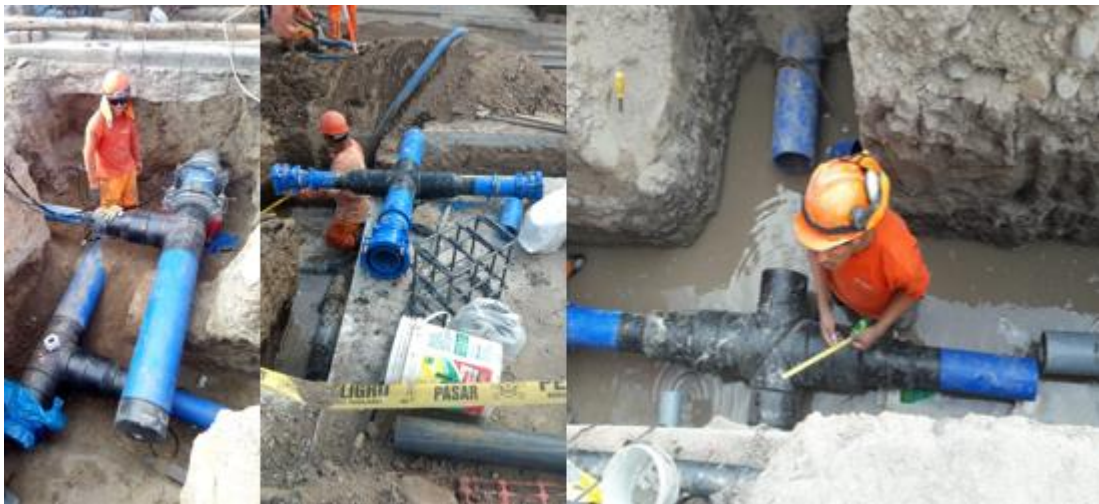
Figura N° 41. Empalmes para puesta en servicio
