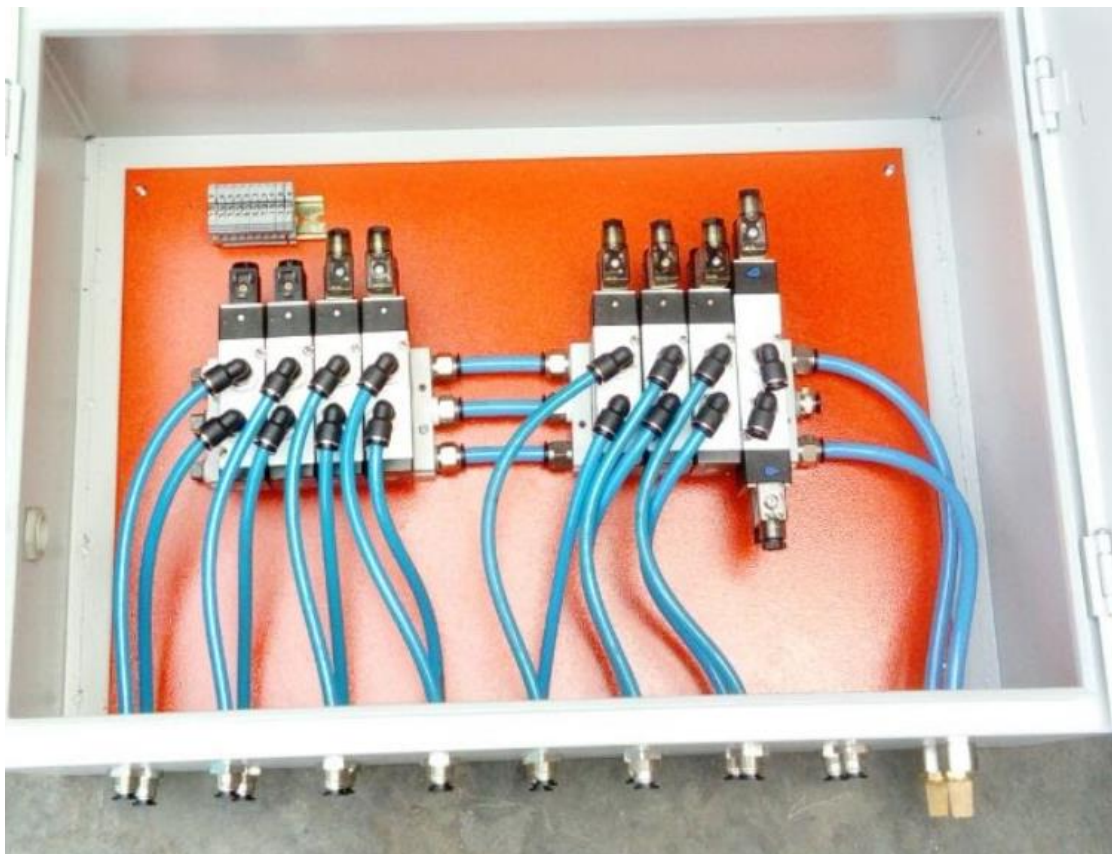
Figura 12. Tablero electro neumático. Fuente; Elaboración propia (2020).
