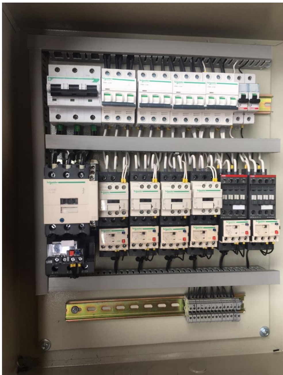
Figura 10. Tablero de fuerza . elaboración propia (2020)
