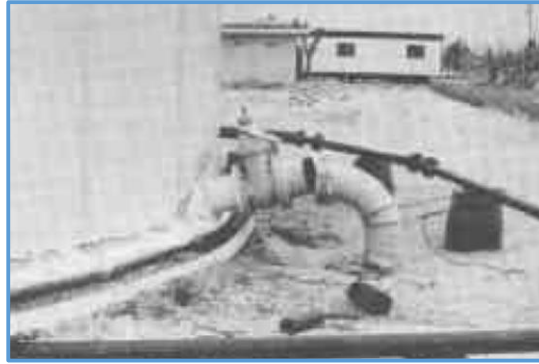
Figura 1. Falla de tubería que sale del tanque debido al Sismo de Londers, California del 1992 Fuente: Foto: M.J. O'Rourke
