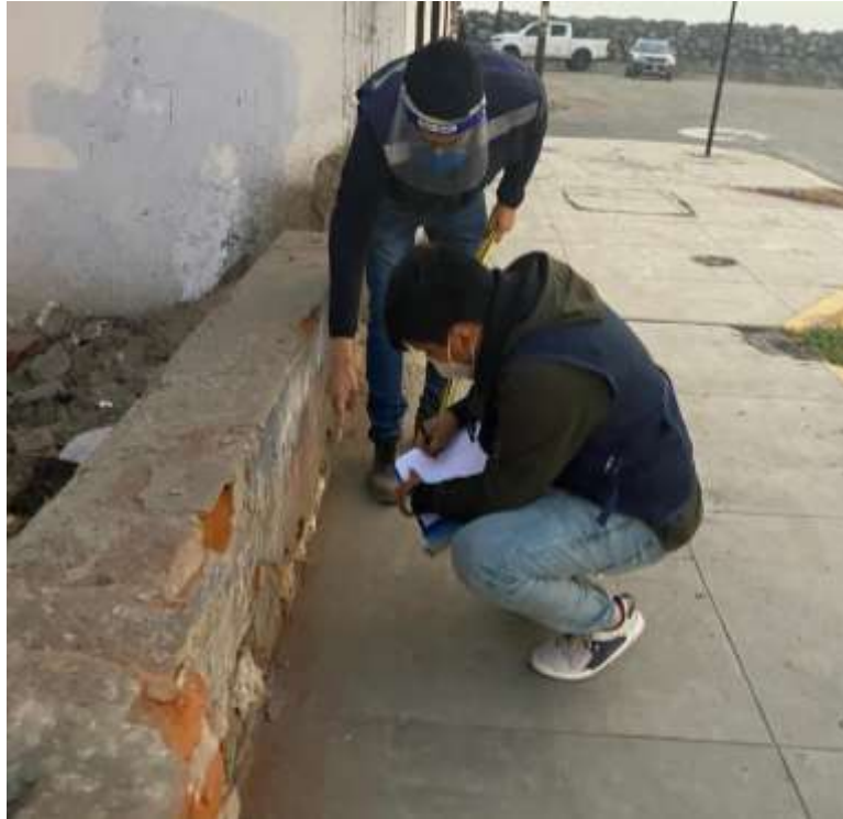
Foto N° 11: Análisis del grado de severidad de erosión en la edificación
