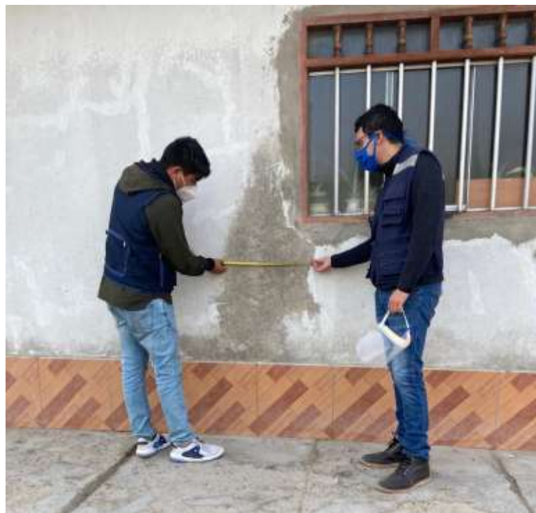
Foto N° 08: Medidas de área afectada por las patologías
