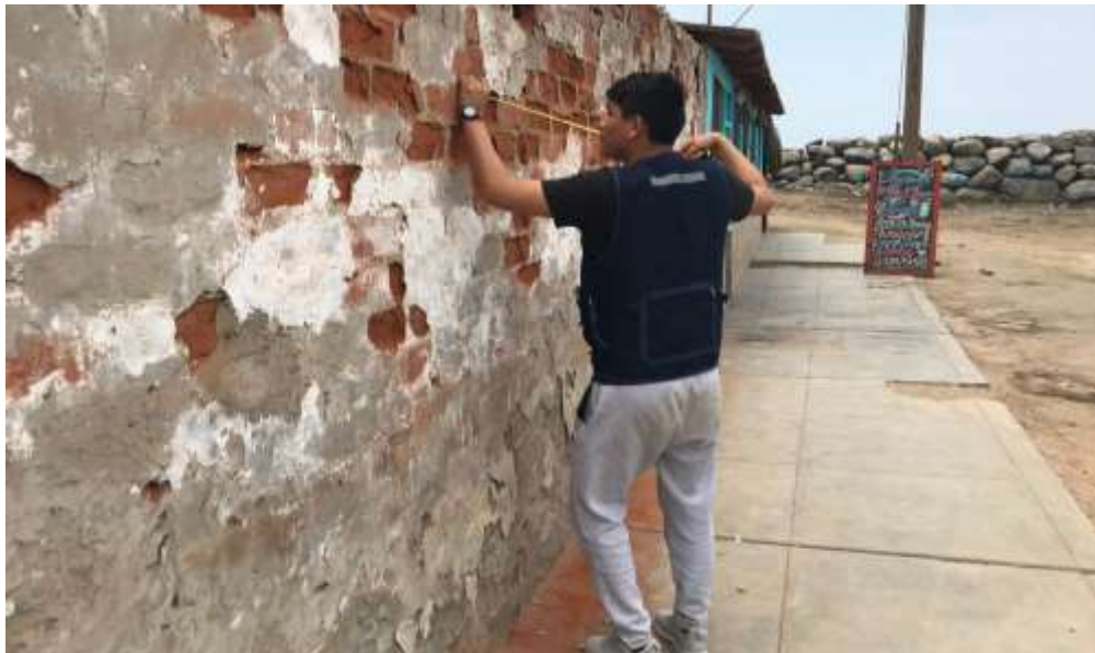
Foto N° 02: Medición de área de afectación de patologías
