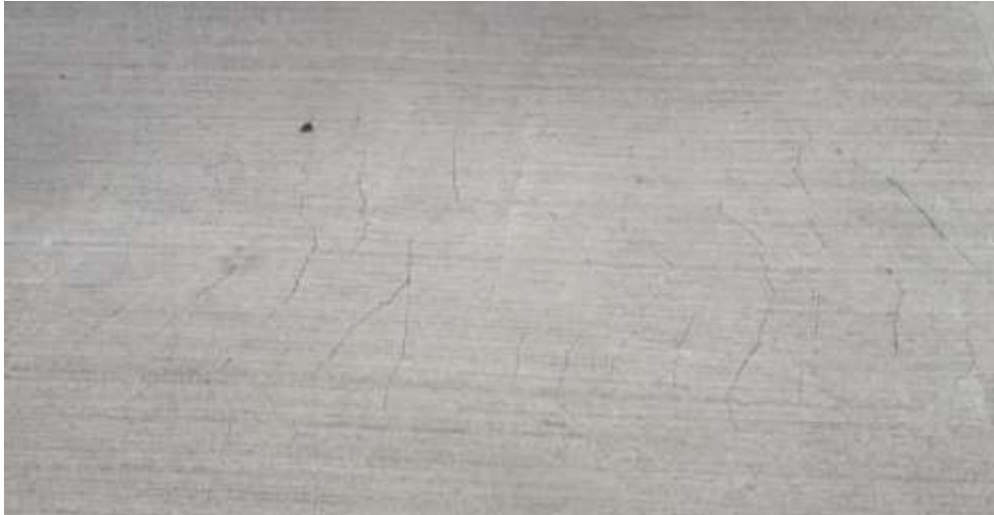
Figura N° 6: Patología contracción placa tránsito peatonal. Moreno, 2020.
