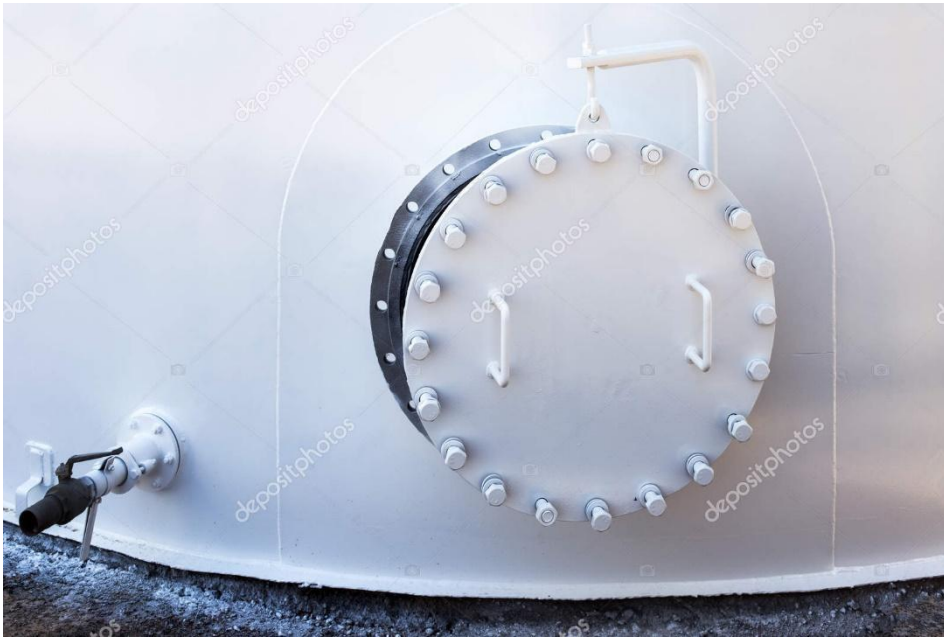
Figura n.o 14 Manhole de un tanque o entrada de hombre.
