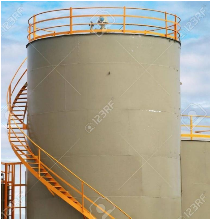
Figura n.o 13 Baranda helicoidal de un tanque y baranda superior.
